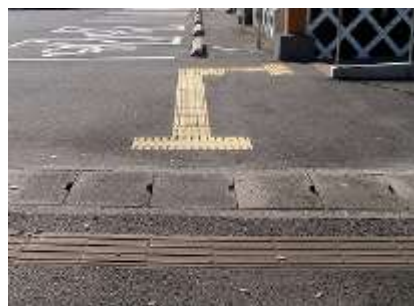
接続されていない状態
