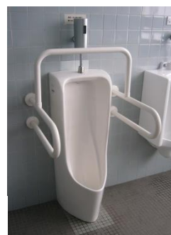
図 周囲に手すりの設けられた小便器
