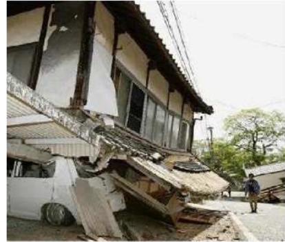
倒壊した住宅(熊本地震)
