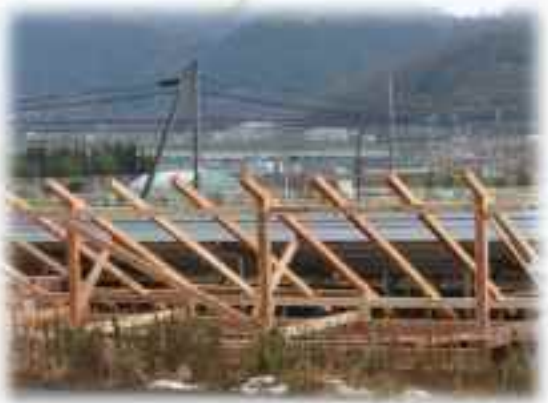
県産材を利用した太陽光パネルの架台
