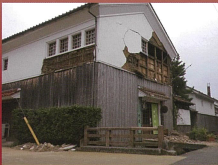
中部地震 土蔵白壁の崩落(倉吉市提供)
