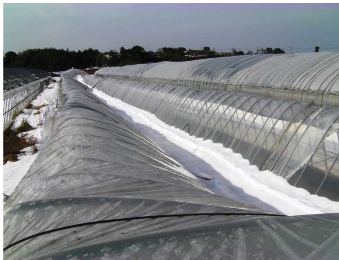
写真1 積雪による倒壊
