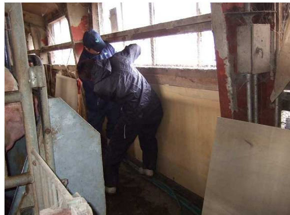
写真2 コンパネによる破損カーテンの補修
