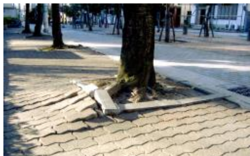
インターロッキング舗装における根上りの例
