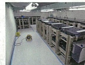
蓄電池(追加設置)
