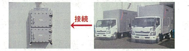
高圧発電機車接続盤
