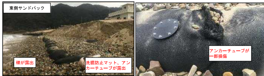
図 4-11 H29.12.16 における東側アンカーチューブの露出・損傷状況
