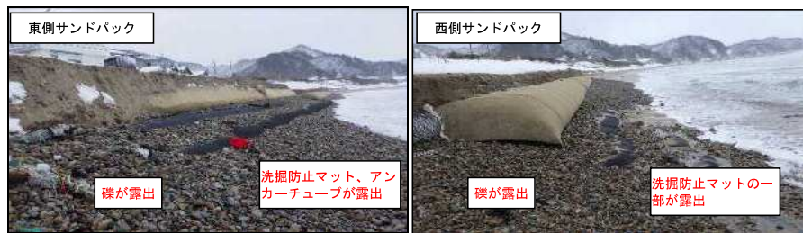
図 4-12 H30.1.25 におけるサンドバック前面の状況（左：東側、右：西側）
