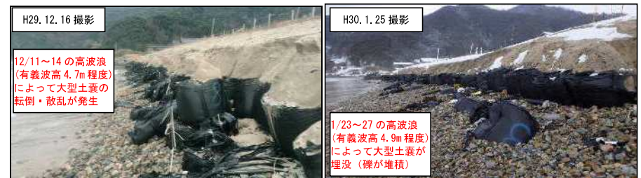
図 4-6 試験施工中の大型土嚢の被災状況 (左 : H29.12.16、右 : H30.1.25)
