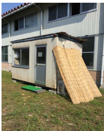
写真1 冷房コンテナハウス
