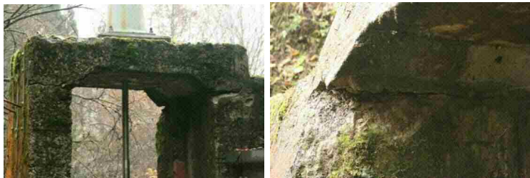
写真-1 竹田谷川取水設備 取水口制水ゲート門柱劣化状況
