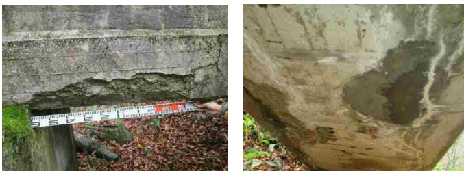
写真-4 菅ヶ谷川支流支線導水路 導水路水路橋下面劣化状況
