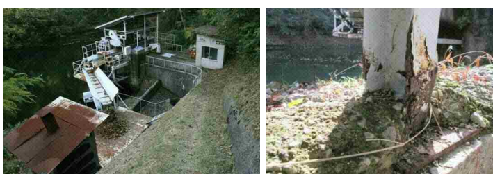
写真-9 三朝調整池 取水口塵芥置き場鋼材劣化状況
