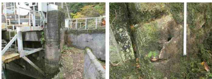
写真-7 三朝調整池 取水口水位計測塔劣化状況
