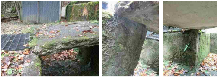
写真-3 菅ヶ谷川支線導水路 沈砂池ゲート操作用スラブ劣化状況
