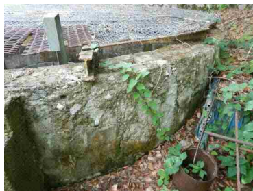
写真-6 調圧水槽 劣化状況
