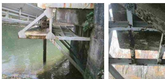
写真-8 三朝調整池 取水口除塵機支持鋼材劣化状況
