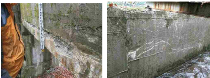
写真-5 菅ヶ谷川支線導水路 導水路立坑直上流水路橋劣化状況
