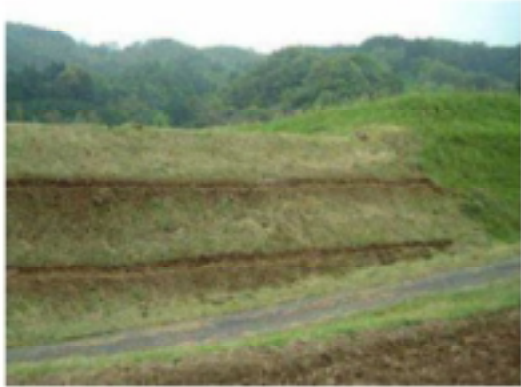
高低差の大きい農道沿いへの造成例 (東伯郡三朝町吉尾)
