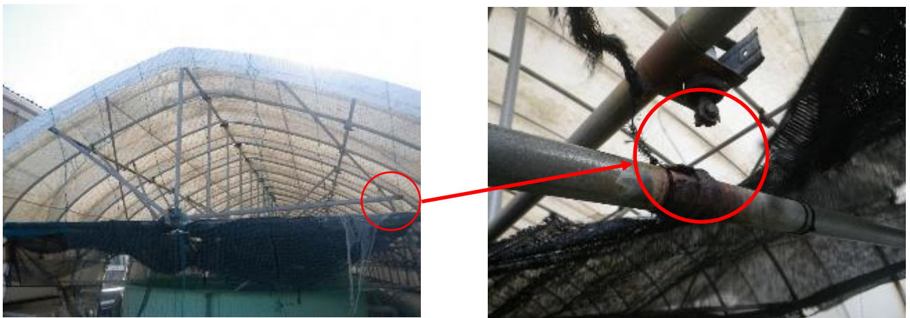
内部支柱部材劣化破損状況
