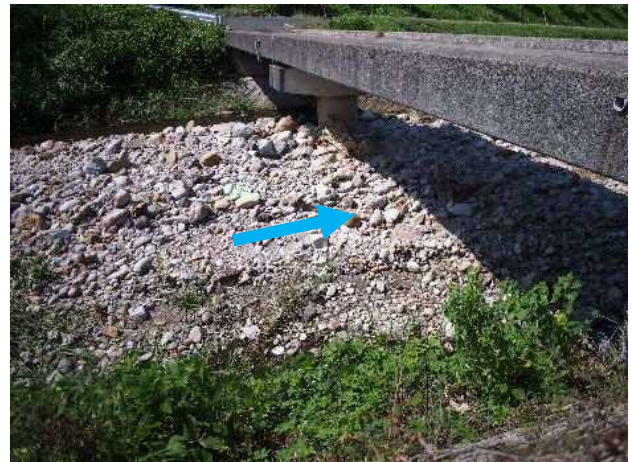
北谷川土砂堆積状況(右岸側から望む)
