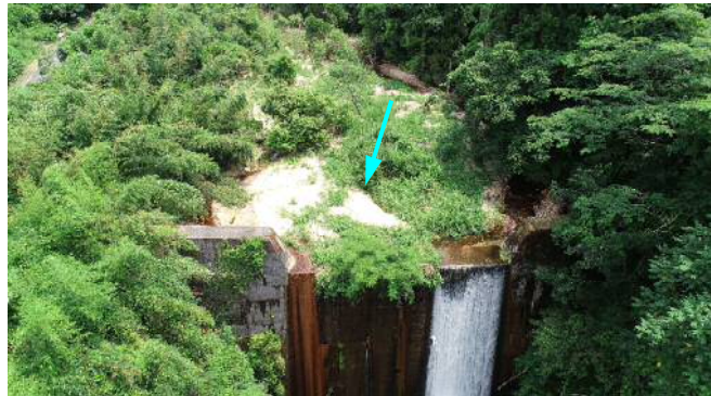
【岩倉川砂防堰堤の堆砂状況】
