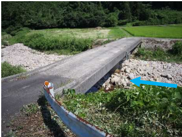
北谷川土砂堆積状況(左岸側から望む)
