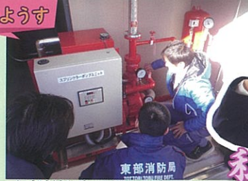
東部消防局 消防用設備の検査・指導をします。
