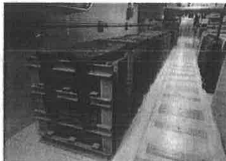
図5-18 蓄電池（バッテリー）
