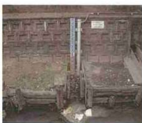
水位計設置状況
