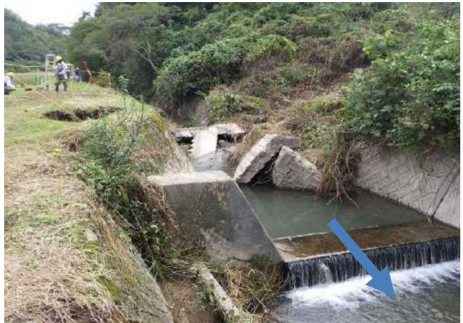
河川災害 三谷川(大山町羽田井)
