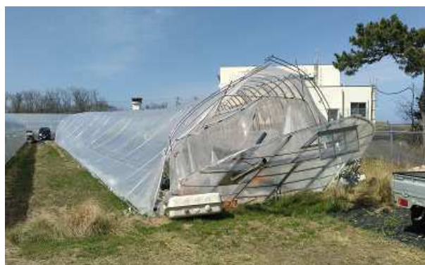
<強風により被害をうけたイチゴハウス:鳥取市賀露>
