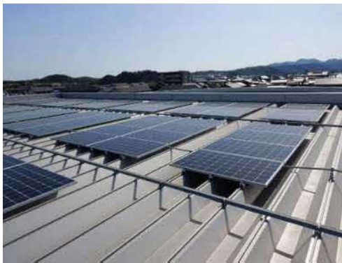
▲会社屋上の太陽光パネル
