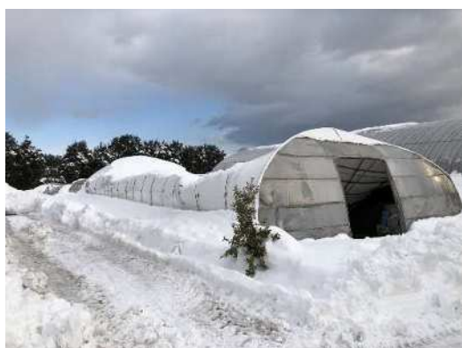
<パイプハウス倒壊被害(倉吉市関金町)>
