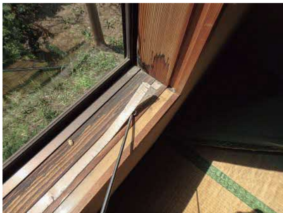
写真 2-2 窓枠（窓敷居）の劣化
