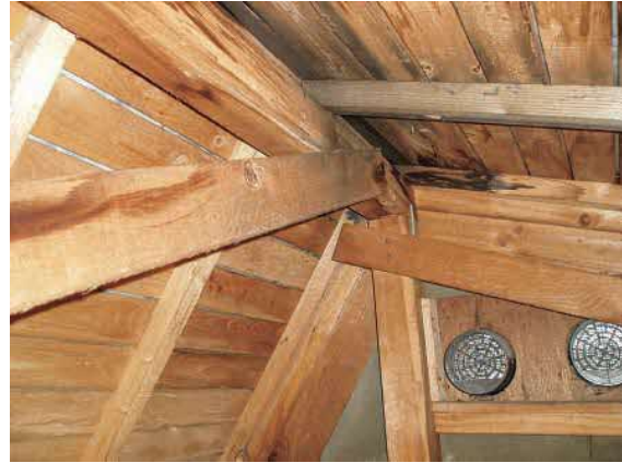
写真 2-7 小屋裏換気口の有無及び劣化事象等の確認(写真右下が小屋裏換気口)
