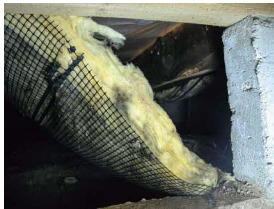
写真 2-5 床下断熱材の有無の確認と、断熱材の劣化事象等の確認(床断熱材の脱落)
