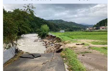
◆(三朝町助谷)水田への土砂流入
