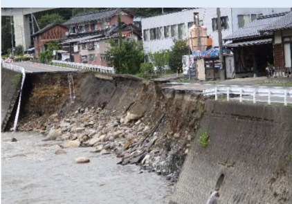
◆(鳥取市用瀬町別府)道路被害
