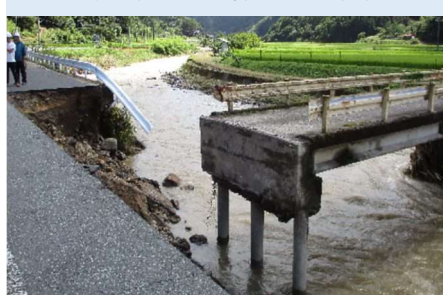
◆(八頭町福地・私都川)道路被害
