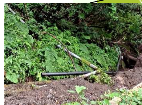
水道管の破損 (鳥取市佐治町余戸(よど))
