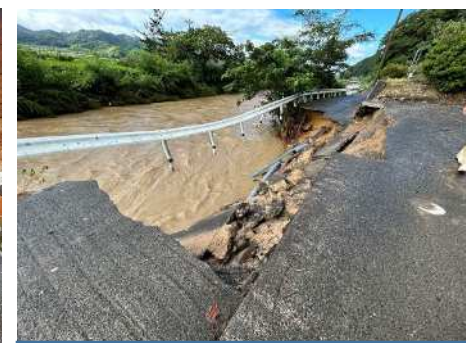
水道管・汚水管の破損 (八頭町上峰寺(かみみねでら))
