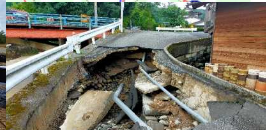
⑦水道管の破損 (鳥取市河原町中井)
