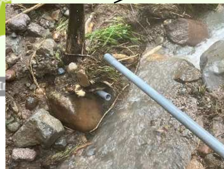
水道管の破損 (鳥取市佐治町河本(かわもと))
