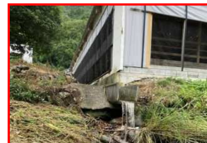
牛舎敷地内への河川流入による側溝基礎崩壊 (鳥取市河原町(とっとりしかわはらちょう))
