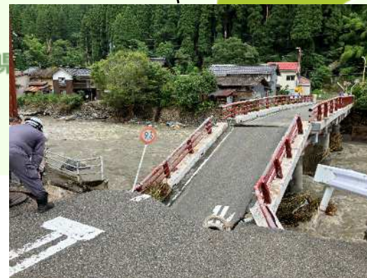
水道管・汚水管の破損 (鳥取市佐治町高山・加瀬木(たかやま・かせぎ))
