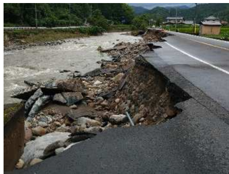
水道管の破損 (鳥取市佐治町福園(ふくぞの))
