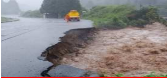
②護岸崩落 (三朝町穴鷹(国道179号))
