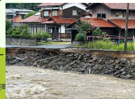
汚水管の破損 (八頭町福地(ふくち))
