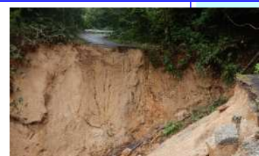
林道の崩壊 (三朝町福吉(みささちょうふくよし))
