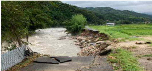
①農道の崩落 (三朝町助谷)
