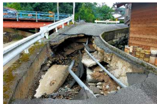
水道管の破損 (鳥取市河原町中井(なかい))
