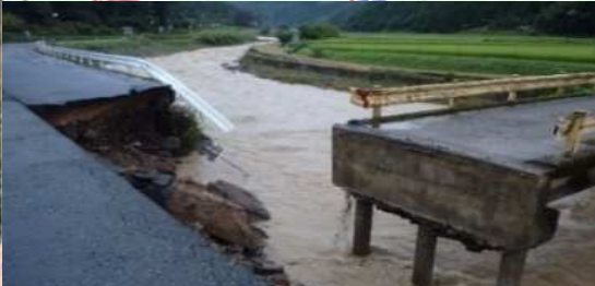
⑤道路崩落 (八頭町福地(県道麻生国府線))
