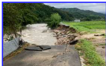
農道の崩落 (三朝町助谷(みささちょうすけだに))
