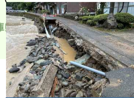
水道管・汚水管の破損 (八頭町落岩(おちいわ))
