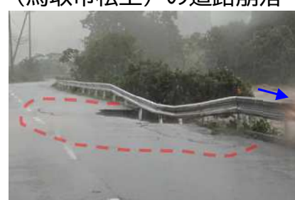
県道鳥取河原用瀬線（鳥取市松上）の道路崩落
