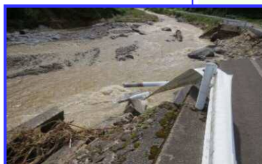
取水箇所の崩落
