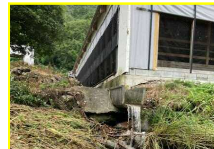
牛舎敷地内への河川流入による側溝基礎崩壊
