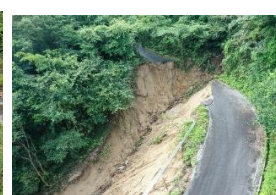
崩壊した林道 (三朝町福吉)
