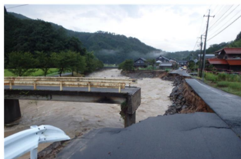
県道麻生国府線（八頭町福地） 道路崩落
