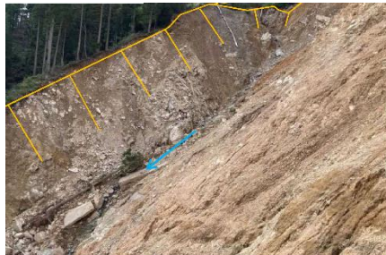
土砂流出発生源（北村地区）
