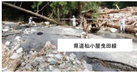
県道被災状況（北村地区）
