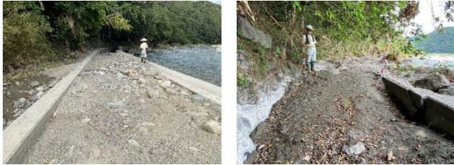
土砂埋没による通水機能の喪失 (R5.9.5撮影)
