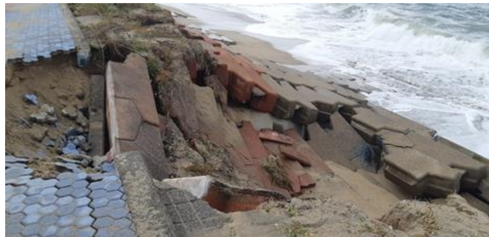
R3.10.21遊歩道の崩壊(W=1m、L=3m程度)
