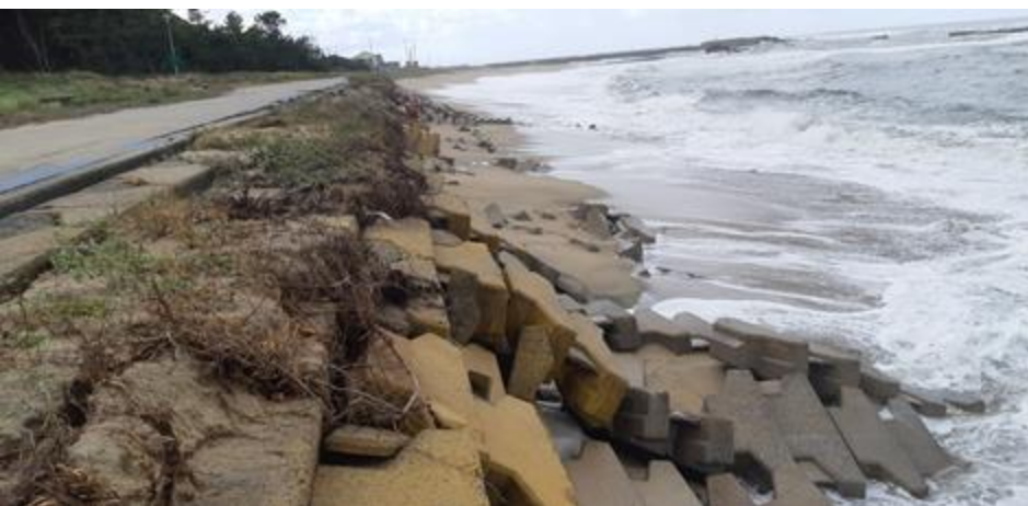
R3.10.21護岸崩壊状況
