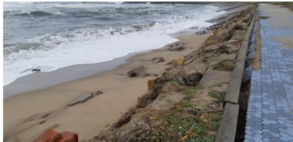
R3.10.21遊歩道崩壊状況
