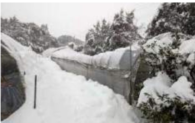
<パイプハウス倒壊被害（大山町羽田井）>
