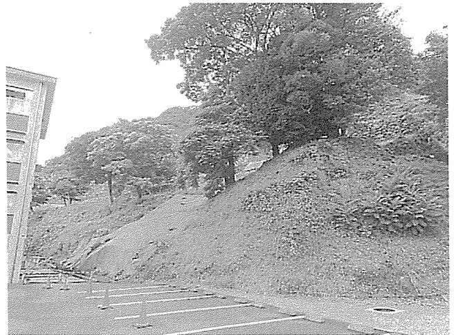
崩落箇所(校舎南側から撮影)
