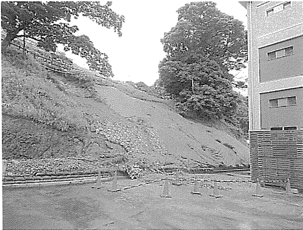
崩落箇所(校舎北側から撮影)
