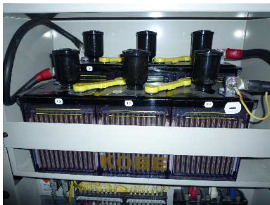
蓄電池 下段 2台
