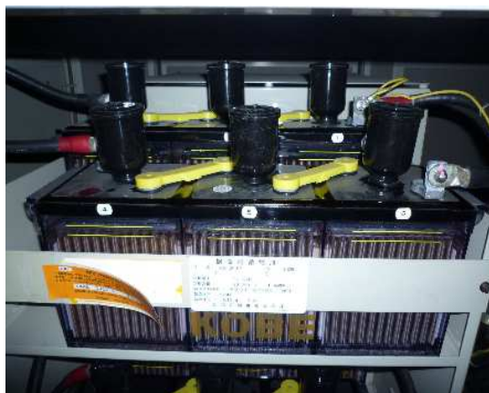
新神戸電機(株)(2015年3月設置)
