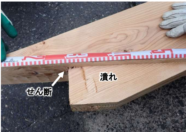
写真6 登梁尻仕口の潰れ等(箇所:図2(b))
