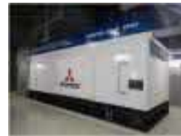
ガスタービン発電機
