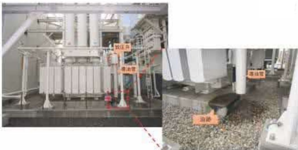
2号機 励磁電源変圧器の油漏れ
