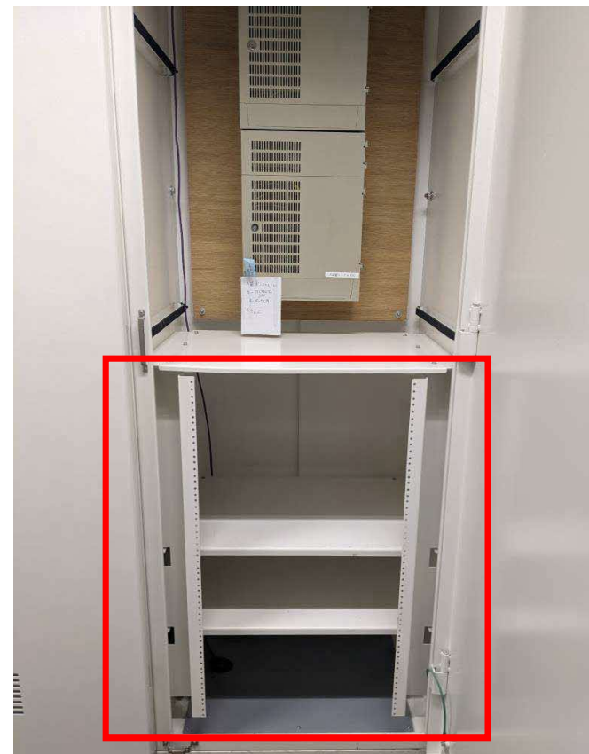
入退室管理システム盤
