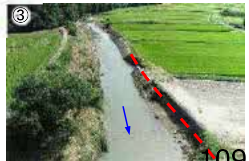
▲護岸崩壊の状況
