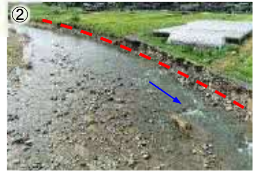
▲護岸崩壊の状況
