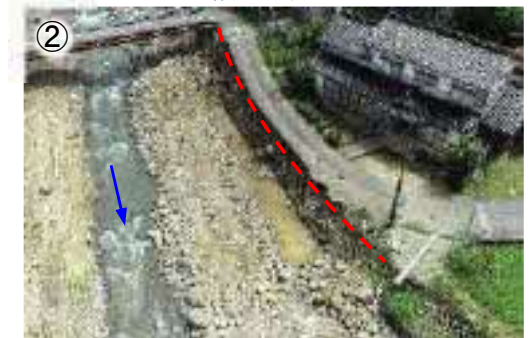
▲護岸崩壊の状況
