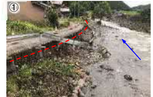
▲護岸崩壊の状況
