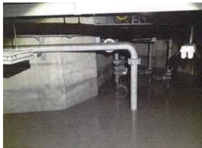
<地下5階の浸水：R5.8.17 16時>
