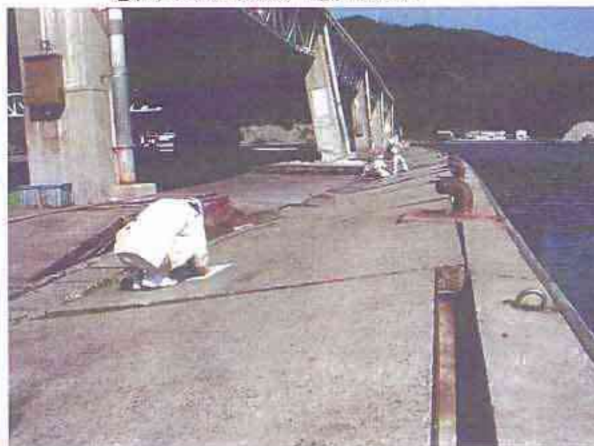
漁港突堤法線のはらみ出し
