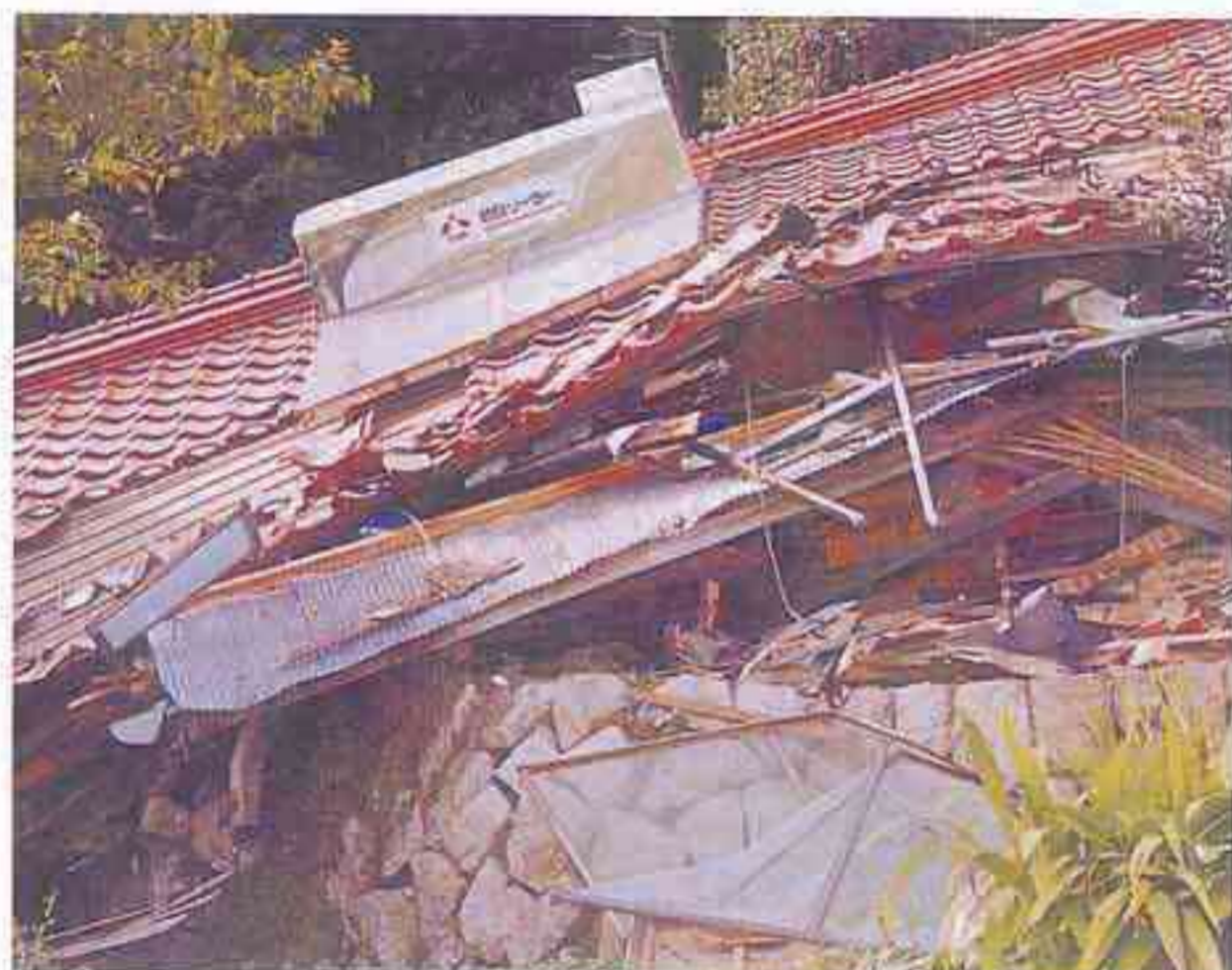
強い地震により全壊した家屋
