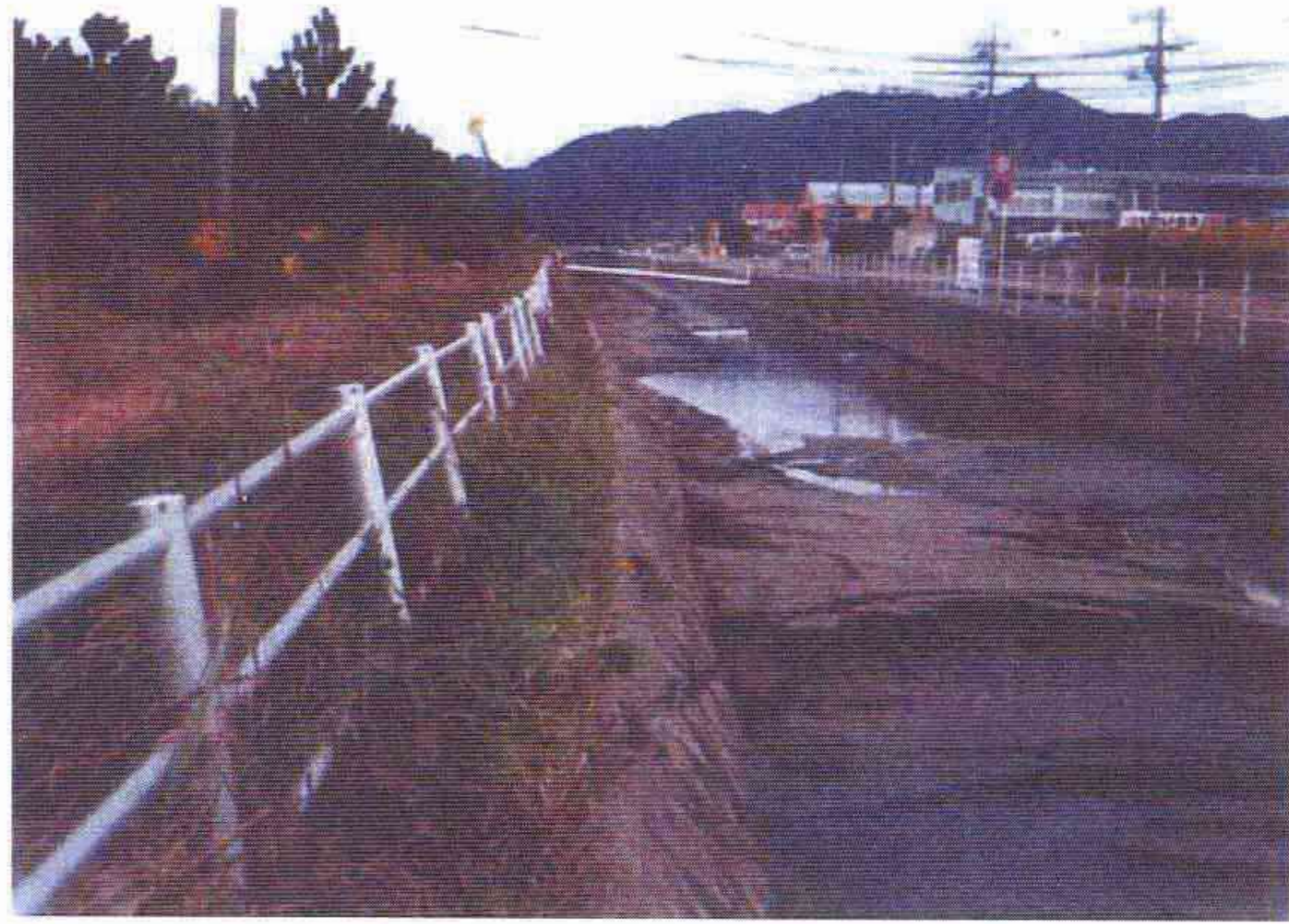
水路の兩岸の護岸とも川側に押されている。川底は隆起し、その上に噴砂の砂が堆積している
