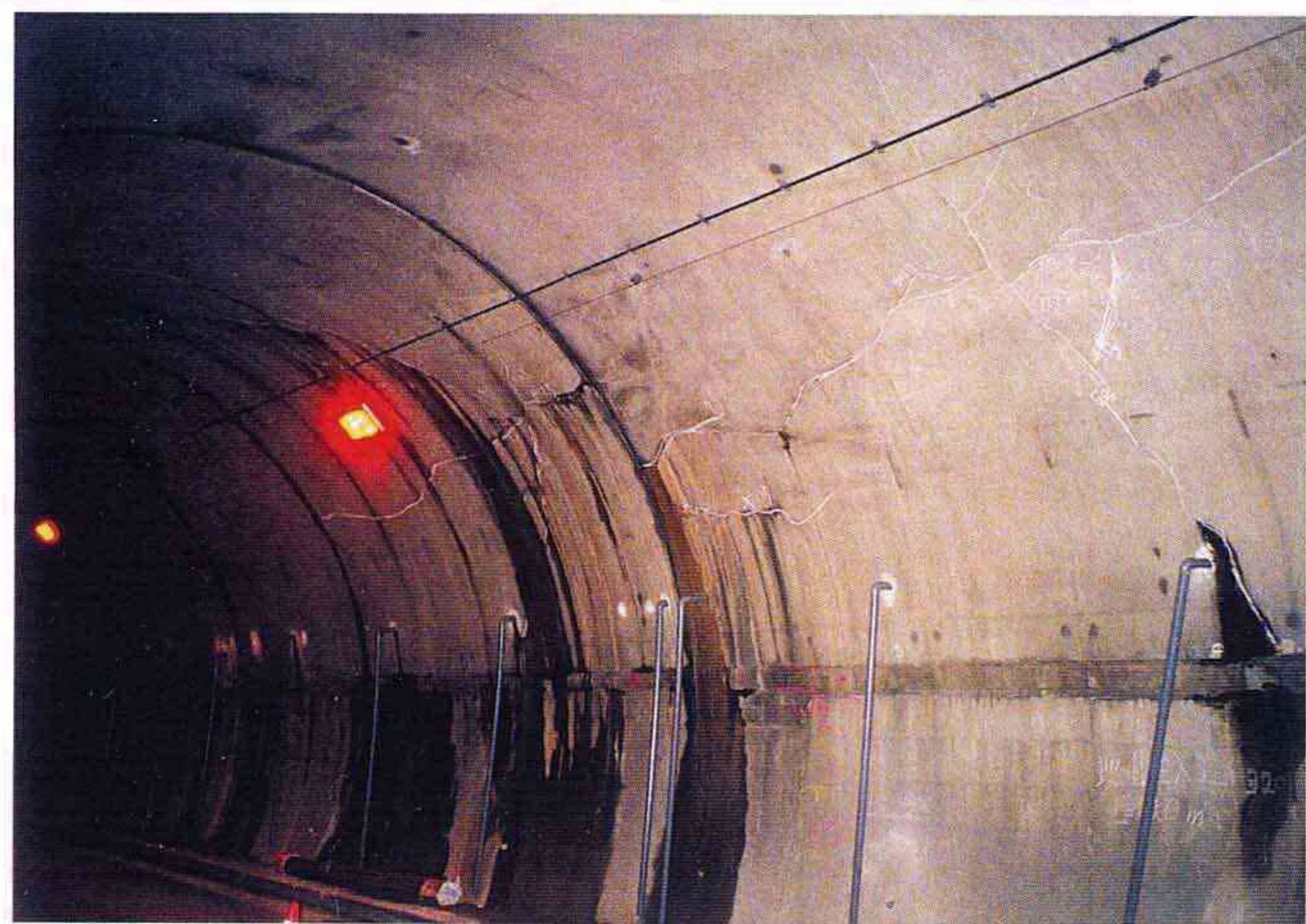
被災状況写真
