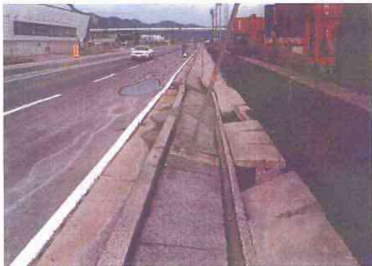
県道境外港線南側側溝の変状
