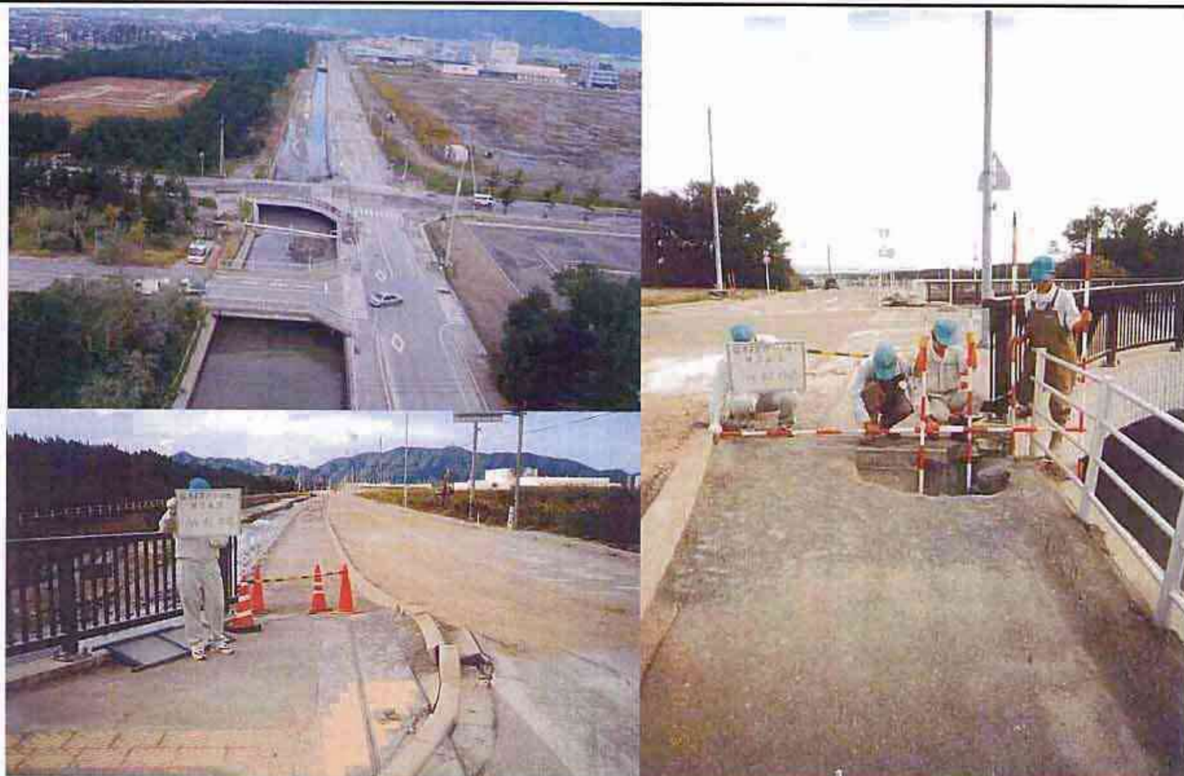
被災状況写真
