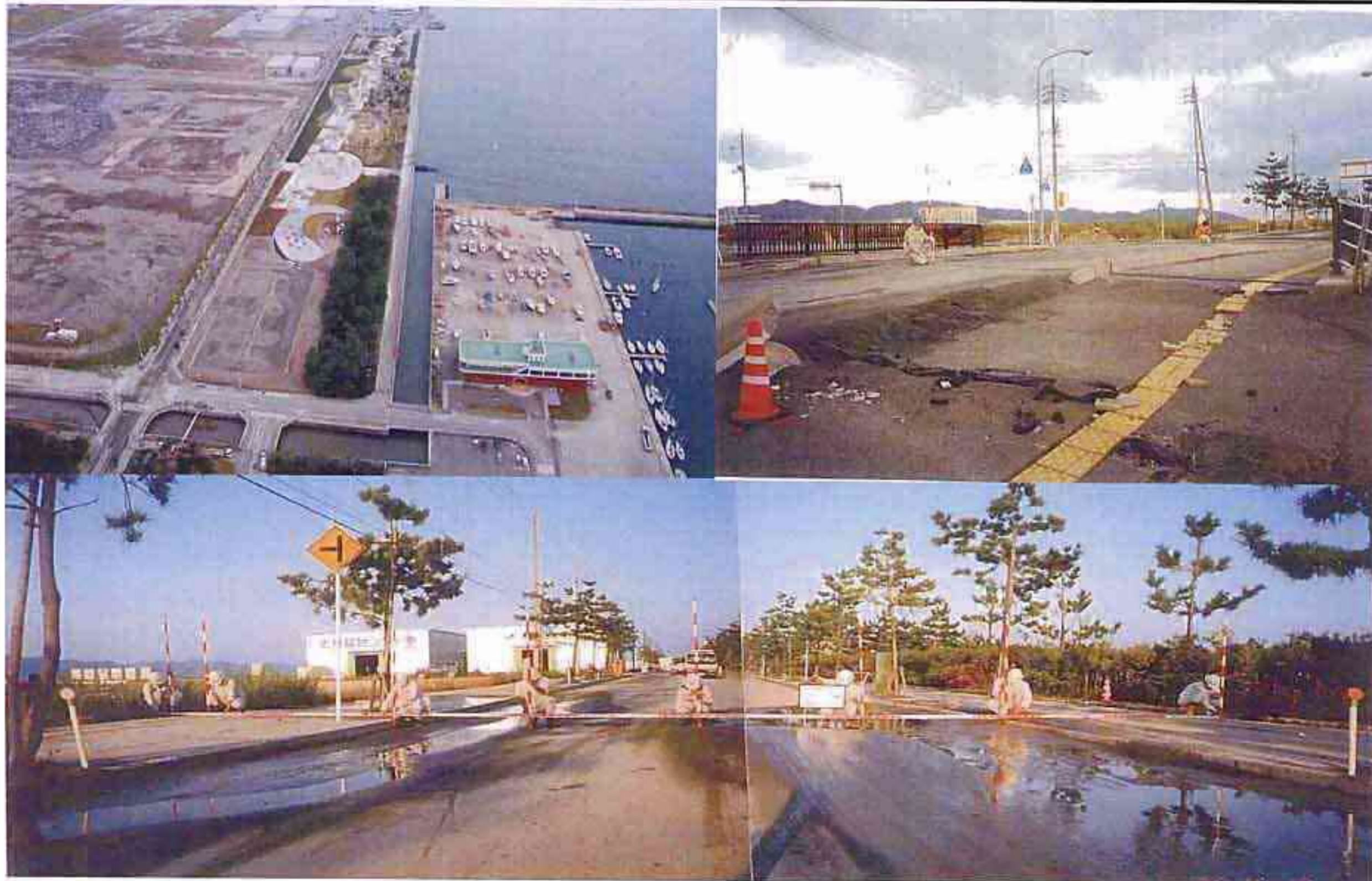
被災状況写真
