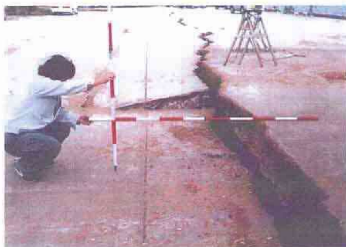
外港昭和南埠頭の抜け上がり（北側の沈下）
