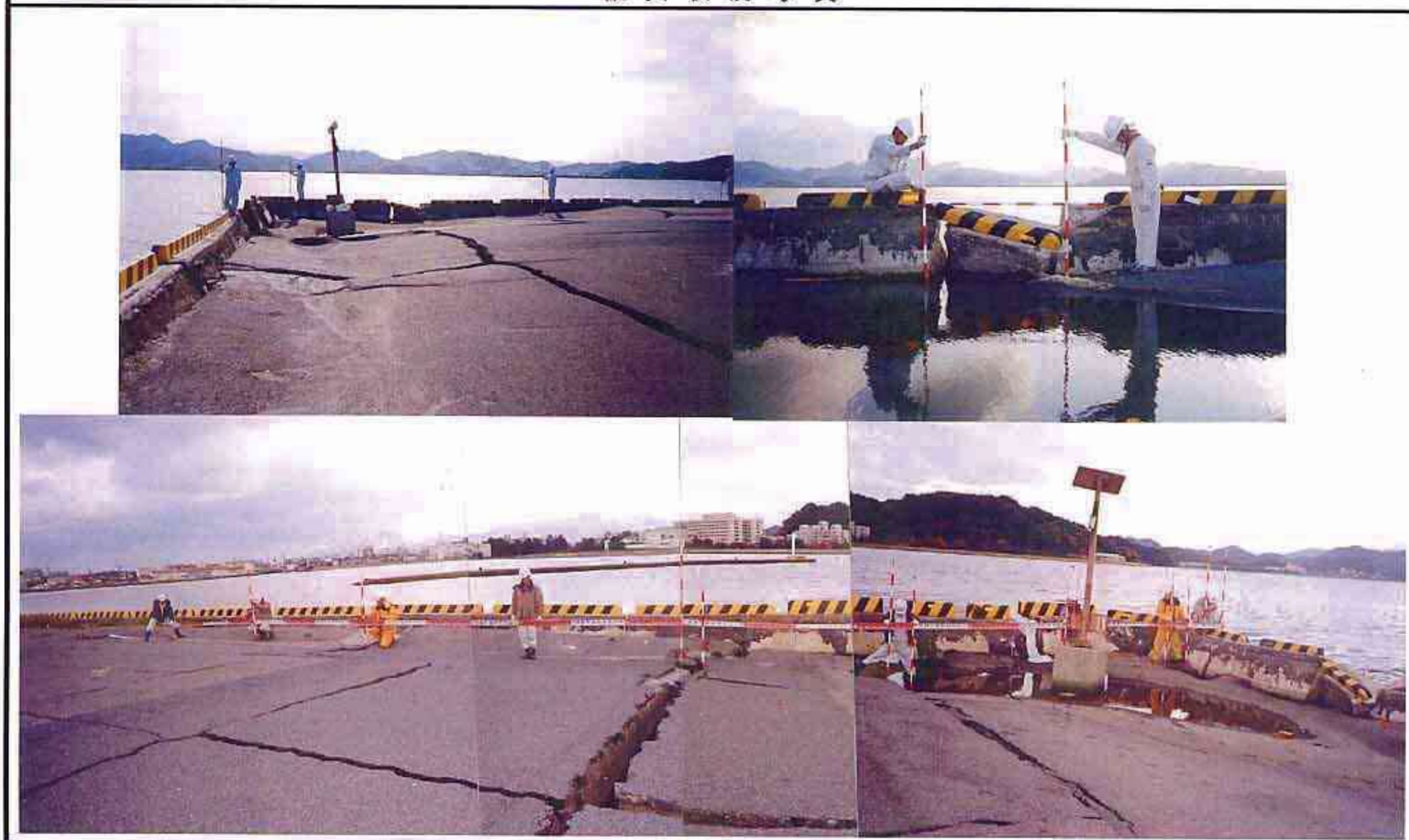
被災状況写真
