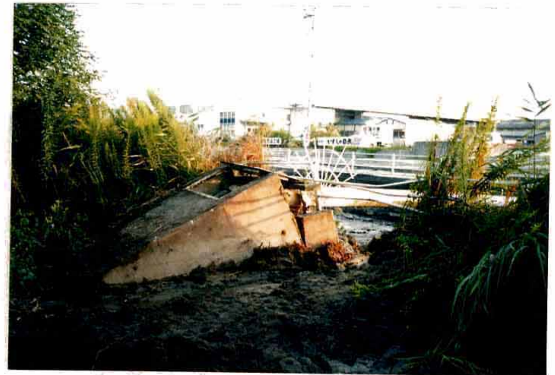
竹内団地 承水路河床の盛り上がり (約1.5メートル)
