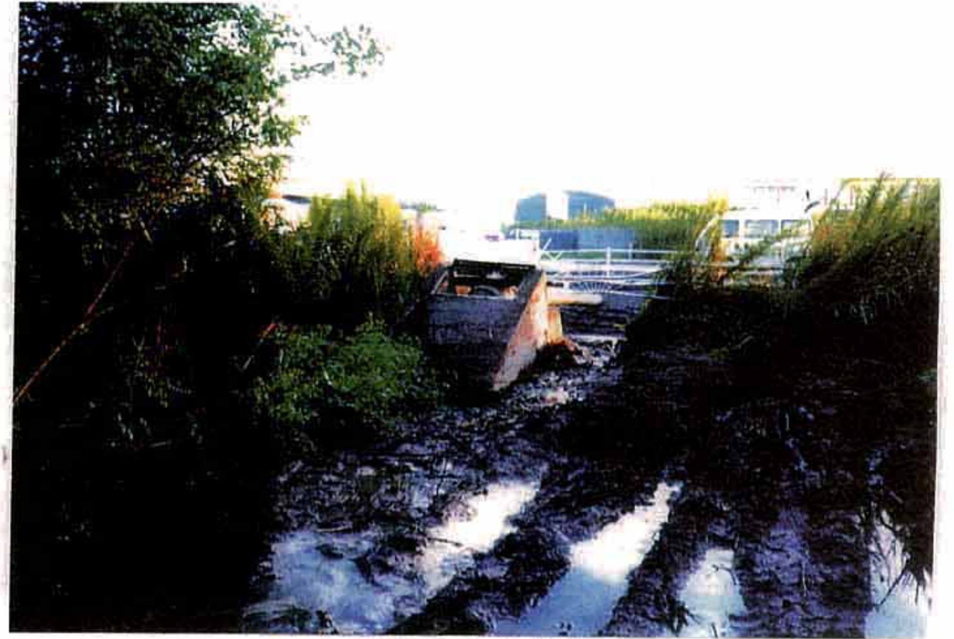
水管橋橋台部隆起
