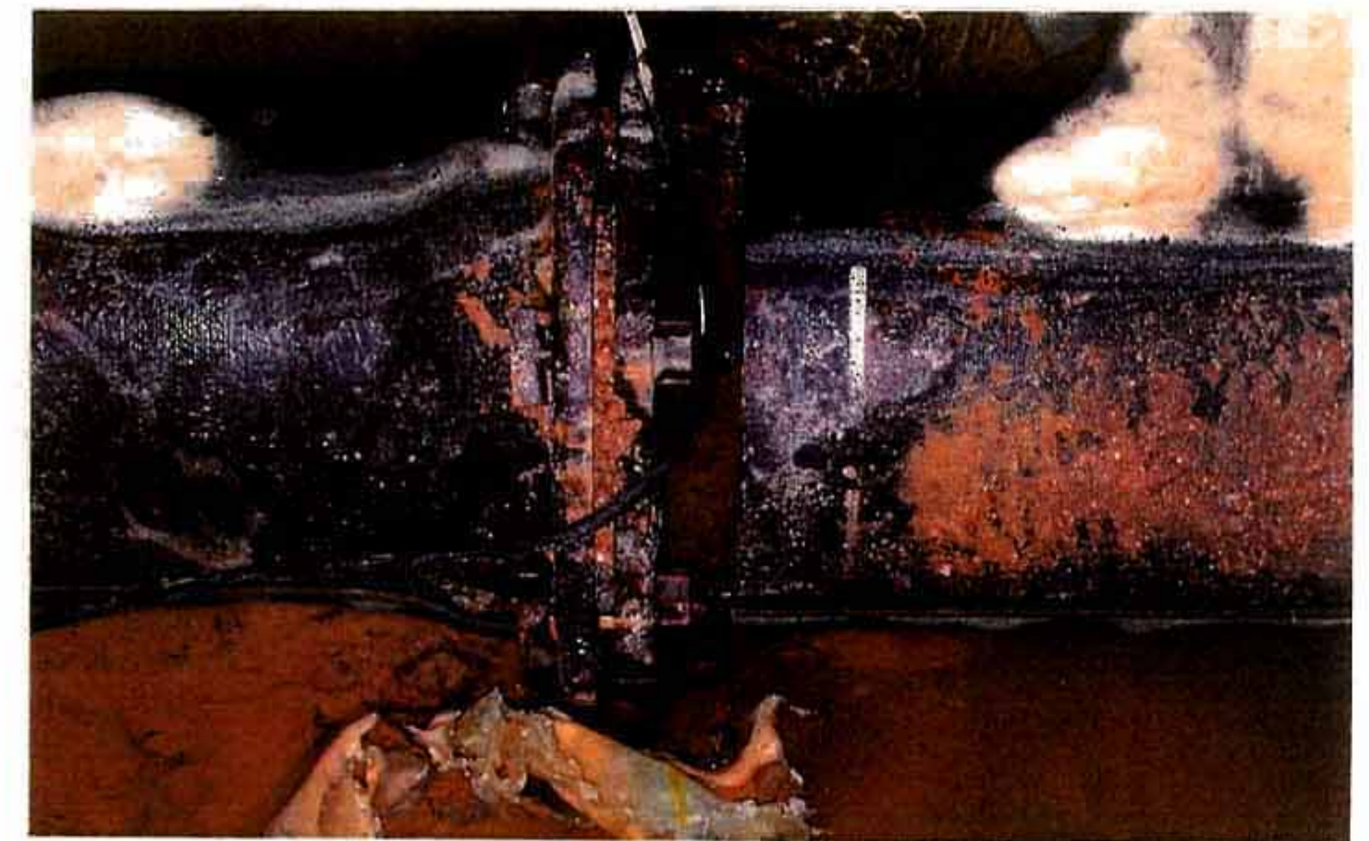
配水管離脱状況 (管径 200mm)
