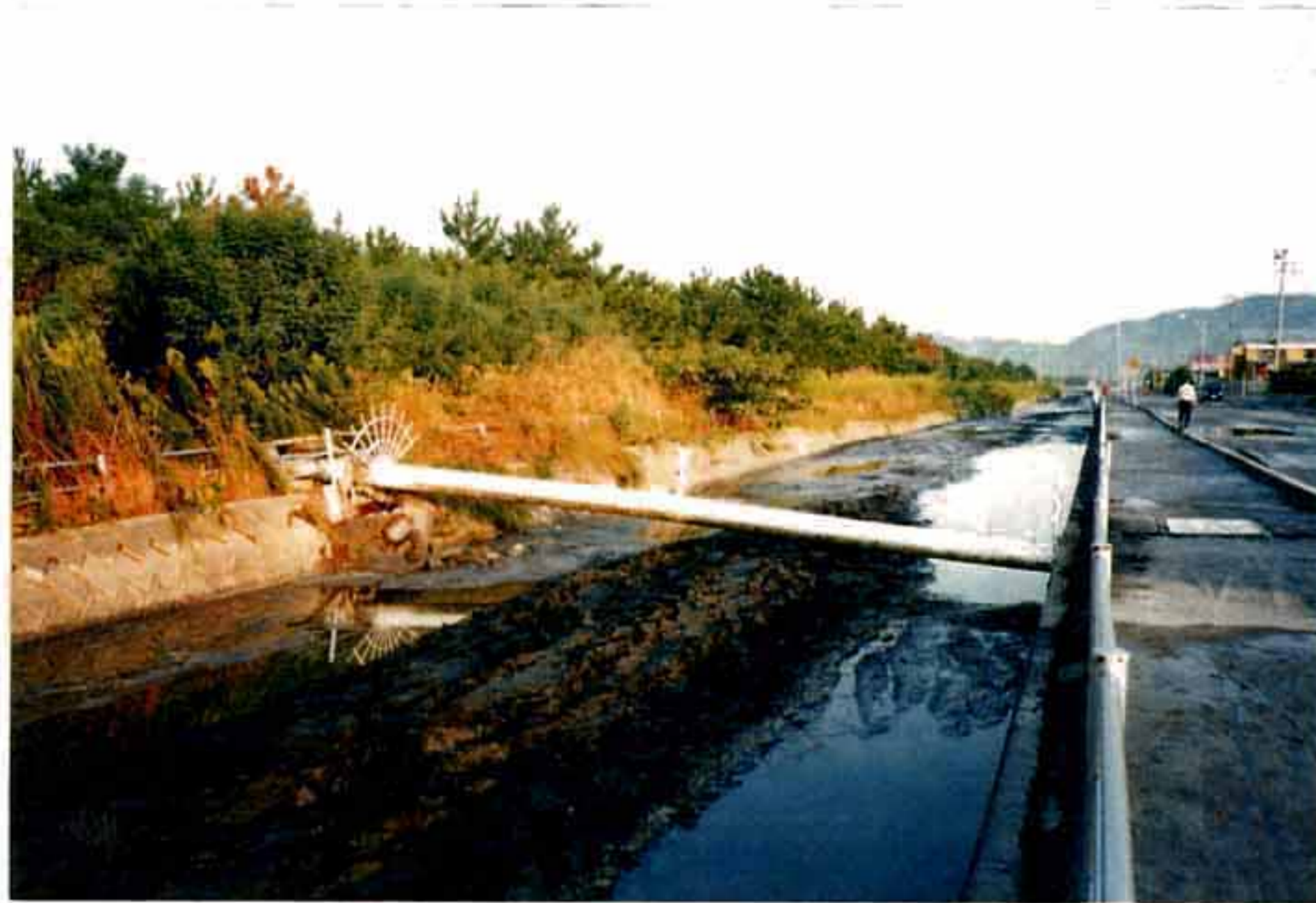
竹内団地 承水路水管橋 (径300mm)
