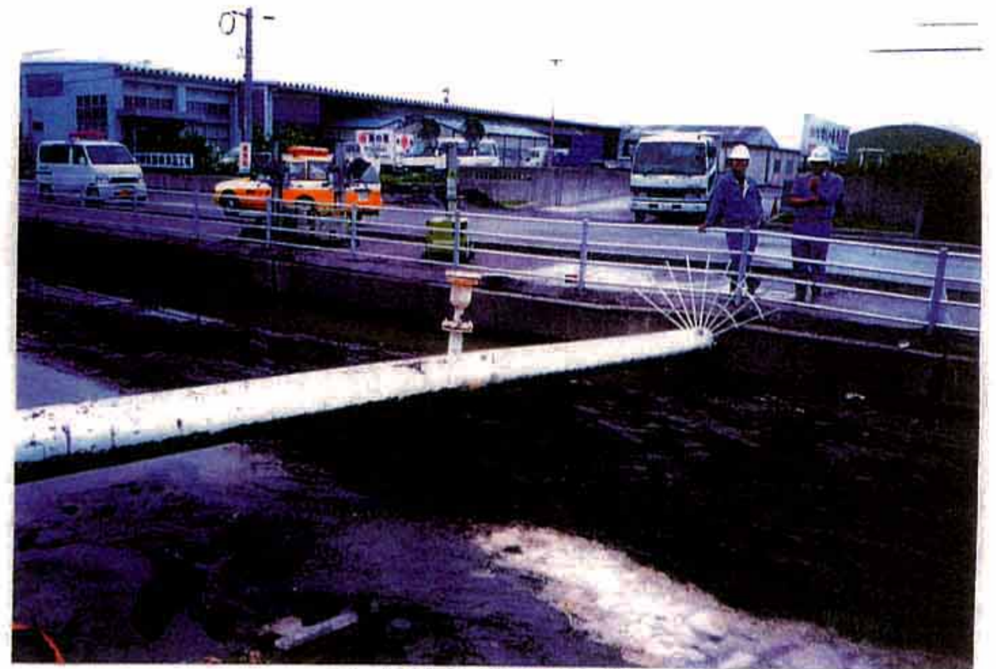
承水路の河床隆起
