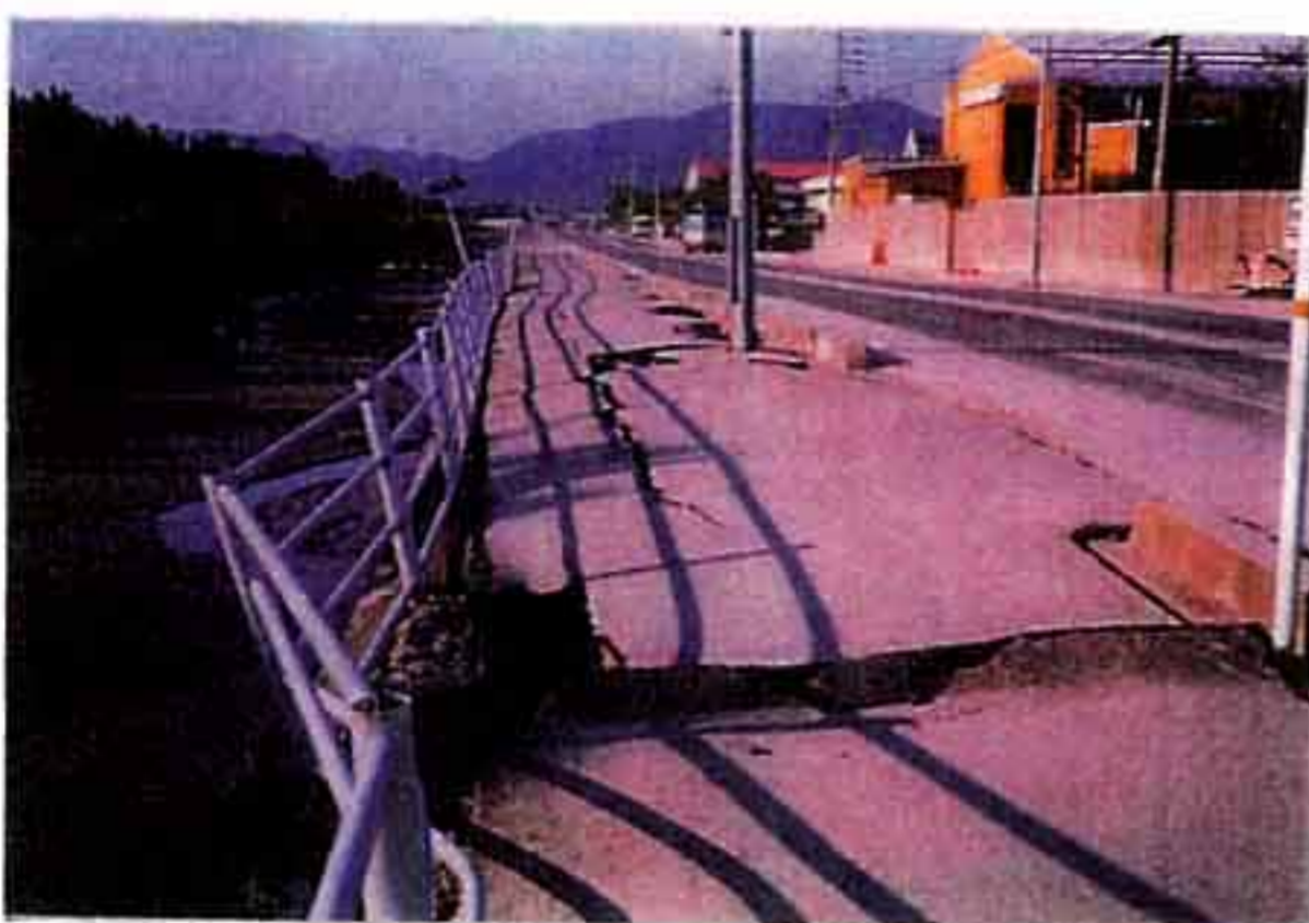
竹内マリーナ線 (クラック、沈下)
