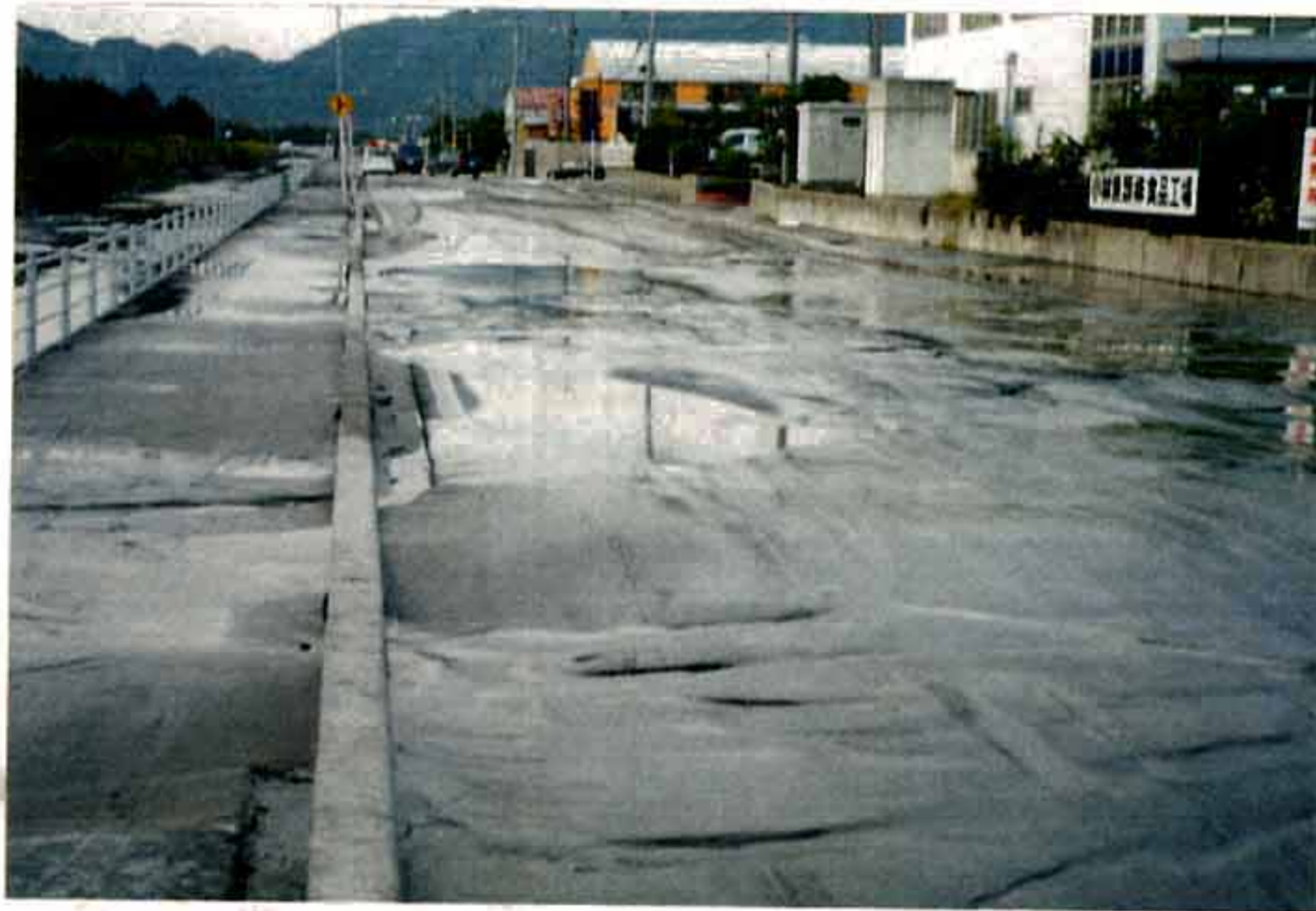
竹内団地 液状化状況
