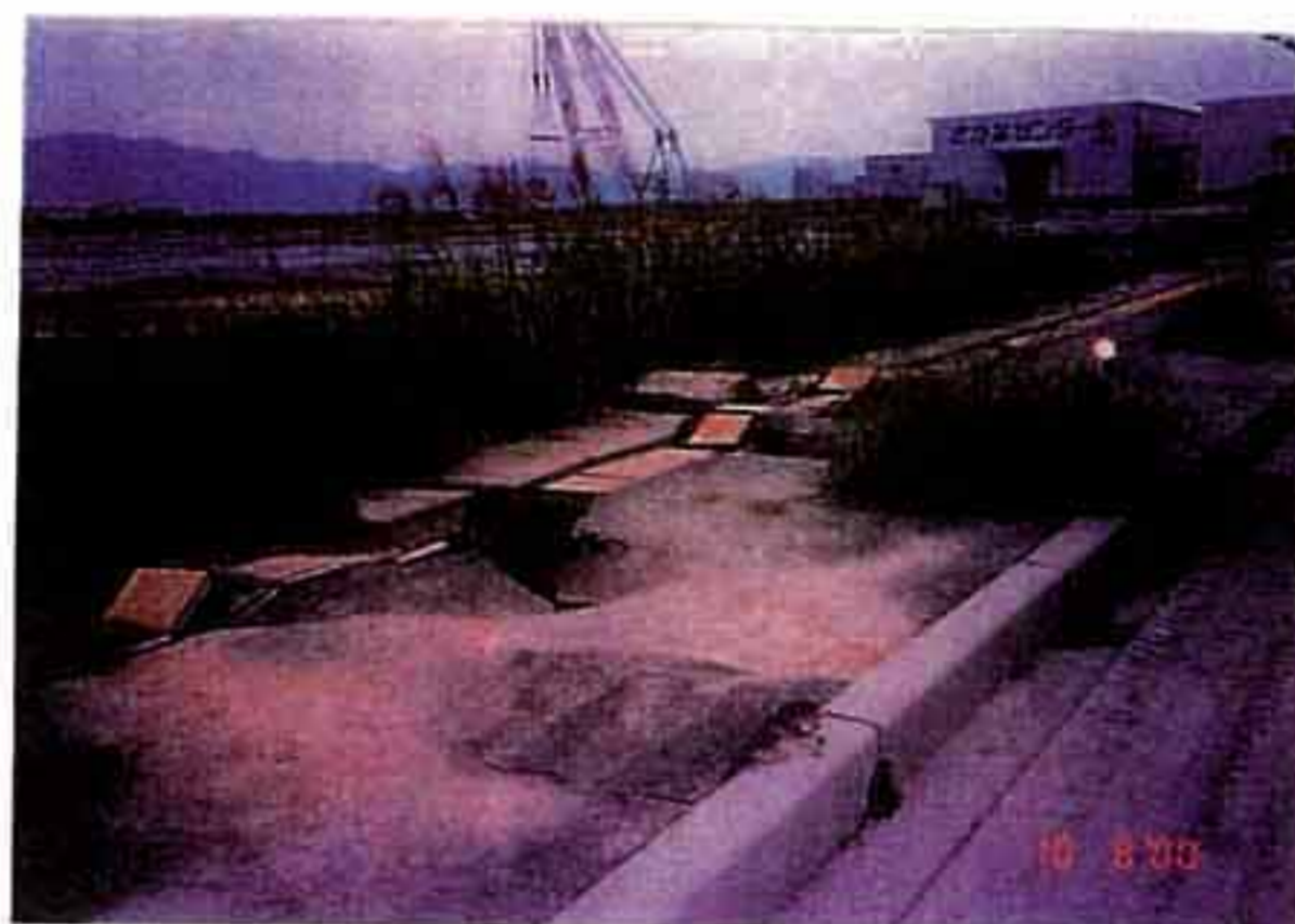
竹内埠頭1号線 (歩道) (陥没)
