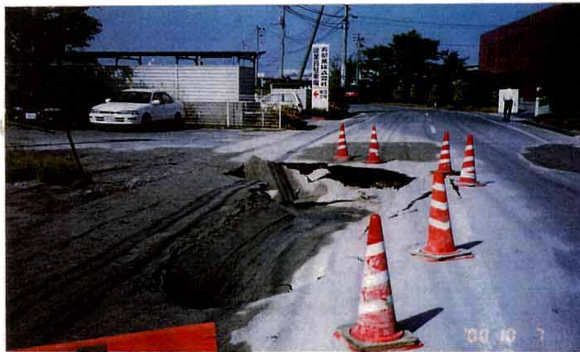
米子市旗ヶ崎地内 漏水による道路の陥没 (寿製菓付近)
