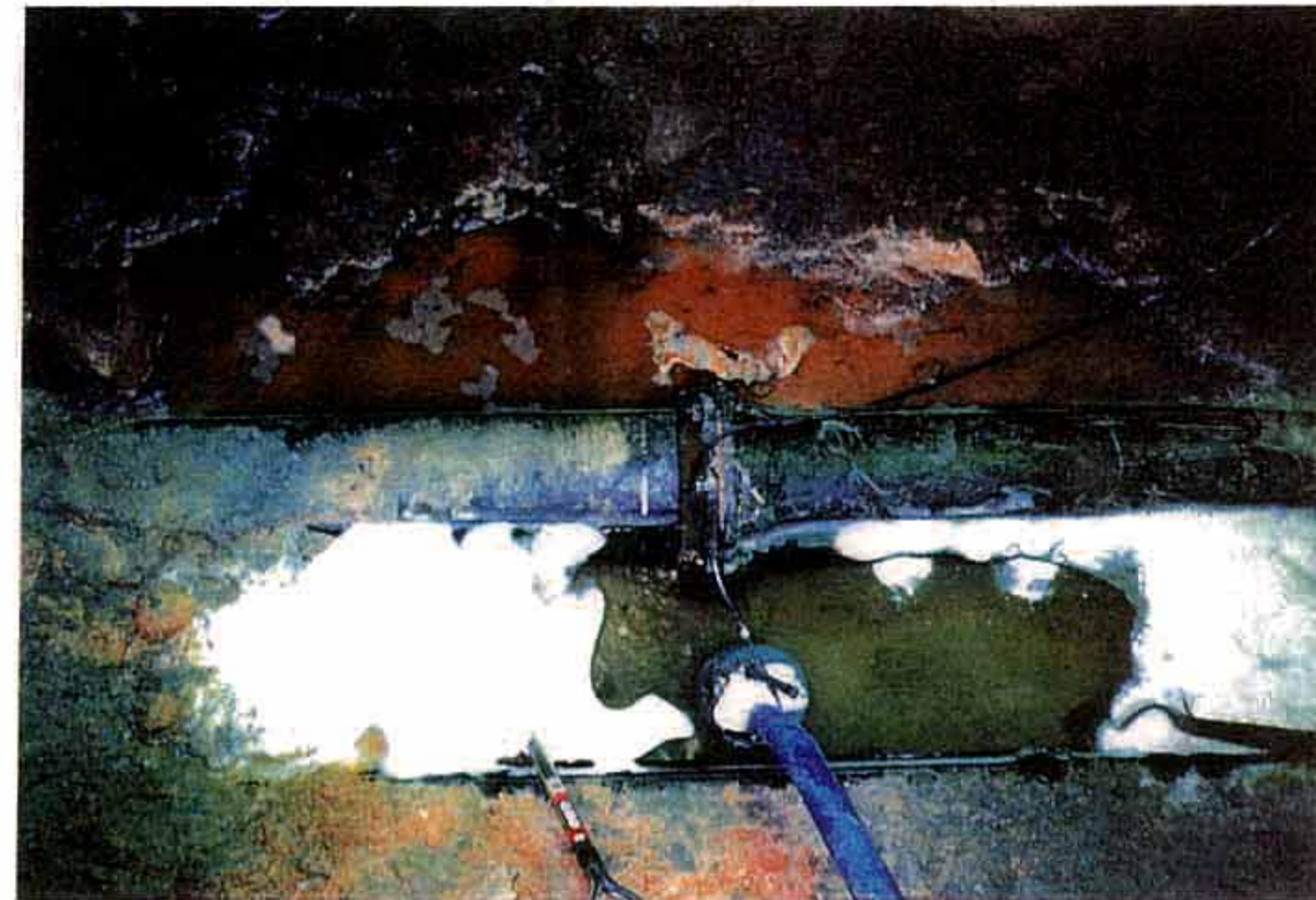
配水管継ぎ手 離脱状況
