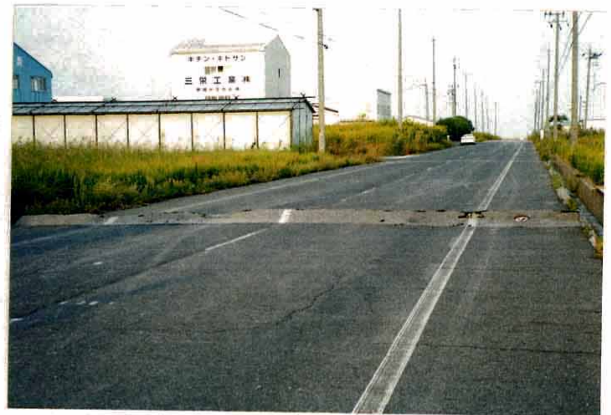
竹内団地 6号線舗装隆起
