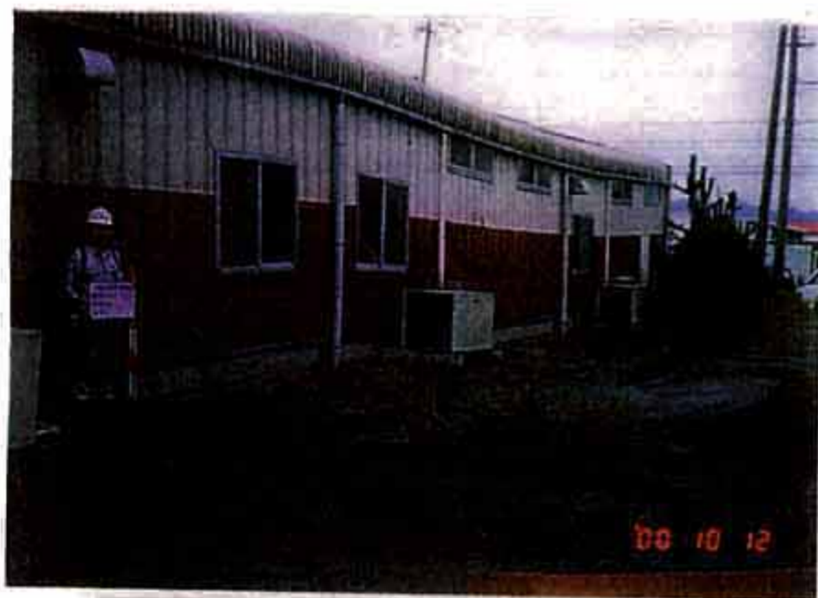
企業建物 (不等沈下による変形)
