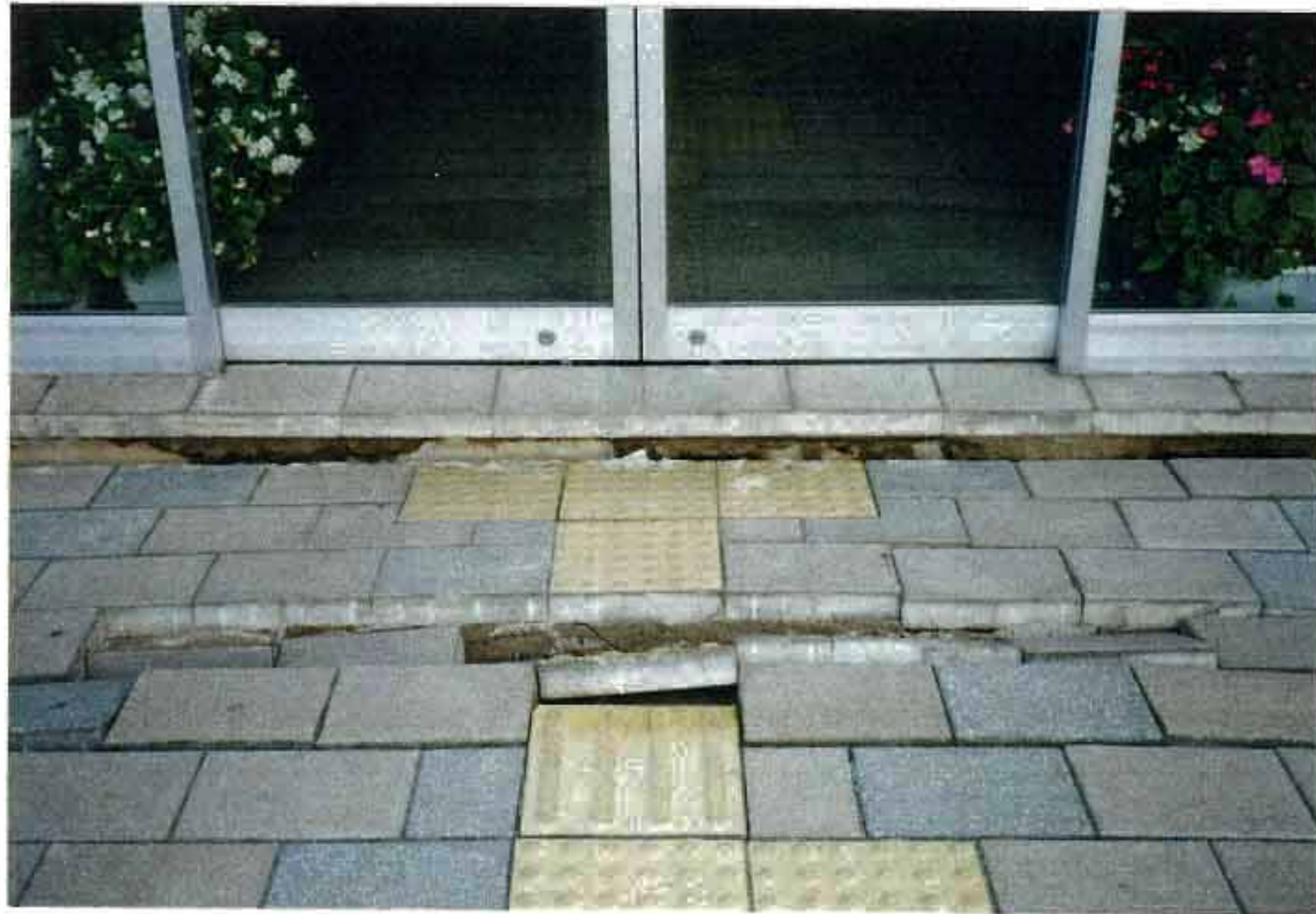
みなと温泉館 玄関インターロッキングブロックめくれ
