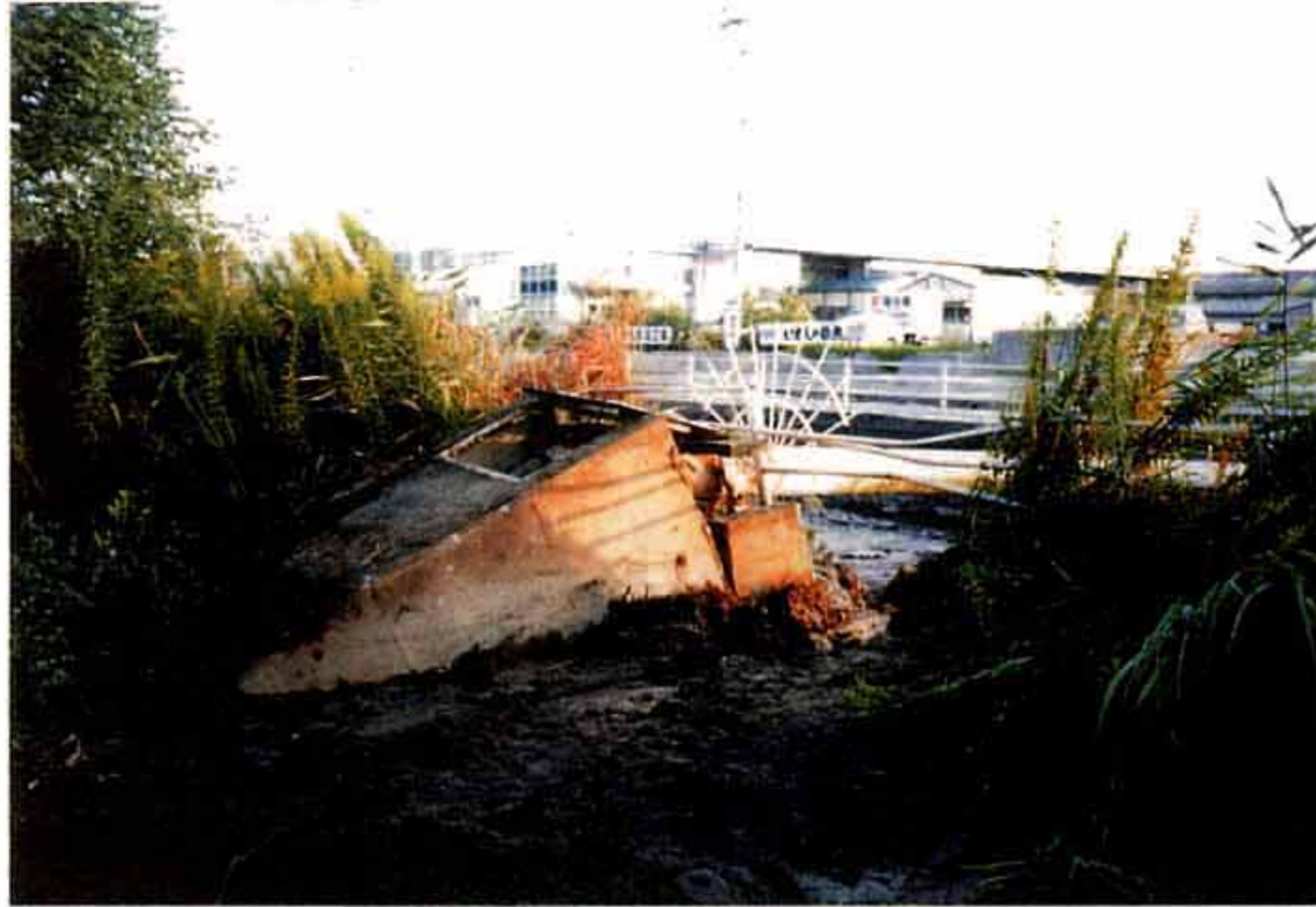
竹内団地 承水路水管橋 (300mm) (承水路河床の隆起)
