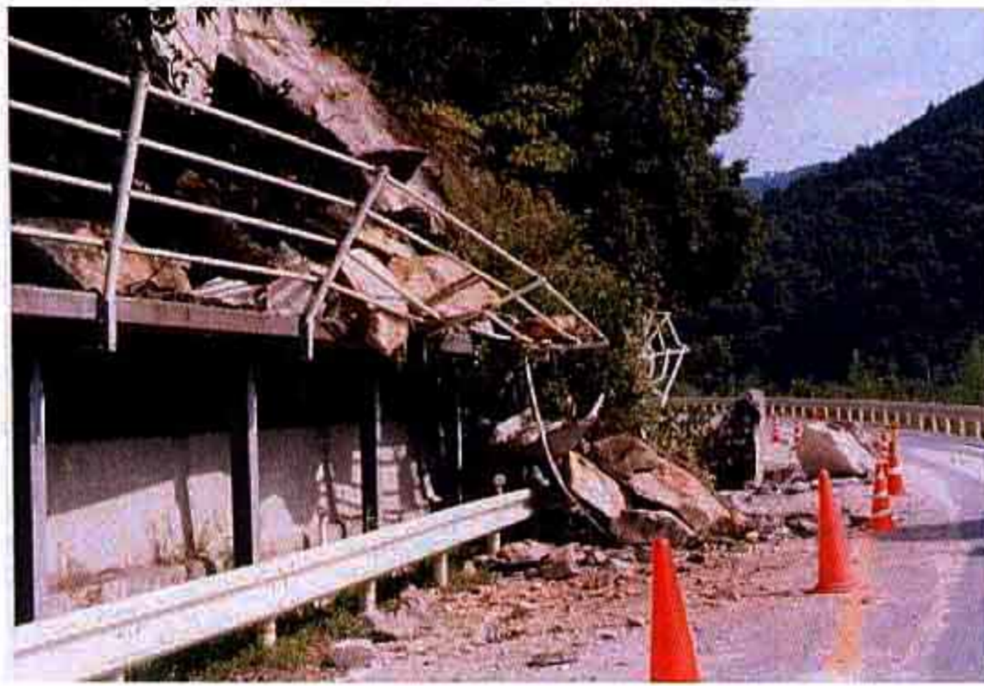
④落石による歩道の被災（国道180号 日野町） 14)
