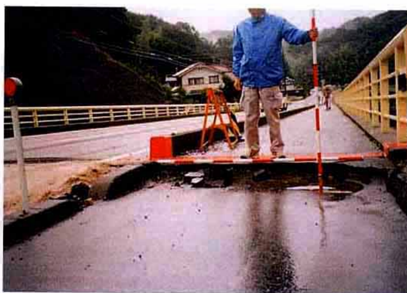
③橋台裏込め土の沈下（国道180号 西伯町） 9)
