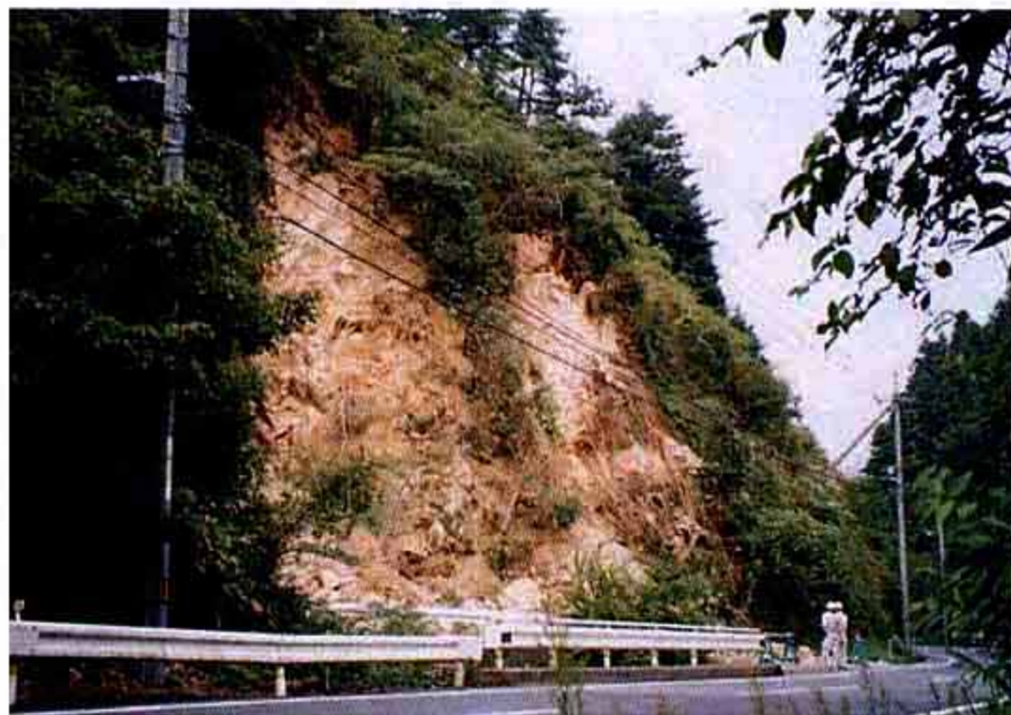
⑤斜面崩壊（国道180号 西伯町） 9)
