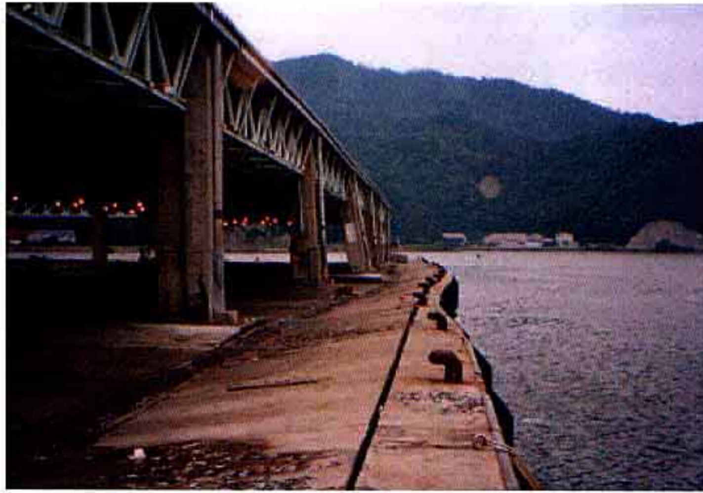
⑩岸壁のはらみ出し（境港漁港） 6)
