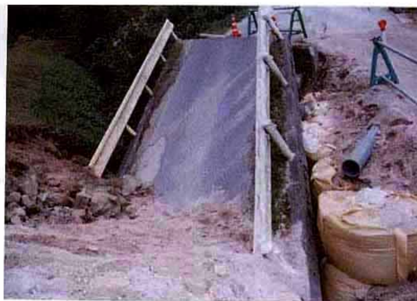
①赤谷橋の落橋（西伯町） 7)
