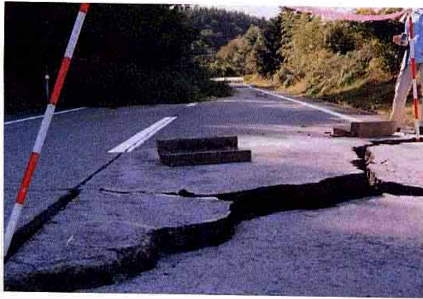
⑰道路の被害（溝口町） 14)
