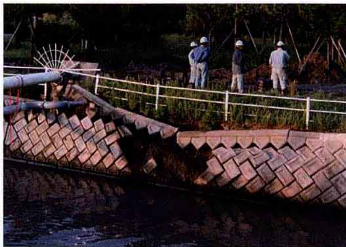
⑫護岸の崩壊（竹内工業団地） 7)
