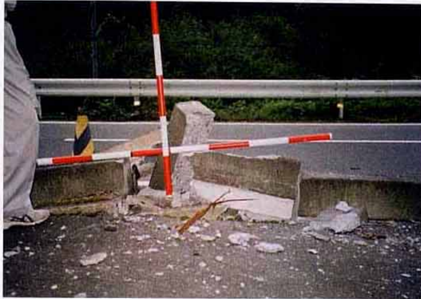
⑧縁石の破壊と路面の亀裂（国道180号 西伯町） 8)
