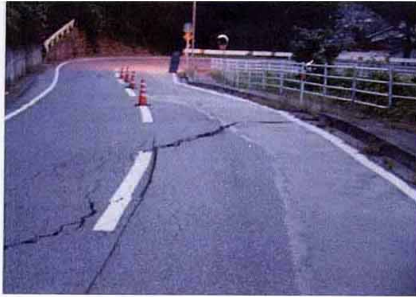
⑦路面の亀裂（江府町） 7)
