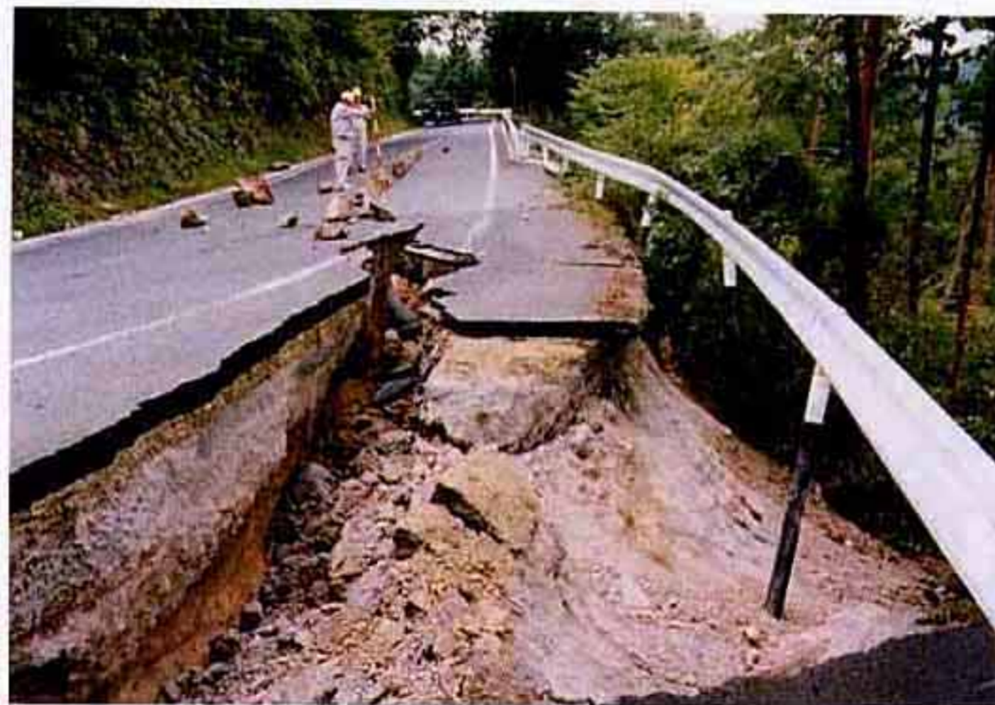
⑨盛土のり面の崩壊（江府町） 9)
