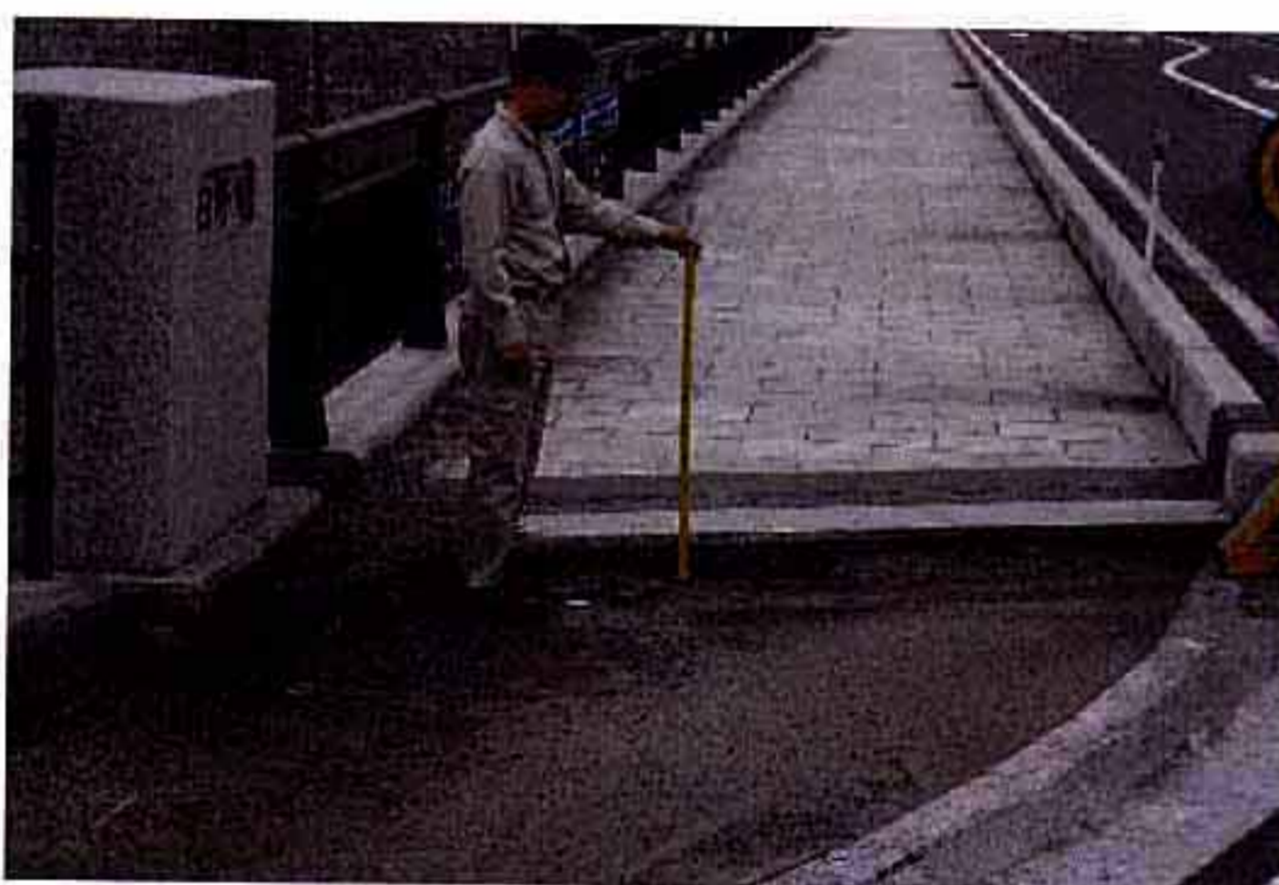
②橋台裏込め土の沈下（日野町） 11)
