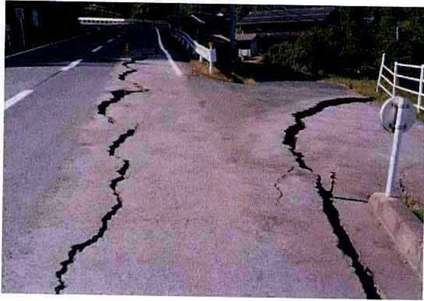
⑯路面の亀裂（溝口町） 14)
