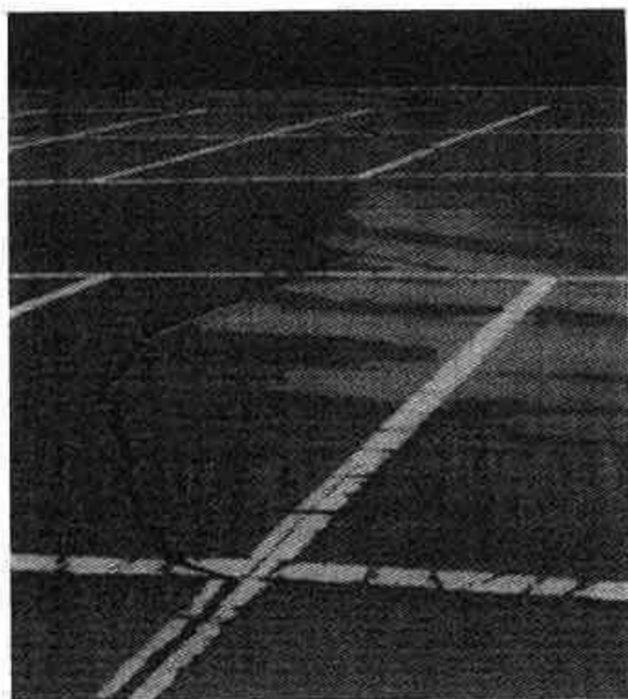
写真一七 千屋花見温泉駐車場舗装の破壊
