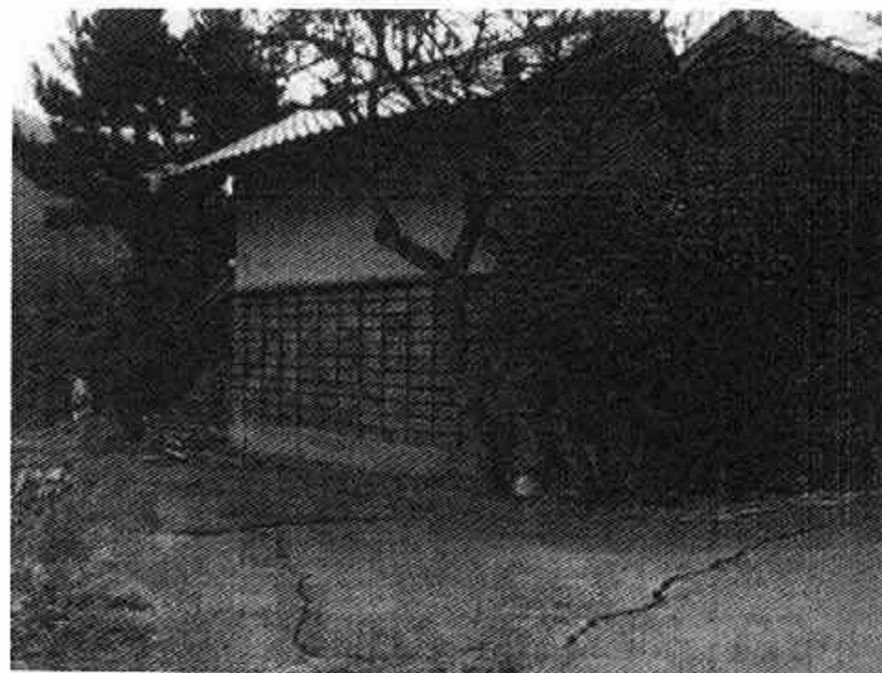
写真-4 土蔵および地盤の被害
