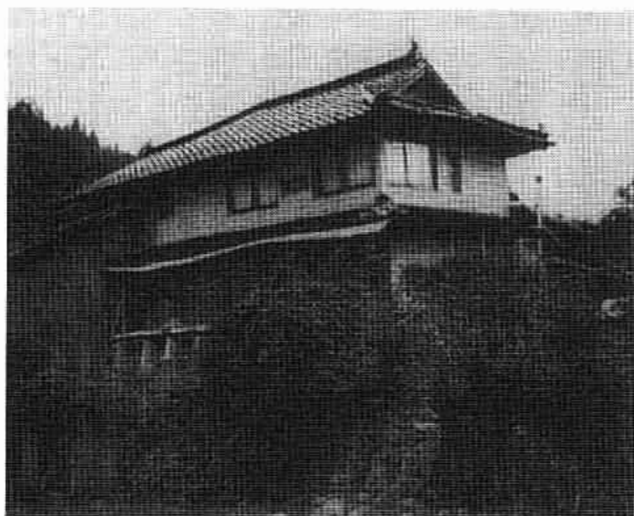
写真-1 石垣地盤上の住宅被害
