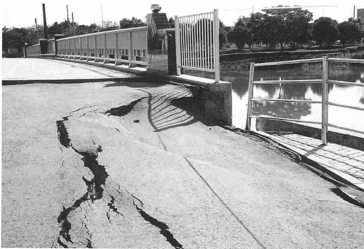
陥没した道路（中浜サントピア）
