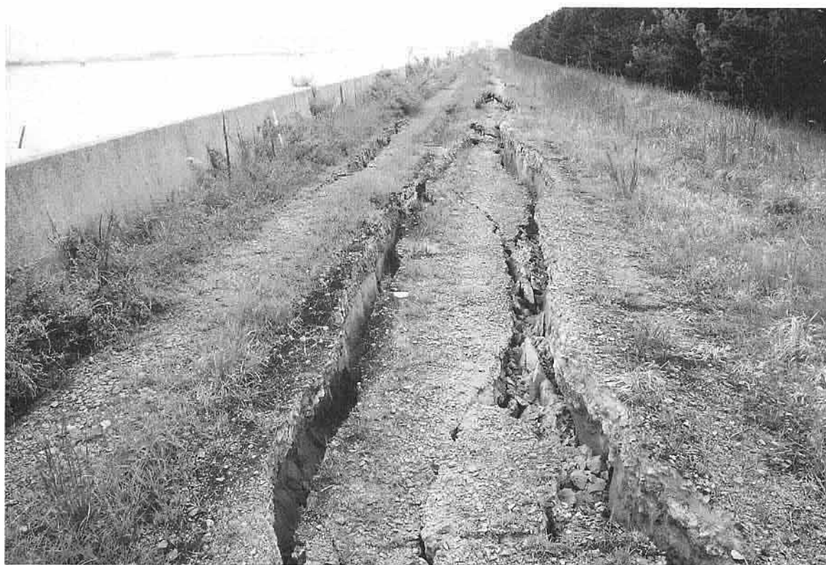
地割れのできた堤防（中海干拓地）
