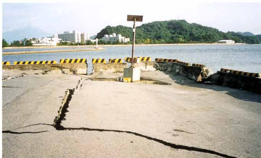
米子港埠頭の被害
