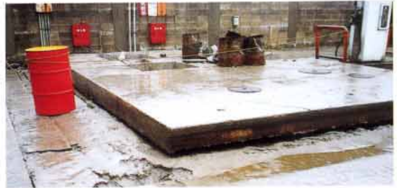
自家用給油取扱所の被害
