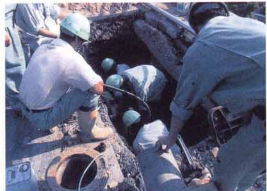
ガス管の被害
