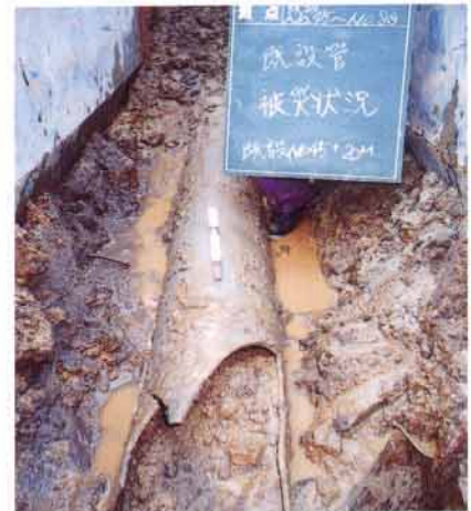
下水道の被害
