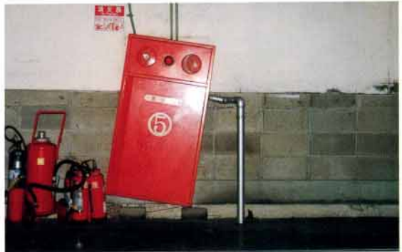
屋内消火栓の被害
