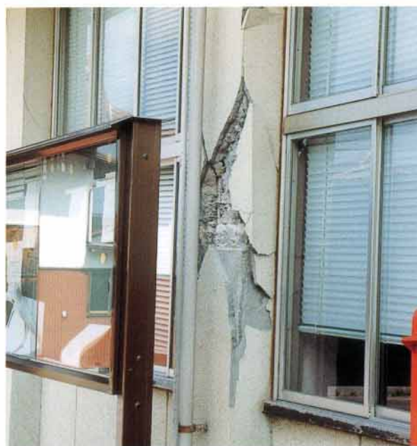
溝口町役場の被害
