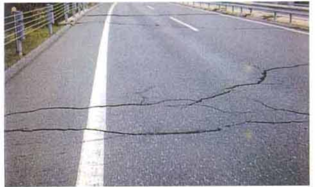
高速道路の被害
