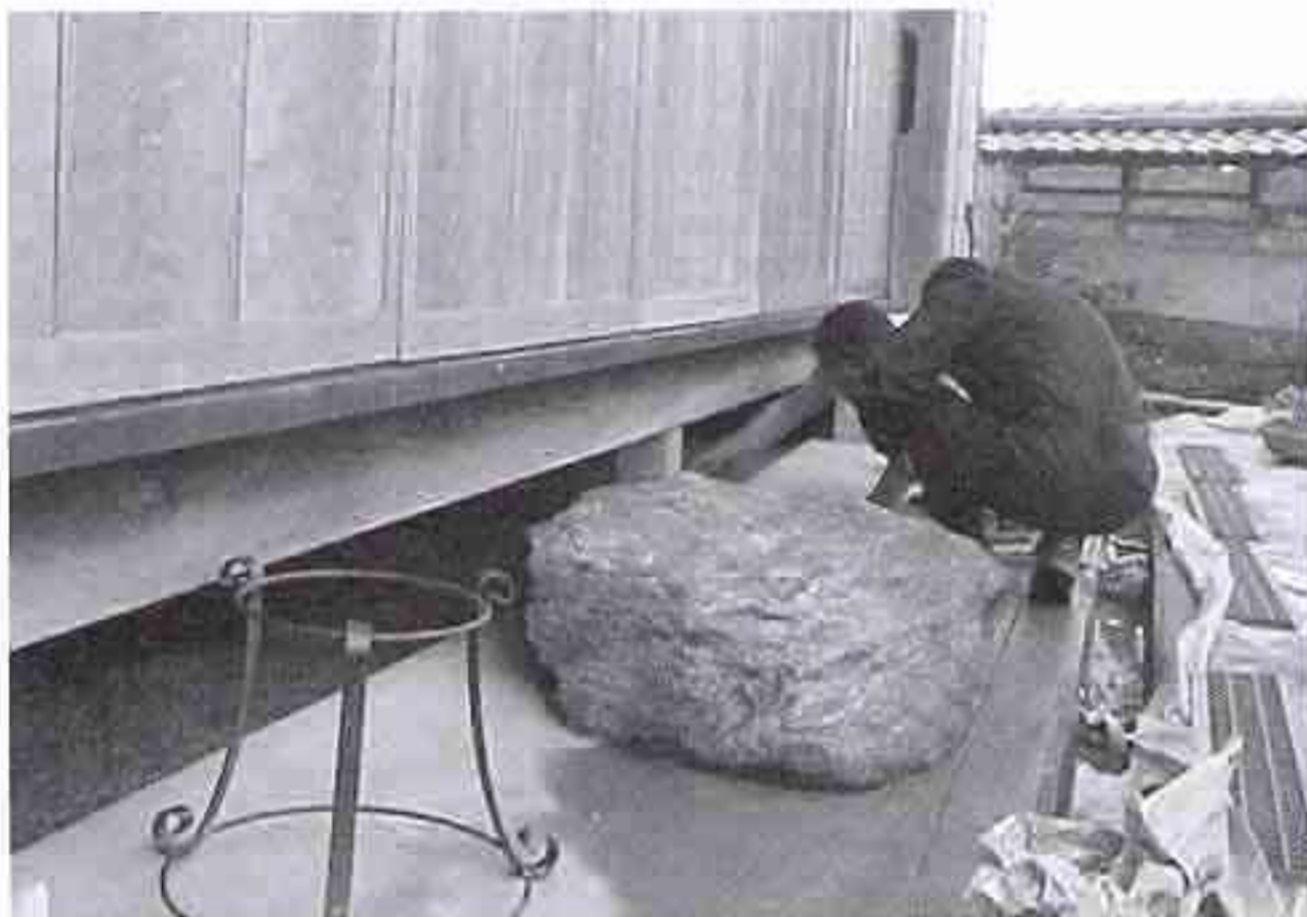
床下に起きた地割れ-1（神塚）
