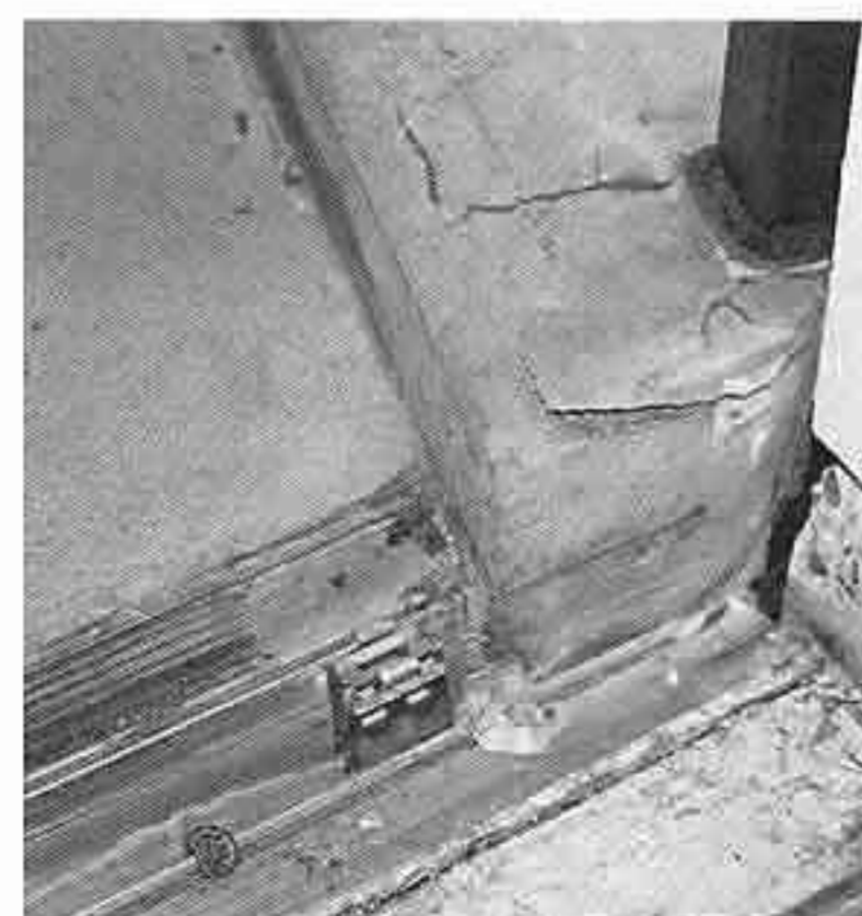
新館渡り廊下ジョイント部分のはく離
