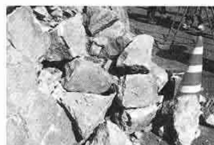
ブロック塀の落下（吉佐町）
