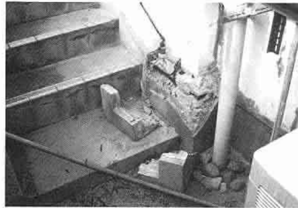
階段部コンクリートの崩壊
