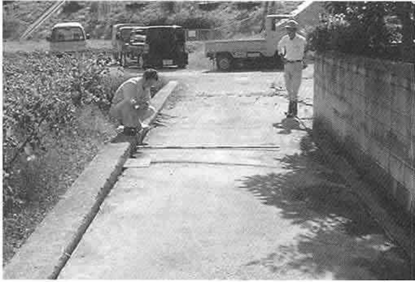
大きく陥没した道路
