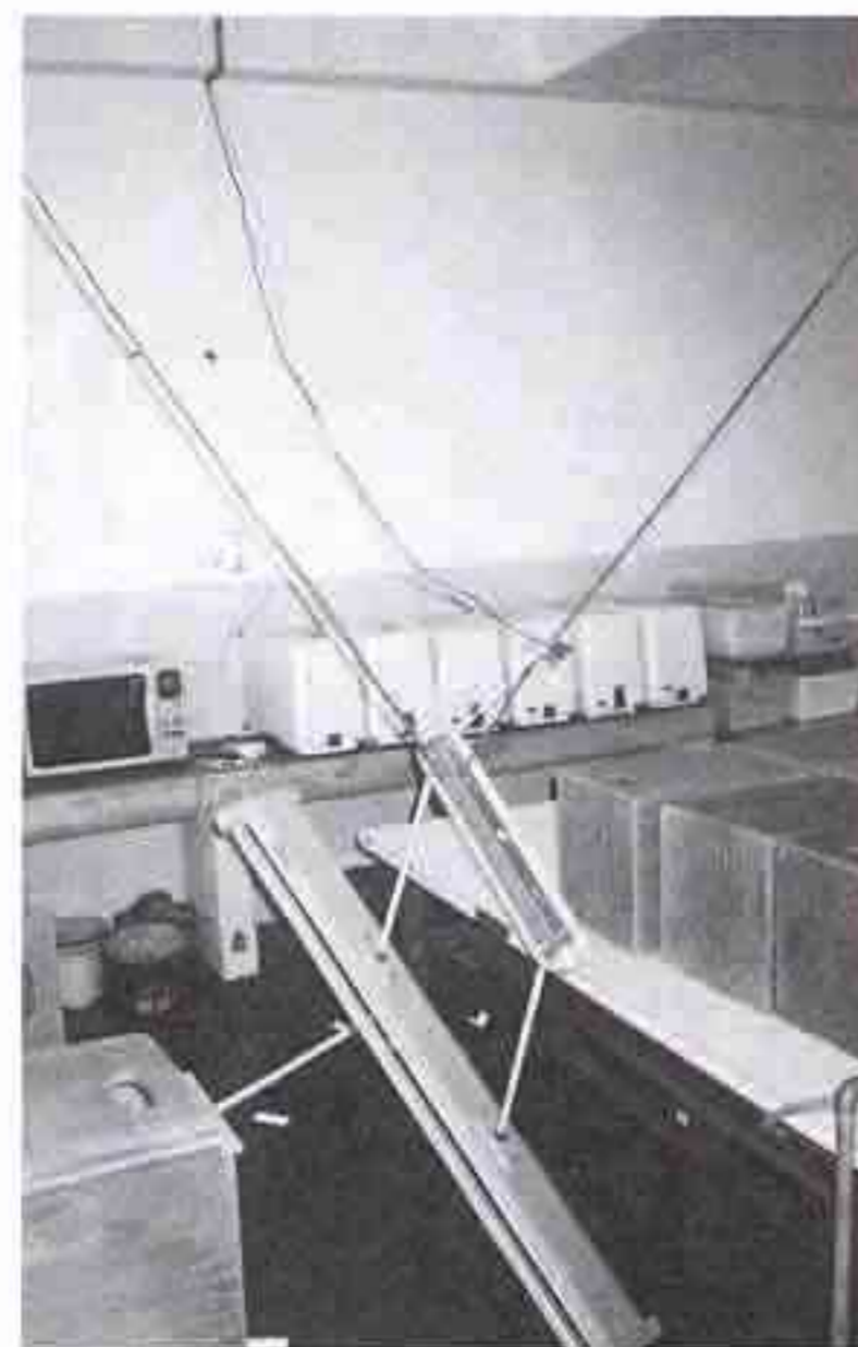
家庭科室の蛍光灯が落下
