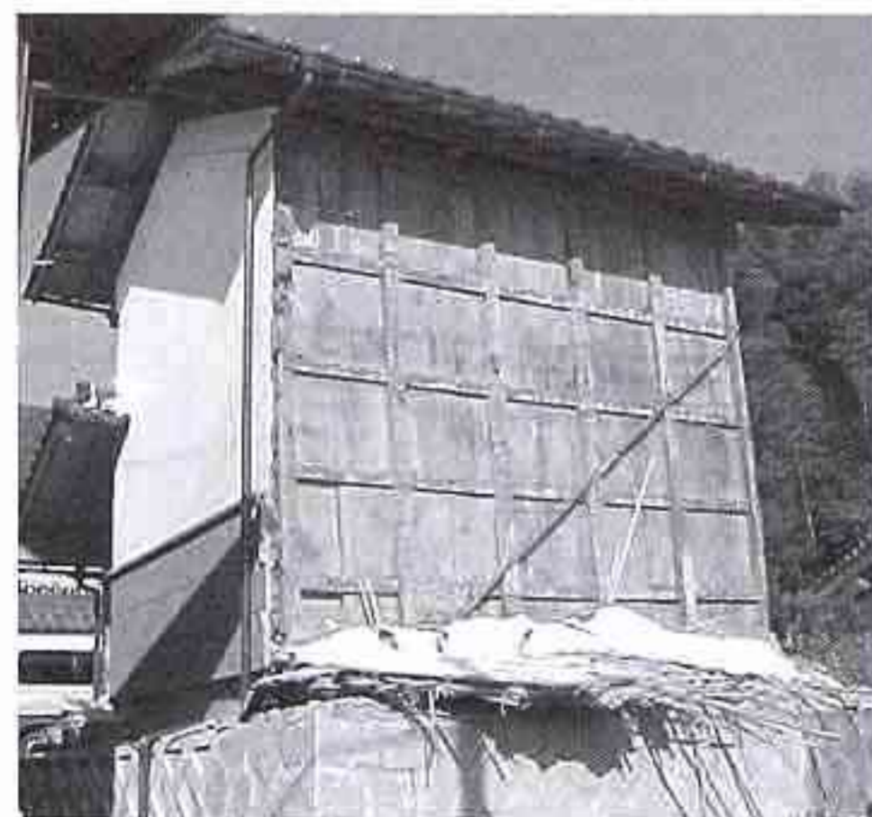
外壁が落下した倉
