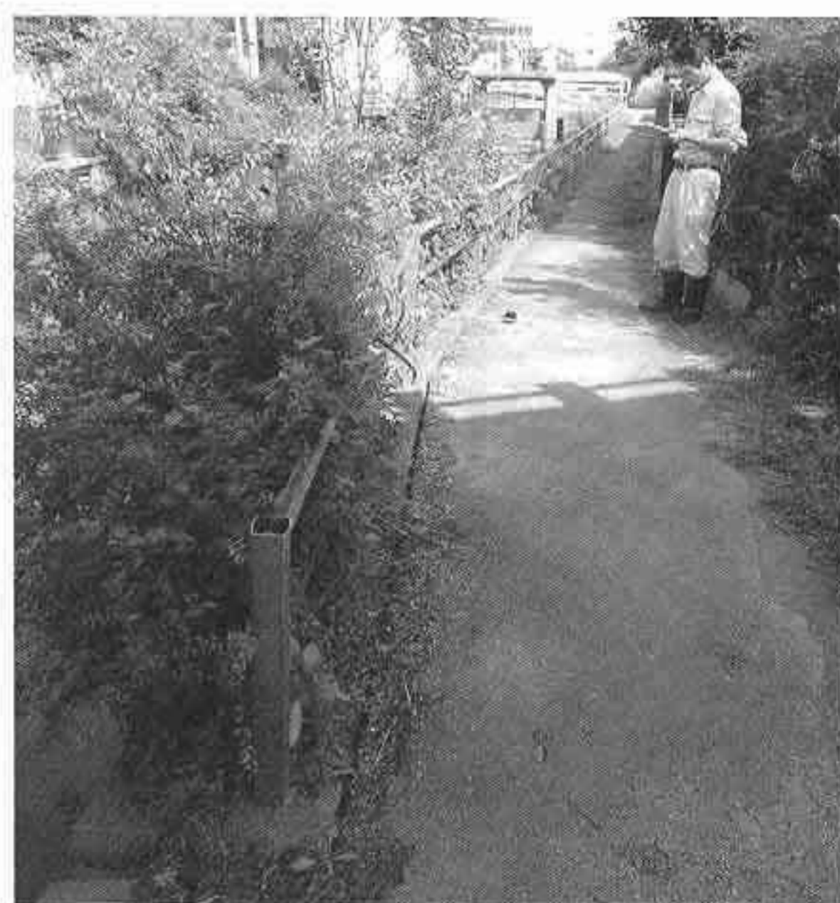
河川の遊歩道に入った亀裂（大橋東）
