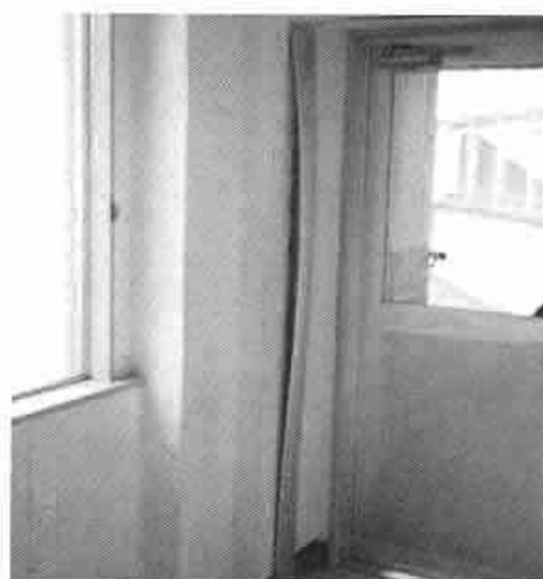
本館2階 扉ステンレス枠の亀裂
