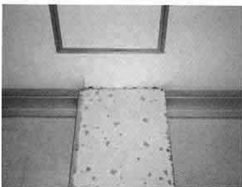
本館～北館渡り廊下の扉上部天井ボード破損
