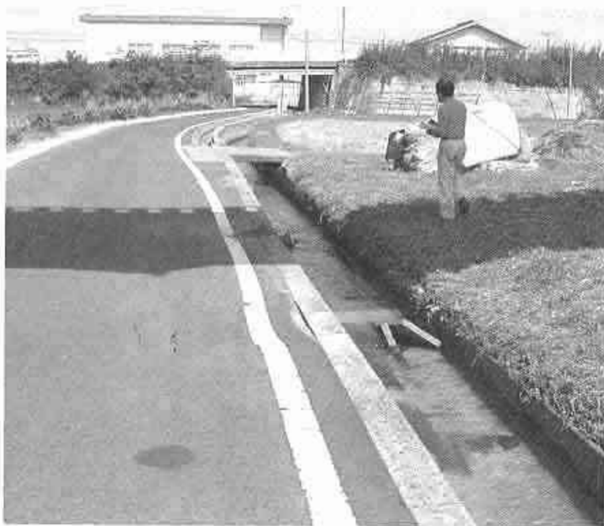
一部が陥没した路溝（才下町）
