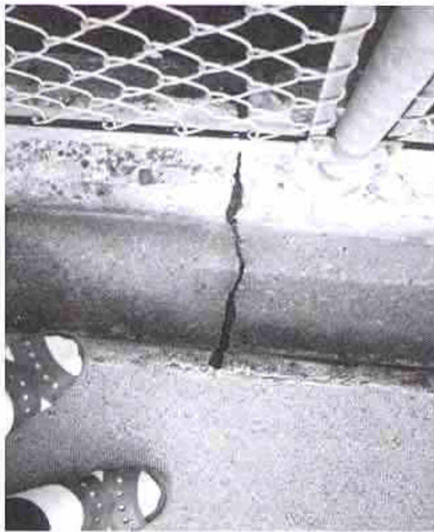
プール場側壁にできた亀裂
