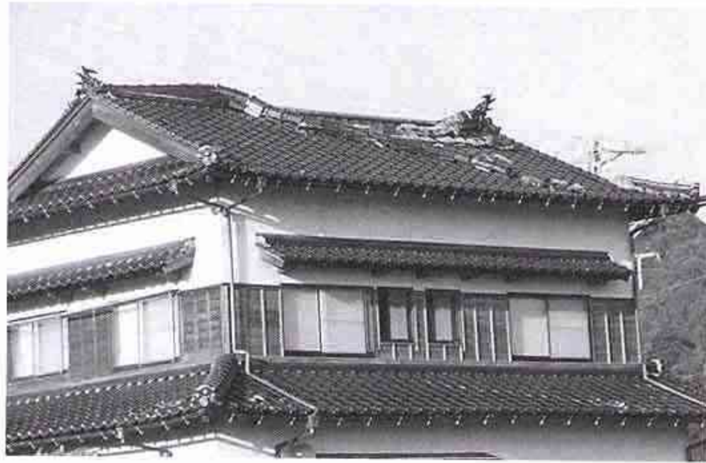
瓦のずれ（門生町）
