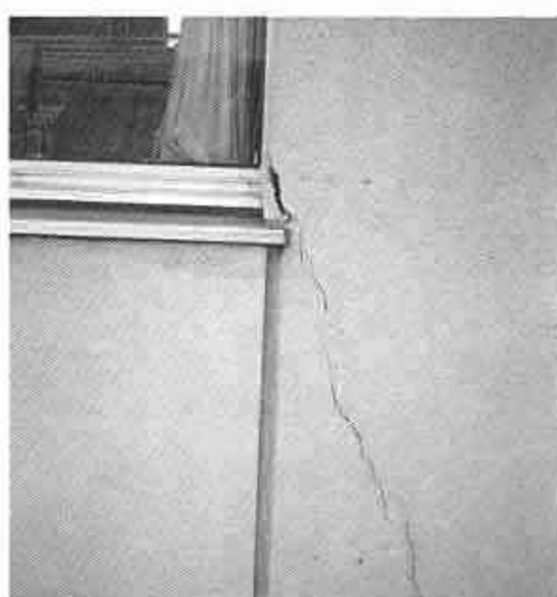
保健室外壁の亀裂
