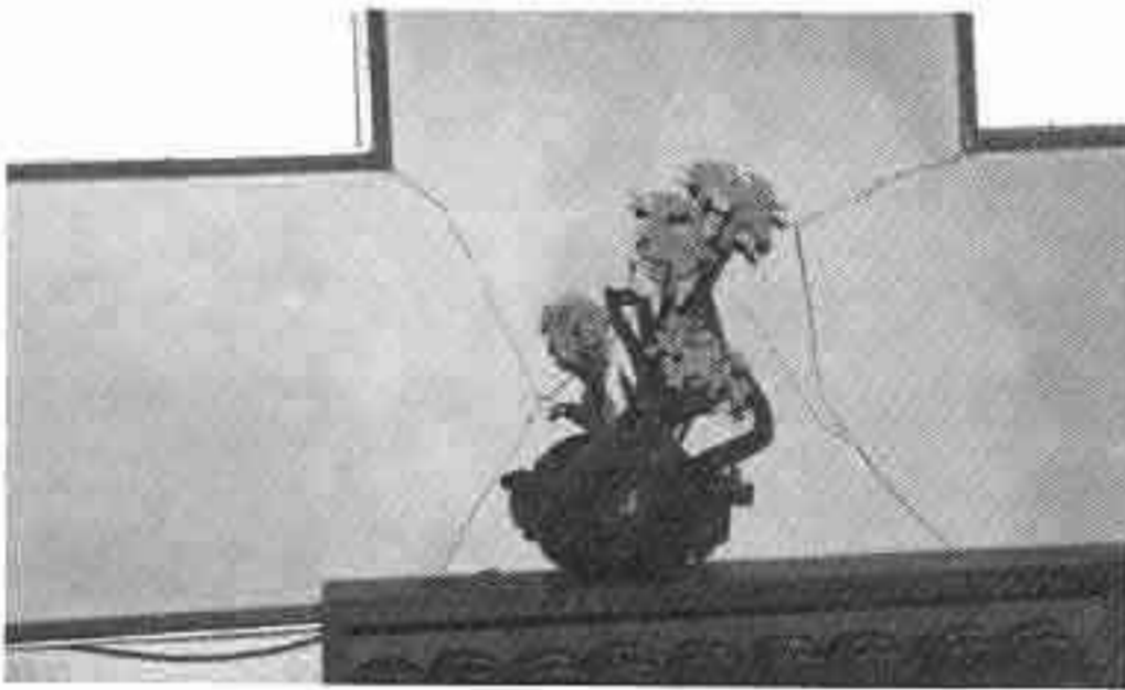
内面にできた亀裂
