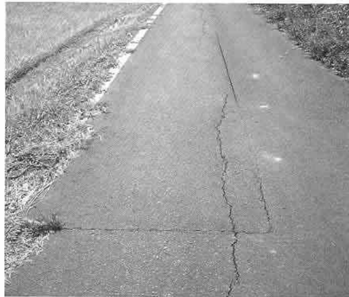
亀裂した道路（門生町）
