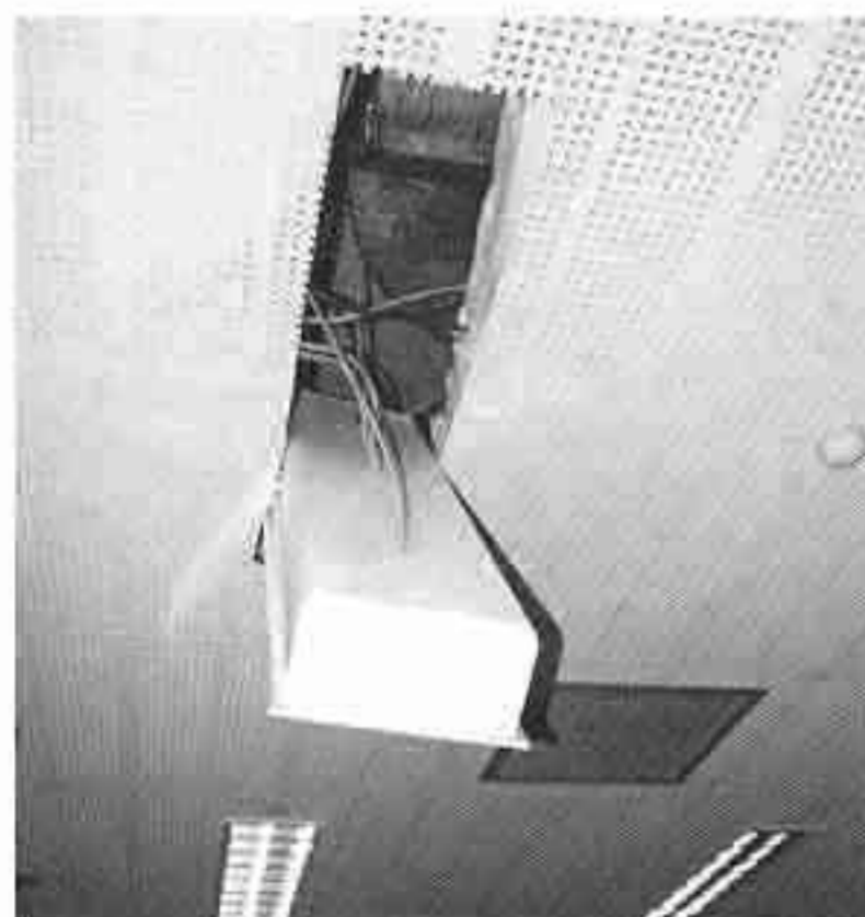
PC教室の蛍光灯破損
