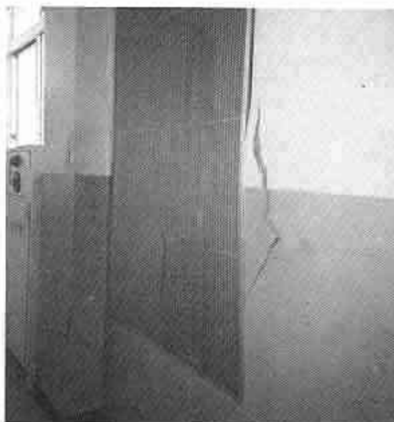
廊下の内壁にできた亀裂
