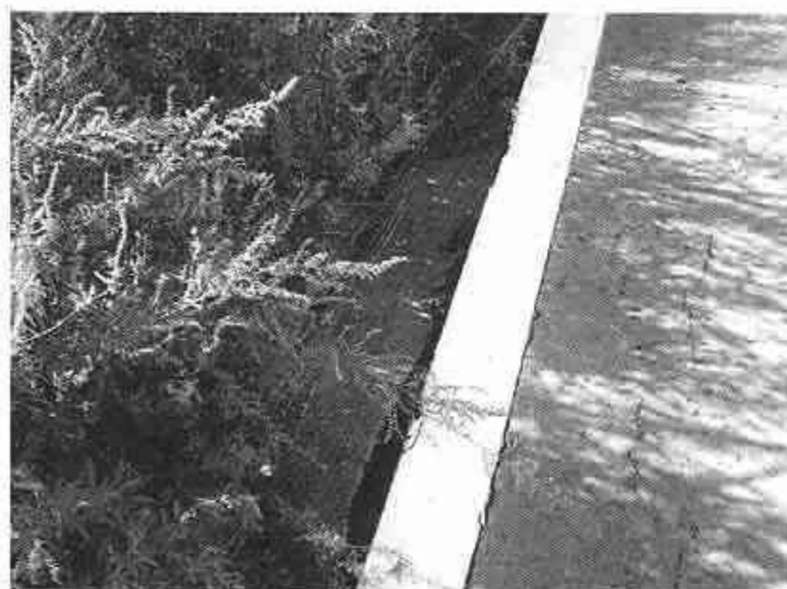
大きく開いた路肩
