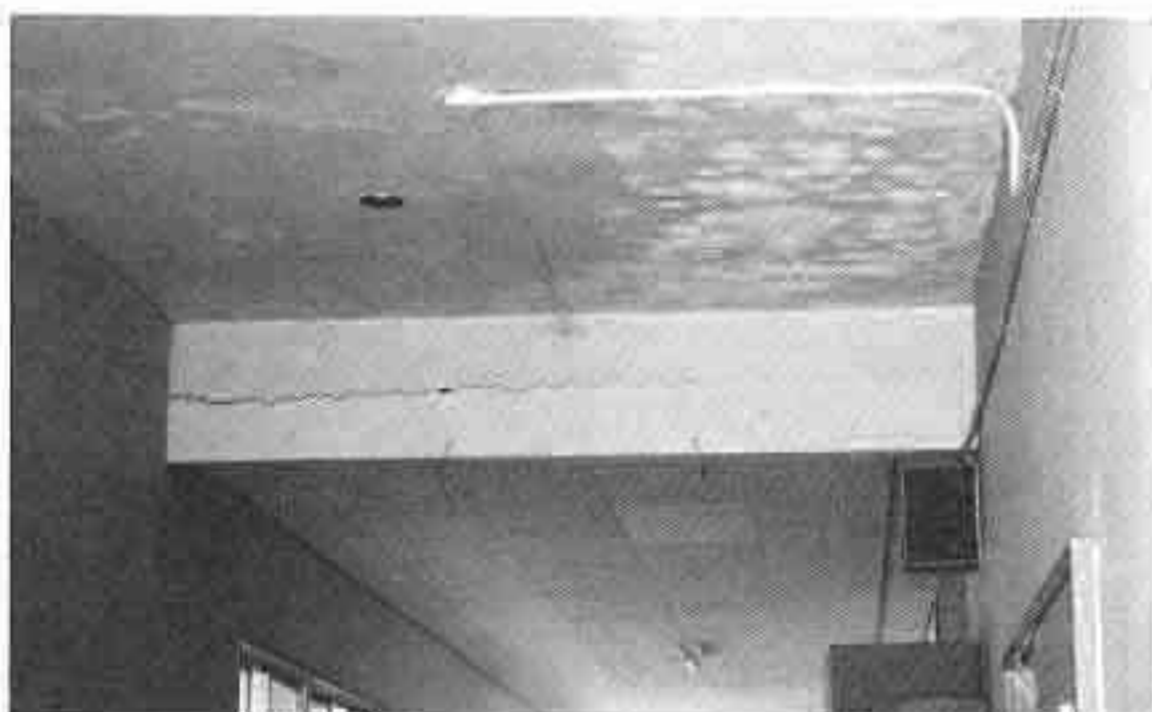
1階購買部前の上はりの亀裂
