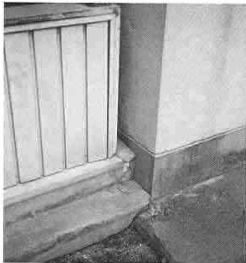
本館～北館渡り廊下のつなぎ目破損
