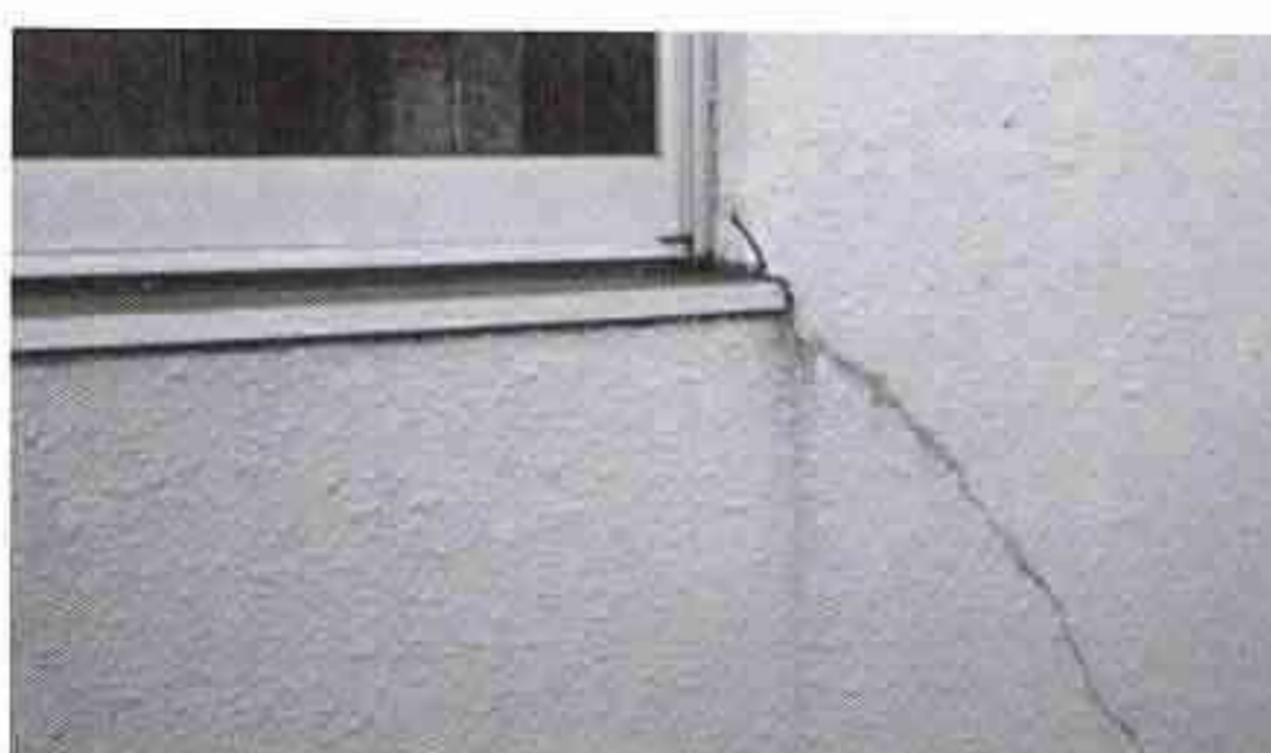
外壁にできた亀裂
