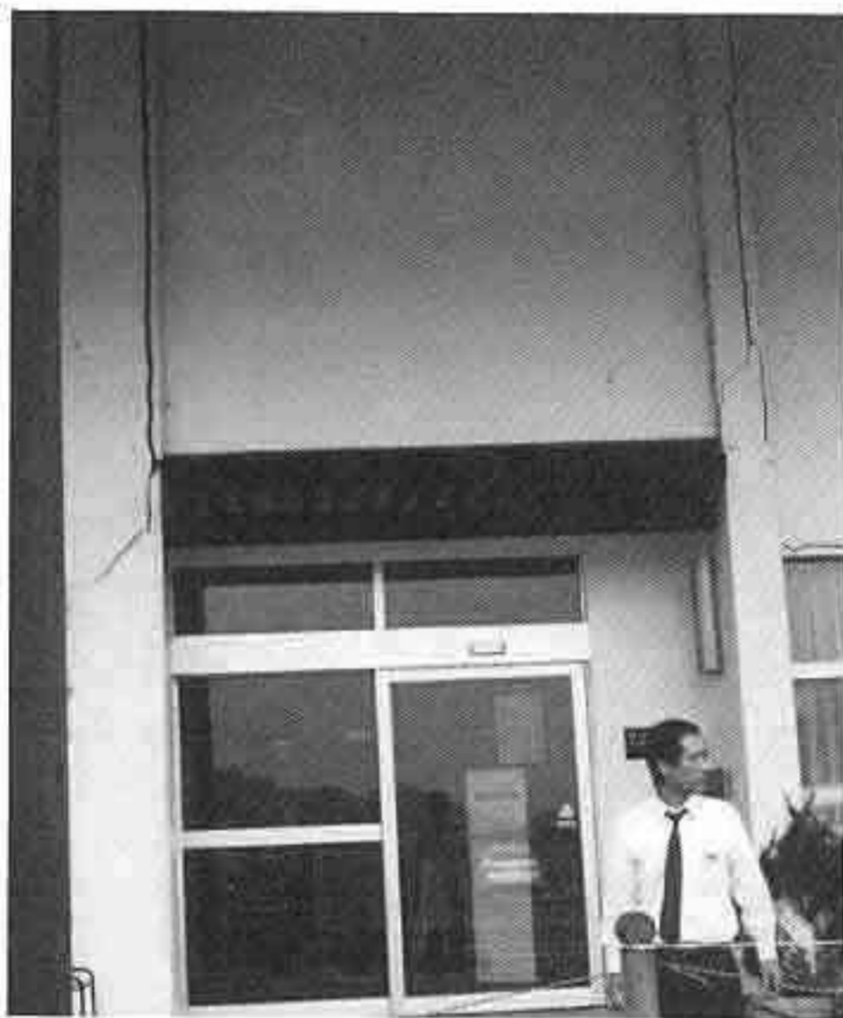
入口横の両柱に亀裂
