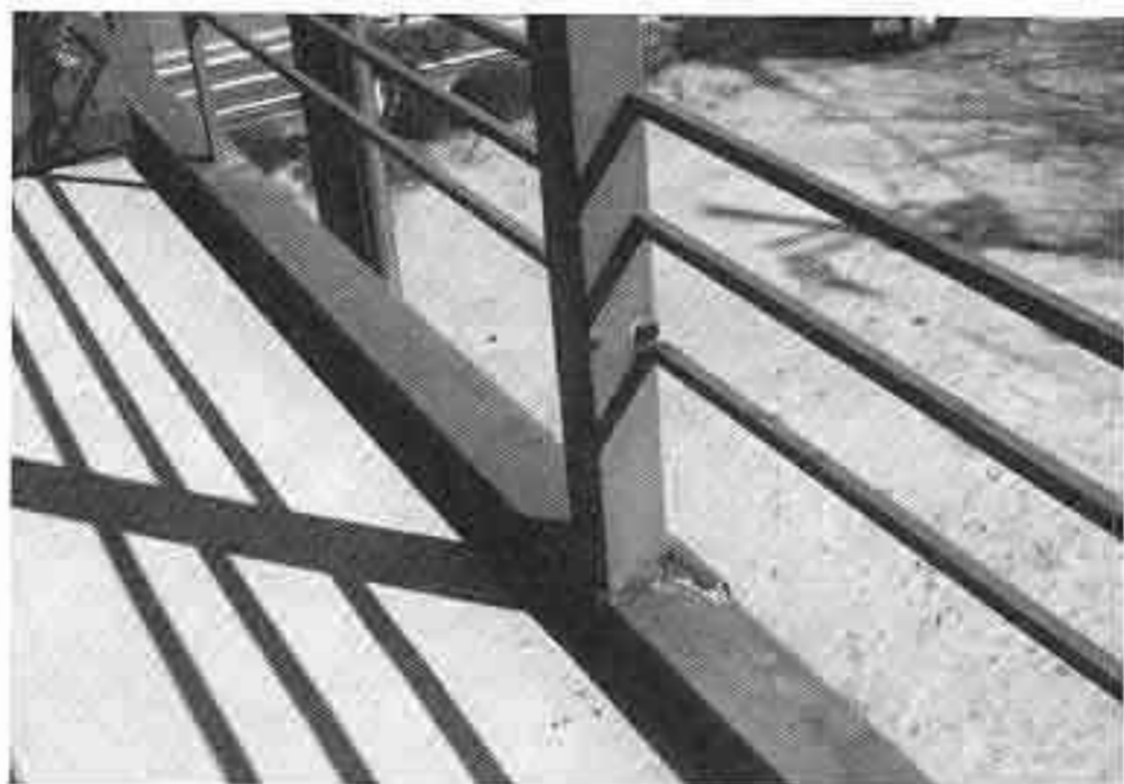
2階テラスの鉄柱が損傷
