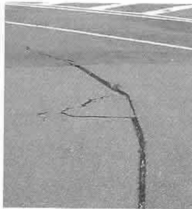
港湾道路内亀裂
