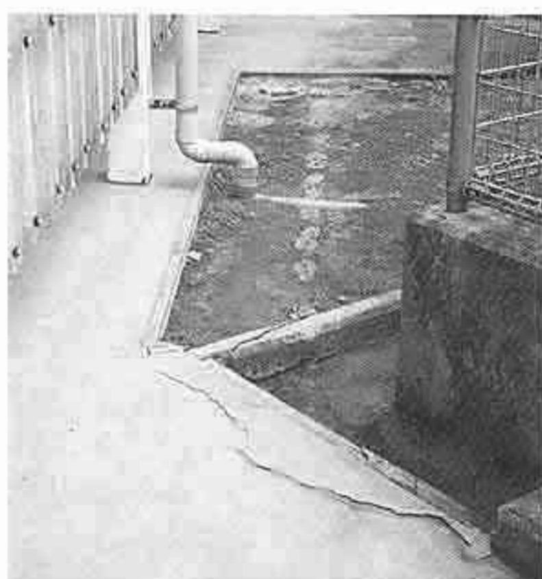
施設内の亀裂
