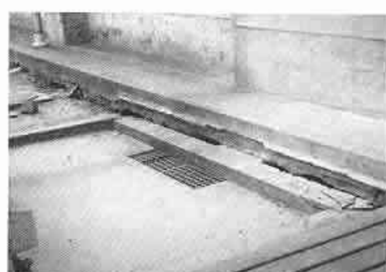
足洗場の損壊と側溝沈下
