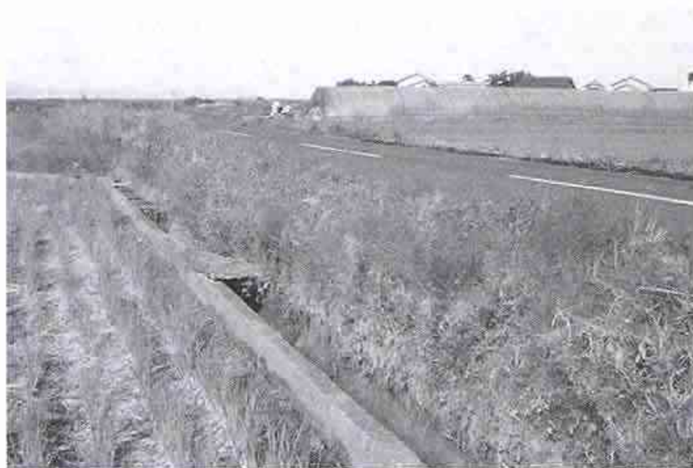
道路側の土面に入ったひび割れ（越前町）
