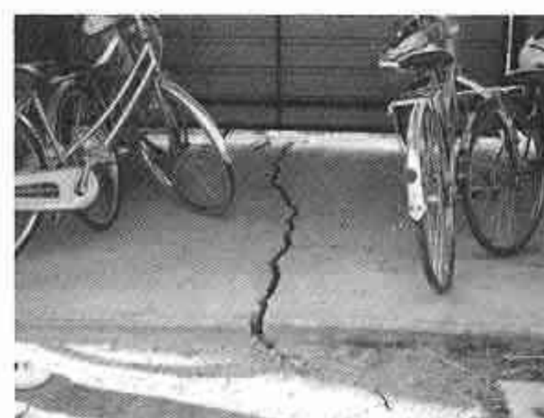
自転車置き場の亀裂
