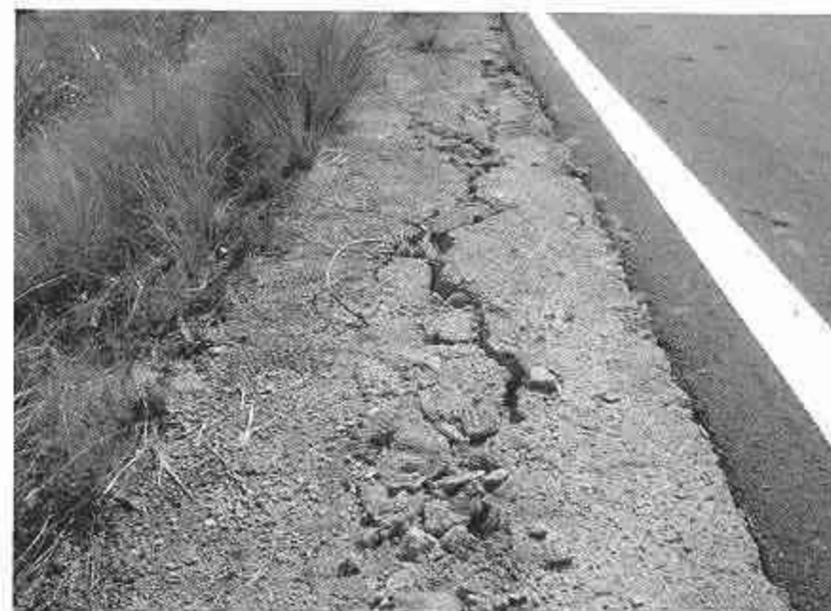
亀裂した路側（門生町）
