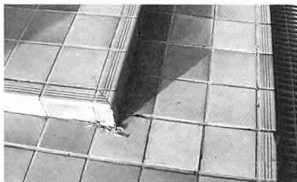
入口階段の破損
