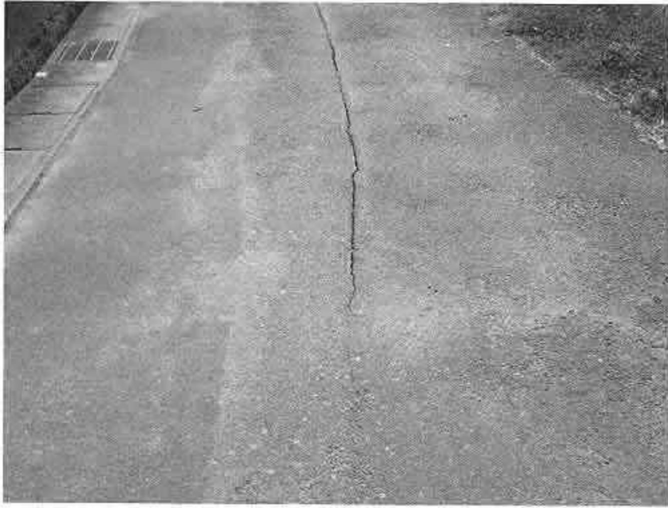
亀裂した道路（吉佐町）
