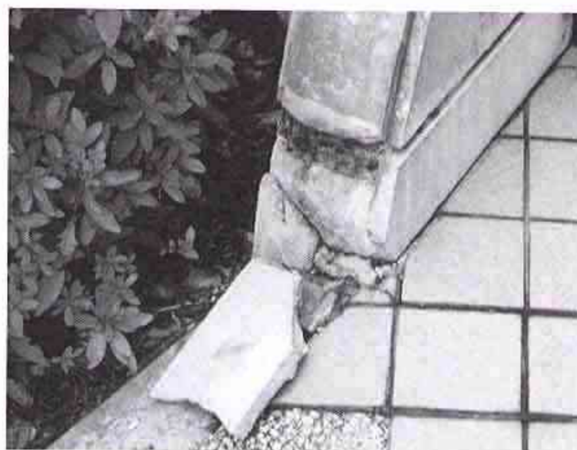
和鋼博物館 基礎部に亀裂が入った
