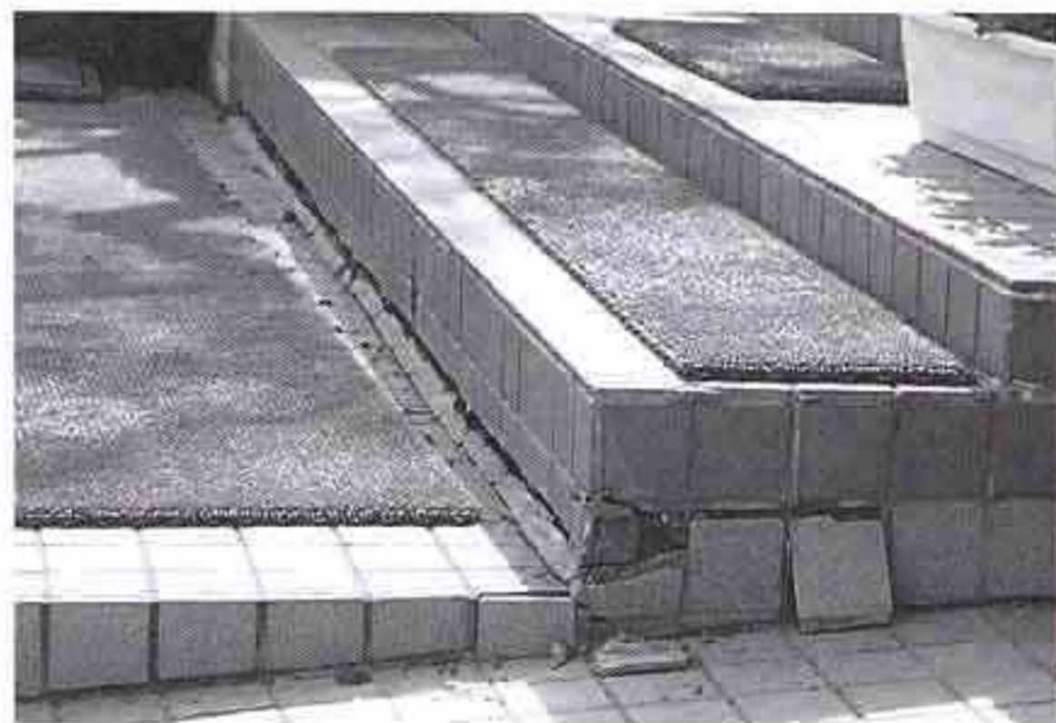
入口階段にできた亀裂
