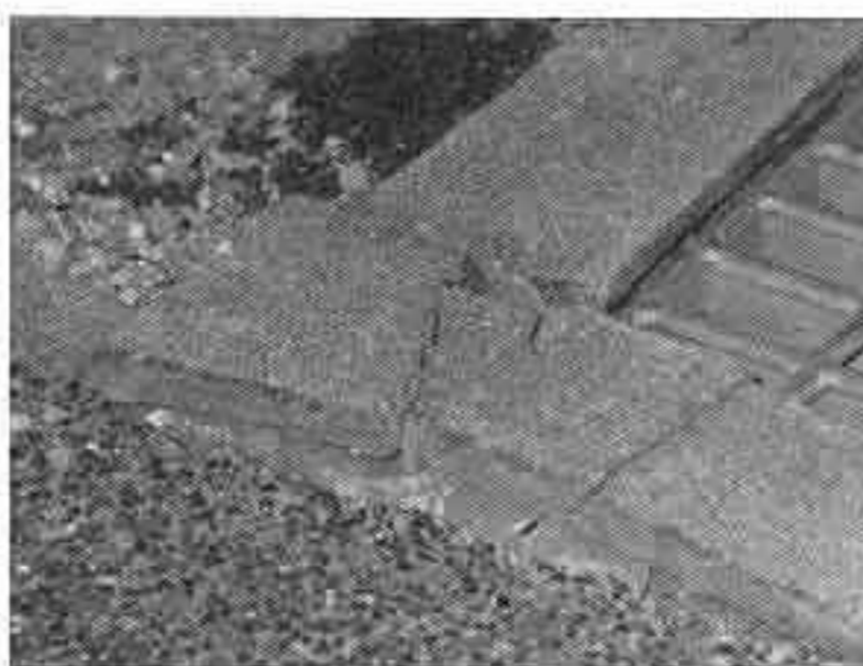
排水口の損傷
