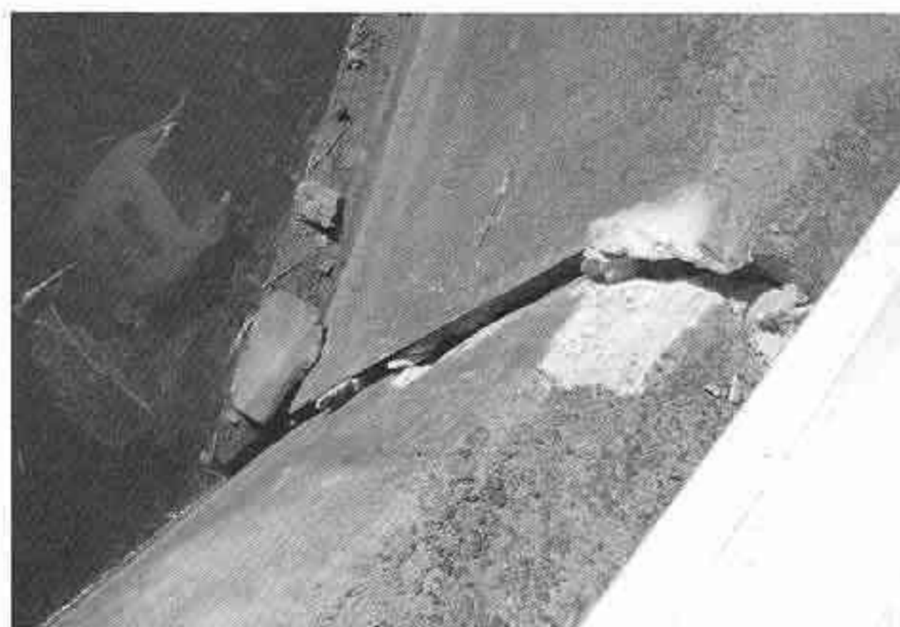
河川護岸に入った亀裂（論田町）
