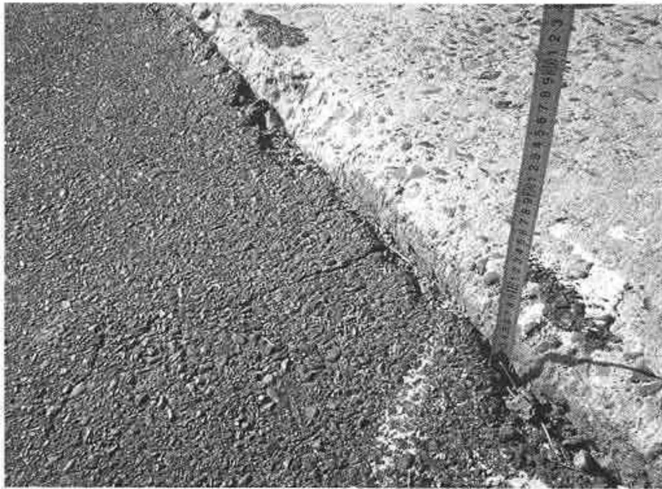
道路の陥没（新坂田町）
