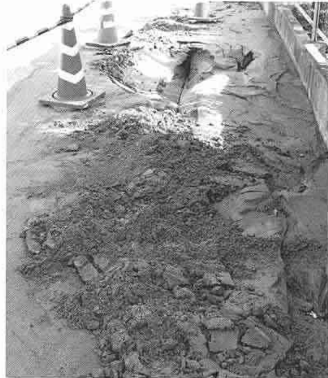
液状化現象による砂の噴出（新十神町）
