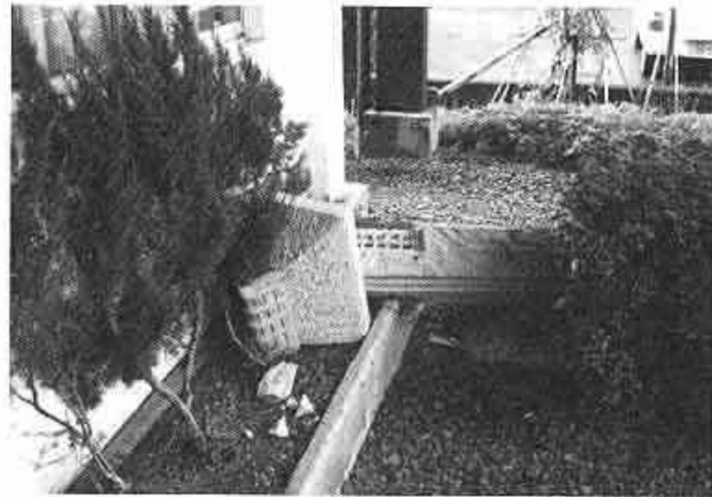
入口の灯籠が倒壊
