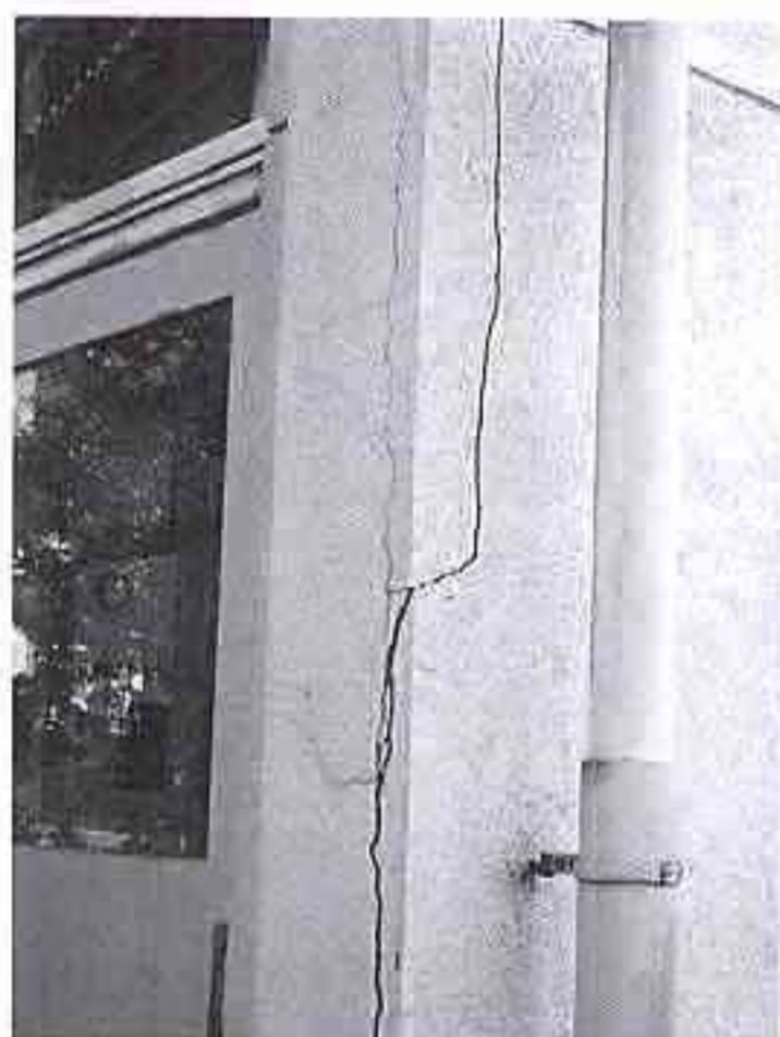
外壁に縦に走った亀裂
