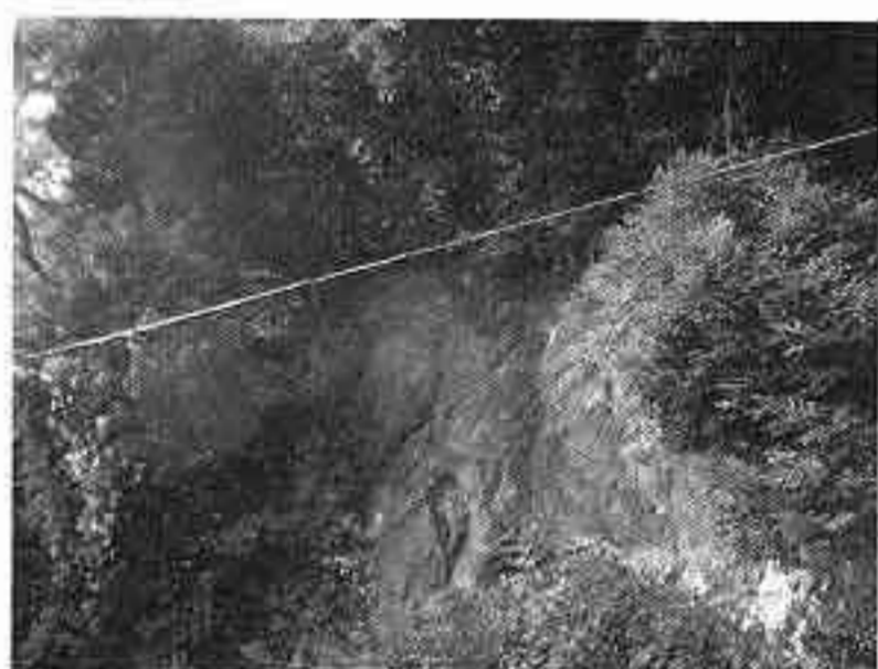
ひび割れが入った崖（宮中川町）
