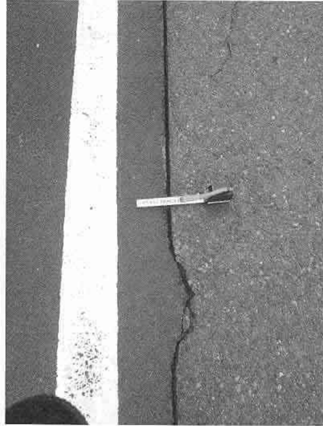
2センチ近くも開いた道路（八幡町）
