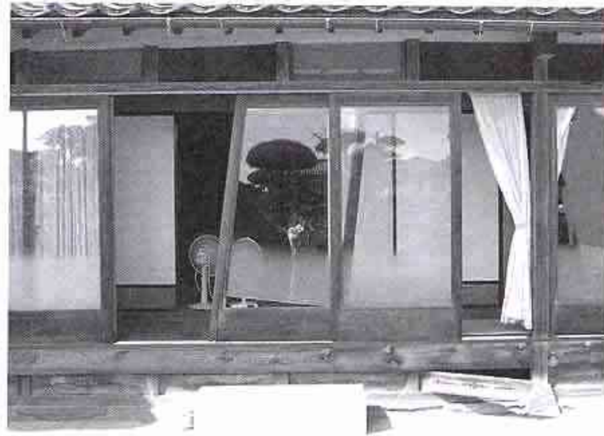
縁側・戸の傾斜（下の原）
