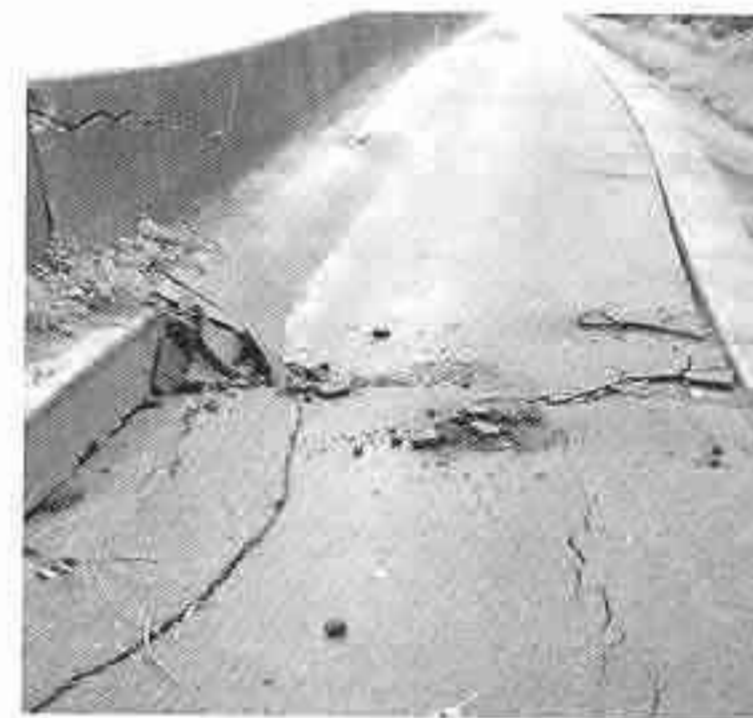
港湾道路の陥没
