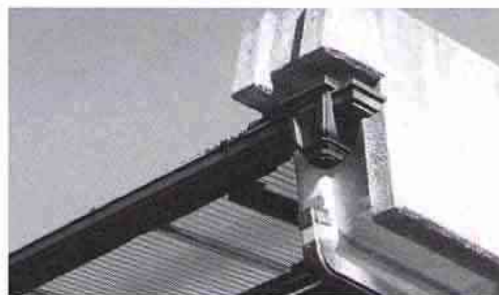
コンクリート壁から外れた雨どい
