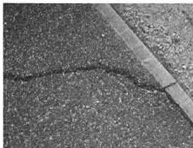
コンクリート床にできた亀裂
