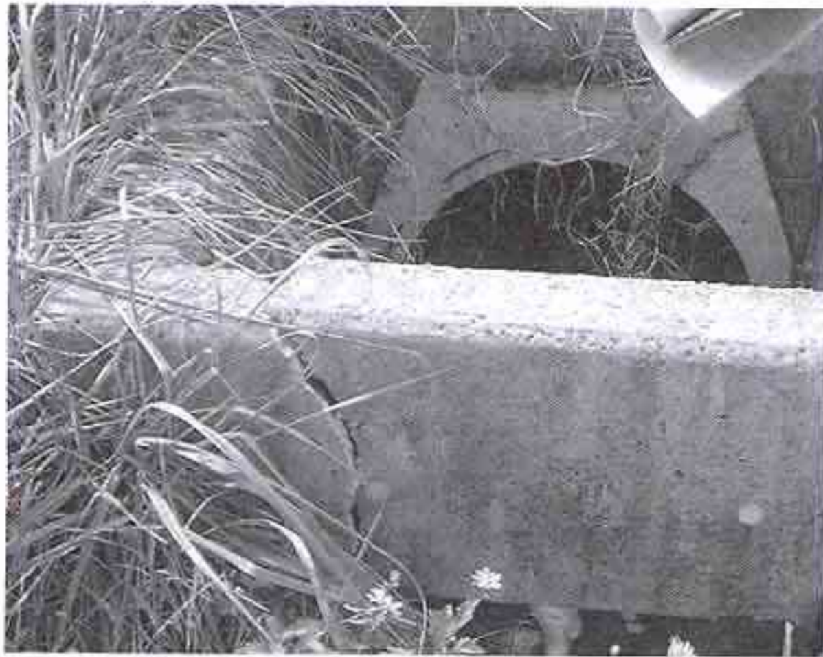
用水路の被害（吉佐町）
