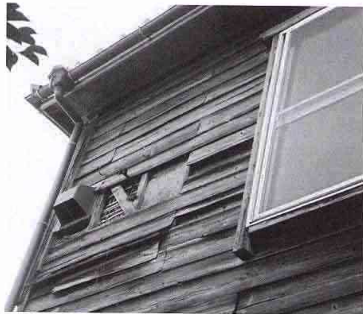
市立民俗資料館 外壁損傷
