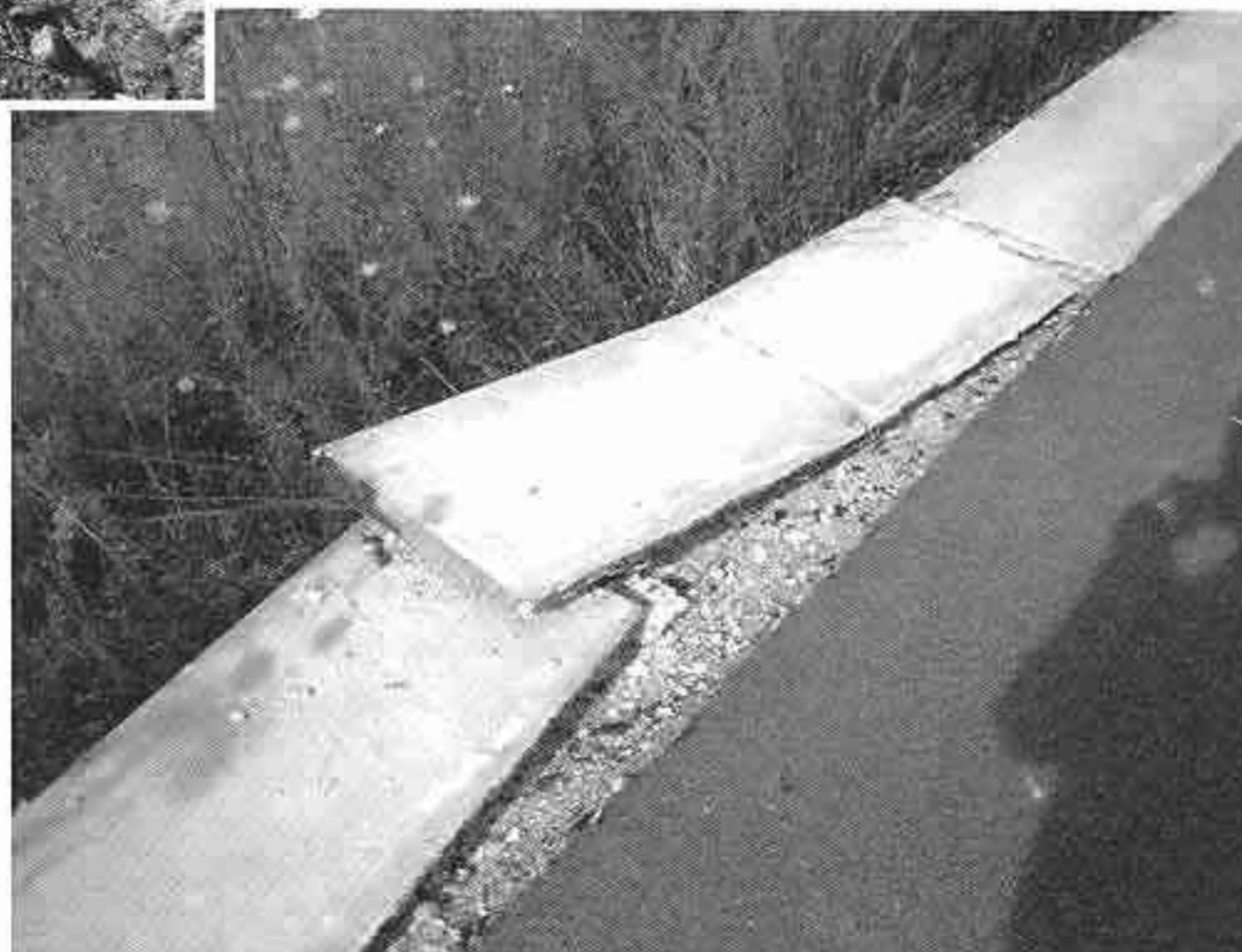
大きくずれた路側帯（利弘町）
