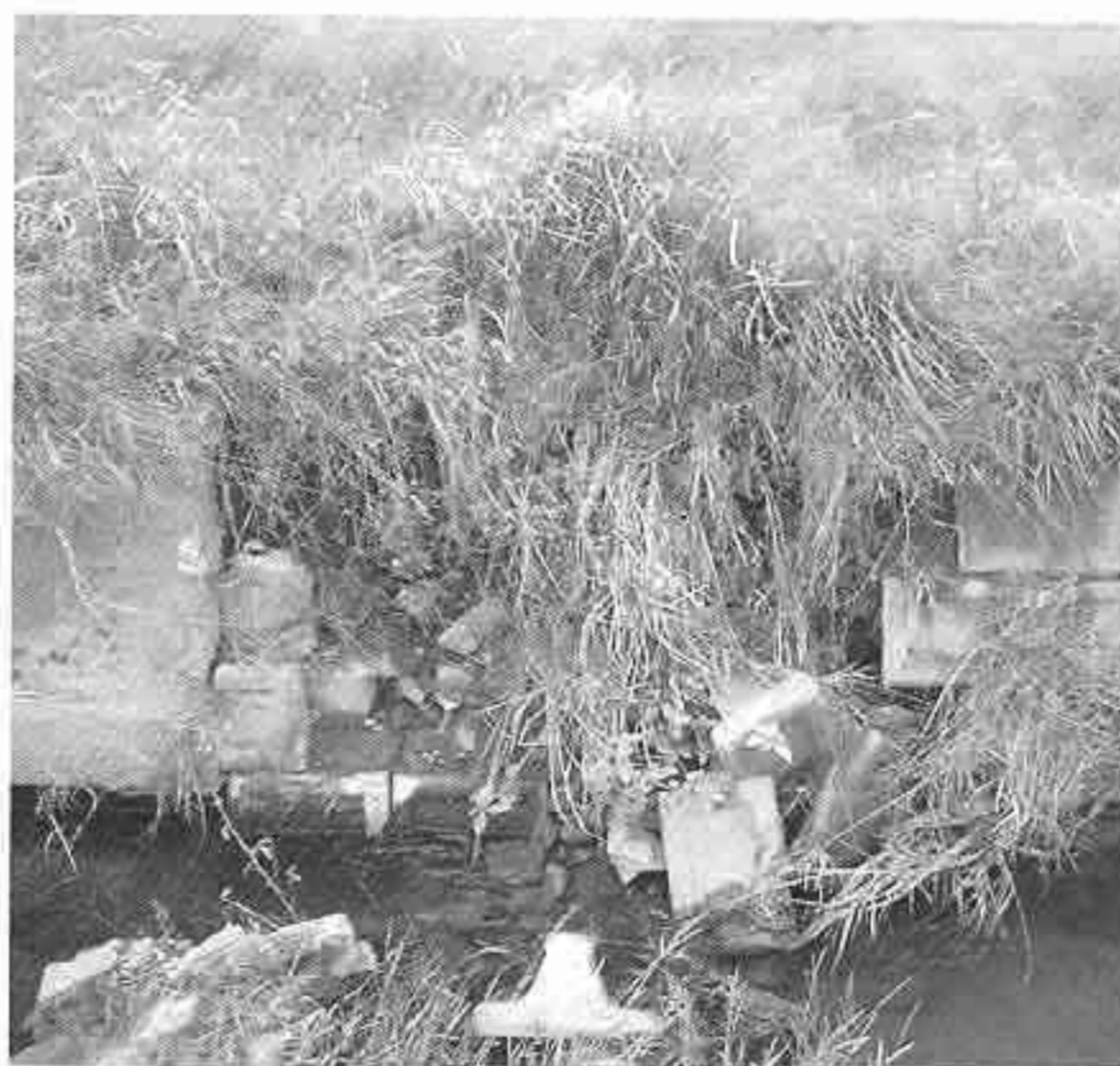
ブロック土手が崩れた松実川護岸
