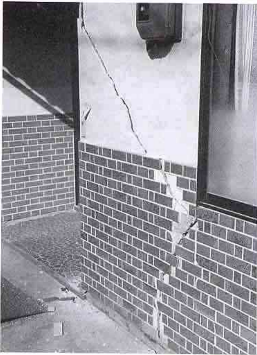
外壁にひび割れが生じた家屋（吉佐町）
