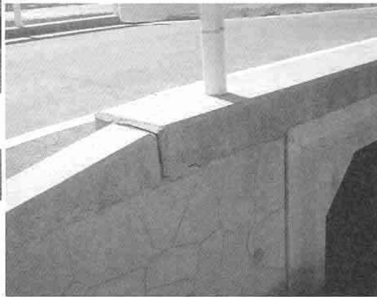
ずれとひび割れができた欄干（論田町）
