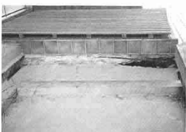
通用口側溝の損壊と沈下
