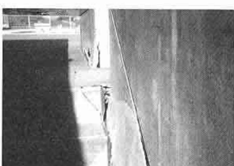
プール階段の損壊
