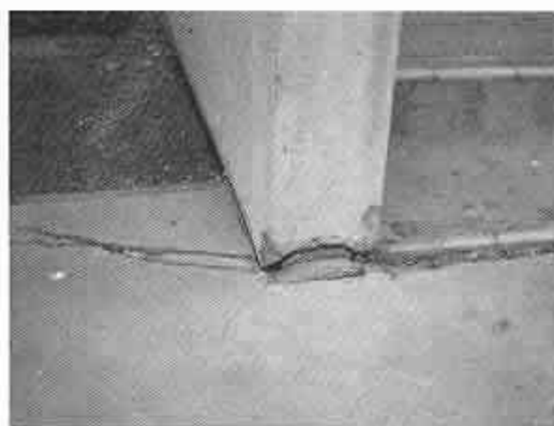
屋内運動場渡り廊下の床面の亀裂
