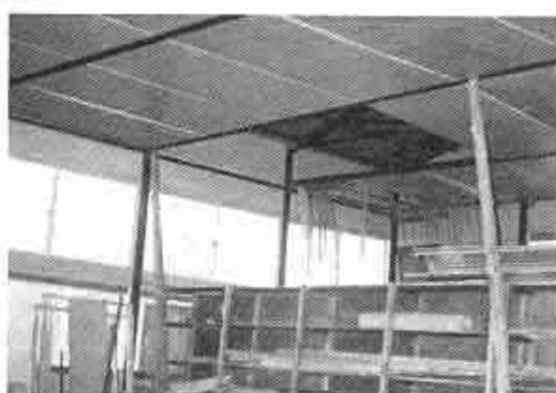
倉庫天井の部分落下
