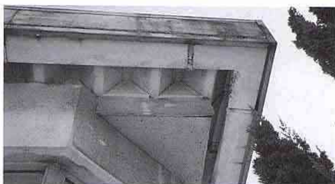
亀裂のできた軒下
