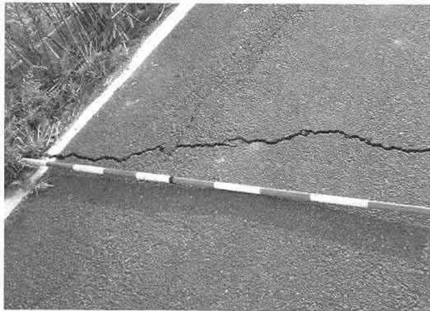
横に入った亀裂（論田町）
