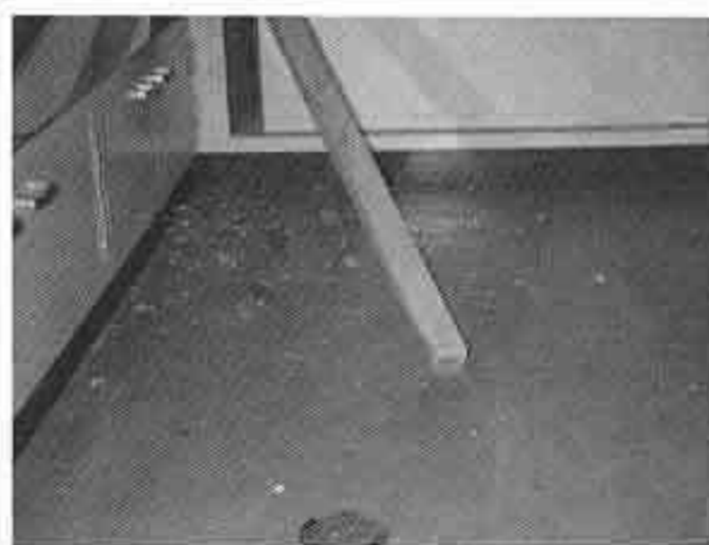
ガラス戸棚の損壊
