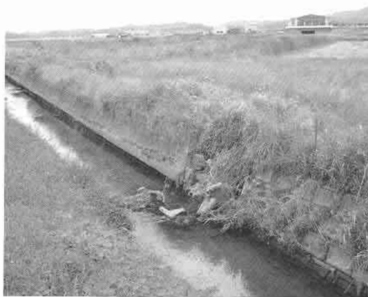
ブロック土手が崩れた松実川護岸
