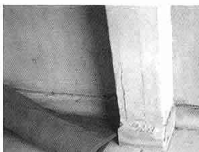
体育館入口付近の亀裂
