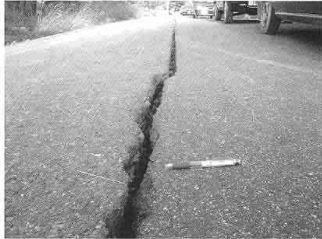
大きく亀裂した市道
