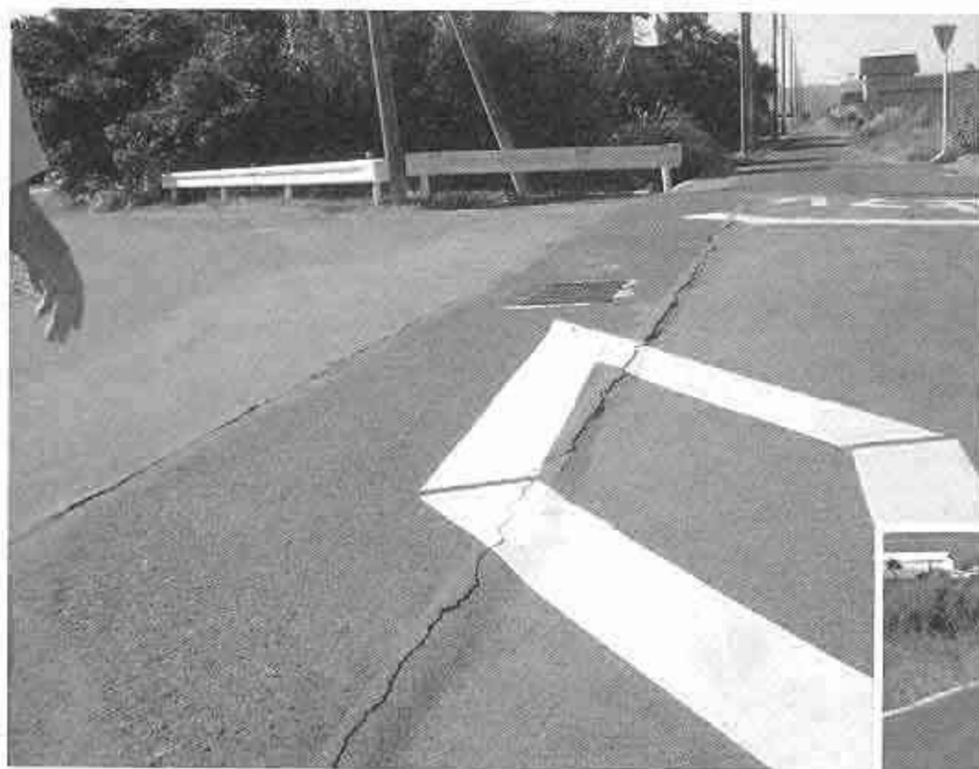
亀裂した道路（論田町）
