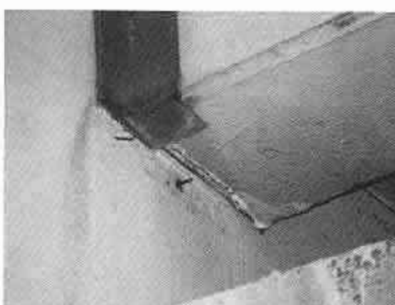
北館～講堂渡り廊下のつなぎ目のずれ
