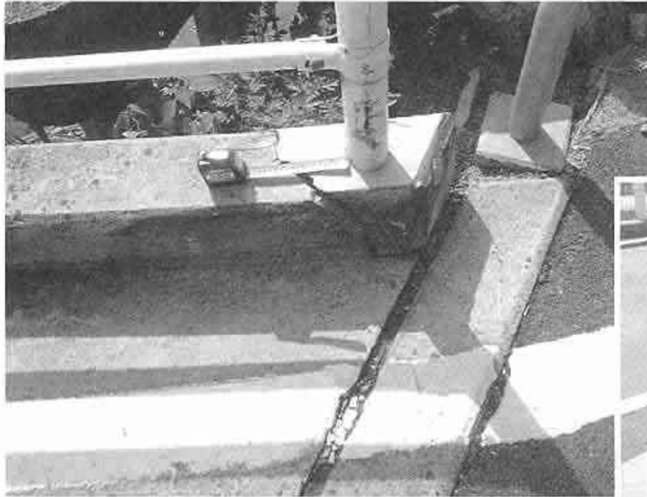
ひび割れした橋の欄干（八幡町）
