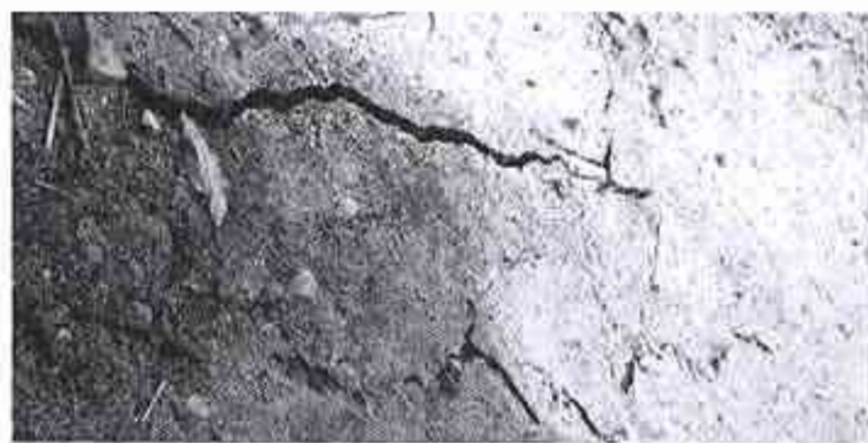
園庭の地割れ
