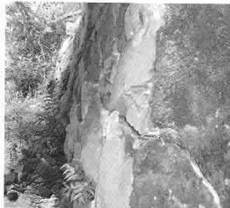
ひび割れの入った石組（吉佐町）
