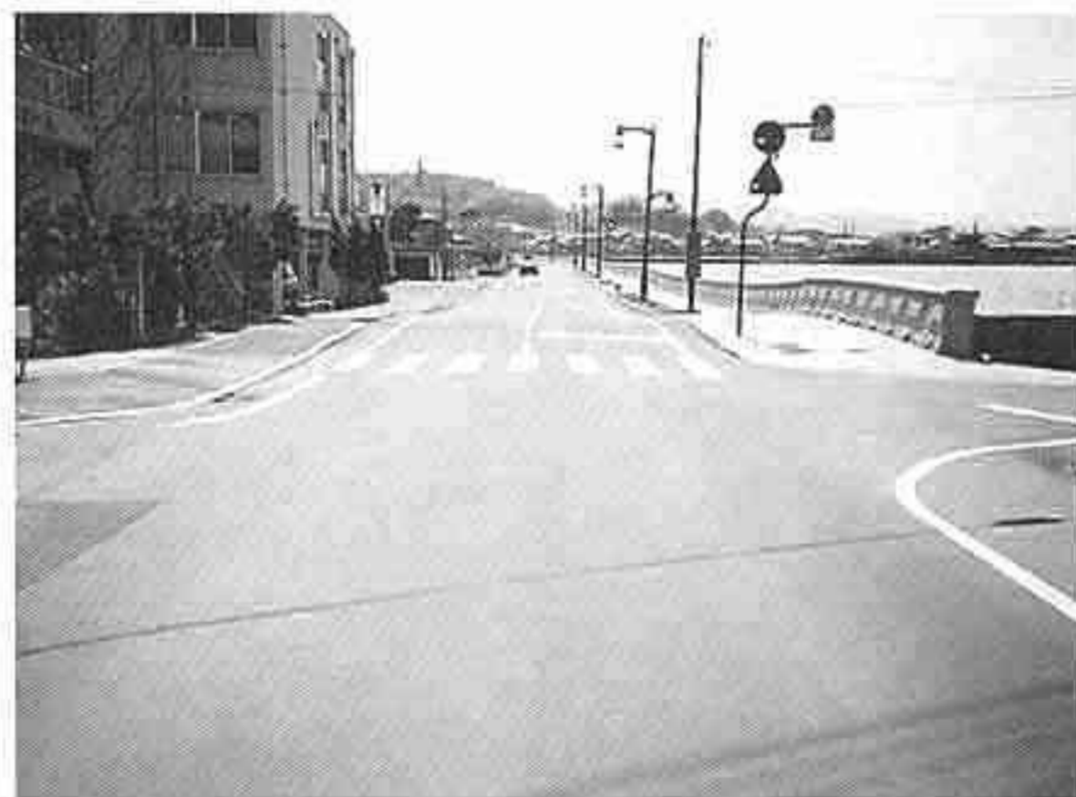
河川道路に入った亀裂（論田町）
