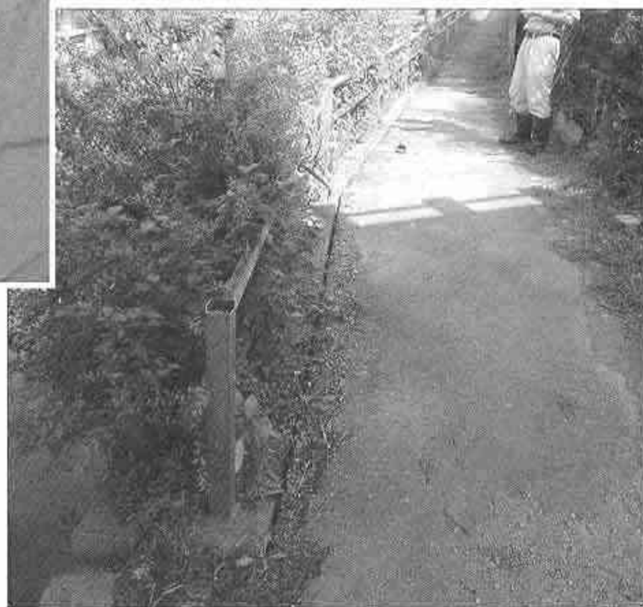
亀裂が入った大橋東（大橋東）
