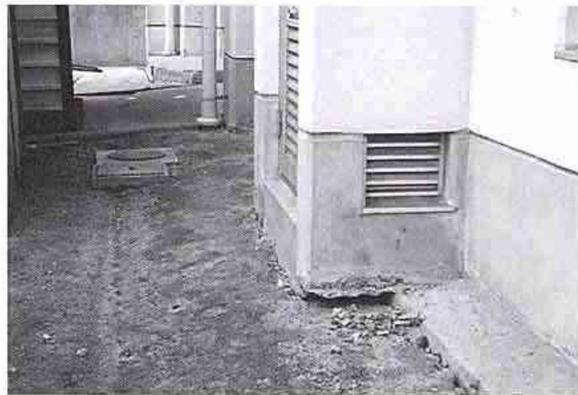
すき間の空いた基礎部分
