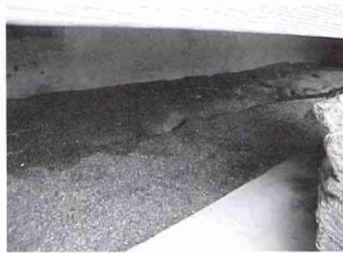
床下に起きた地割れ-2（神塚）
