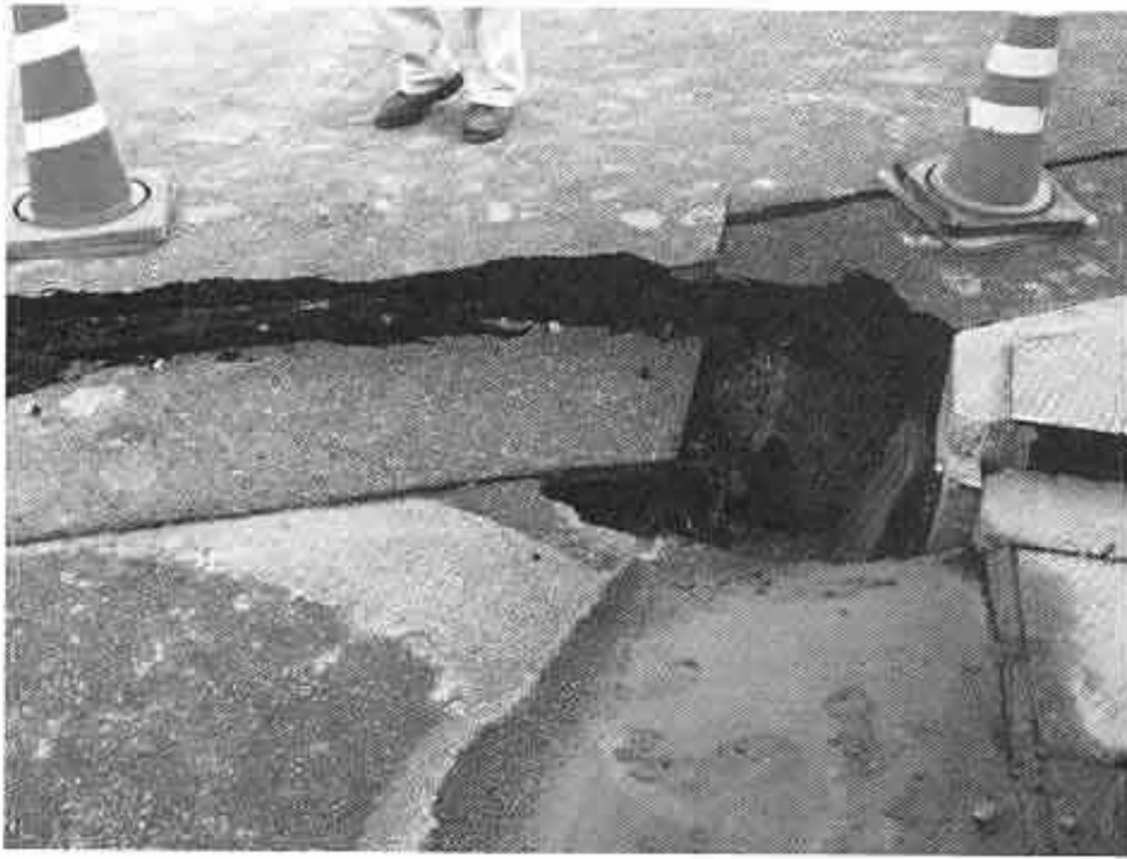
液状化現象による陥没（新十神町）
