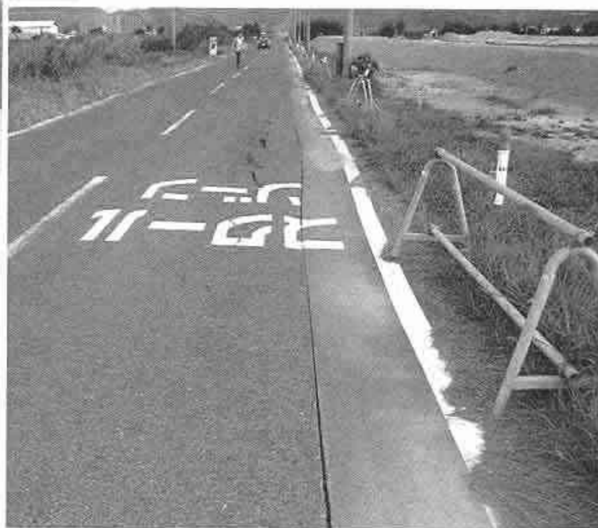
亀裂した道路（島田干拓地）
