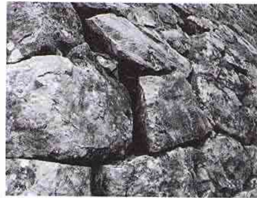
清水寺石垣 石と石との間が開いている
