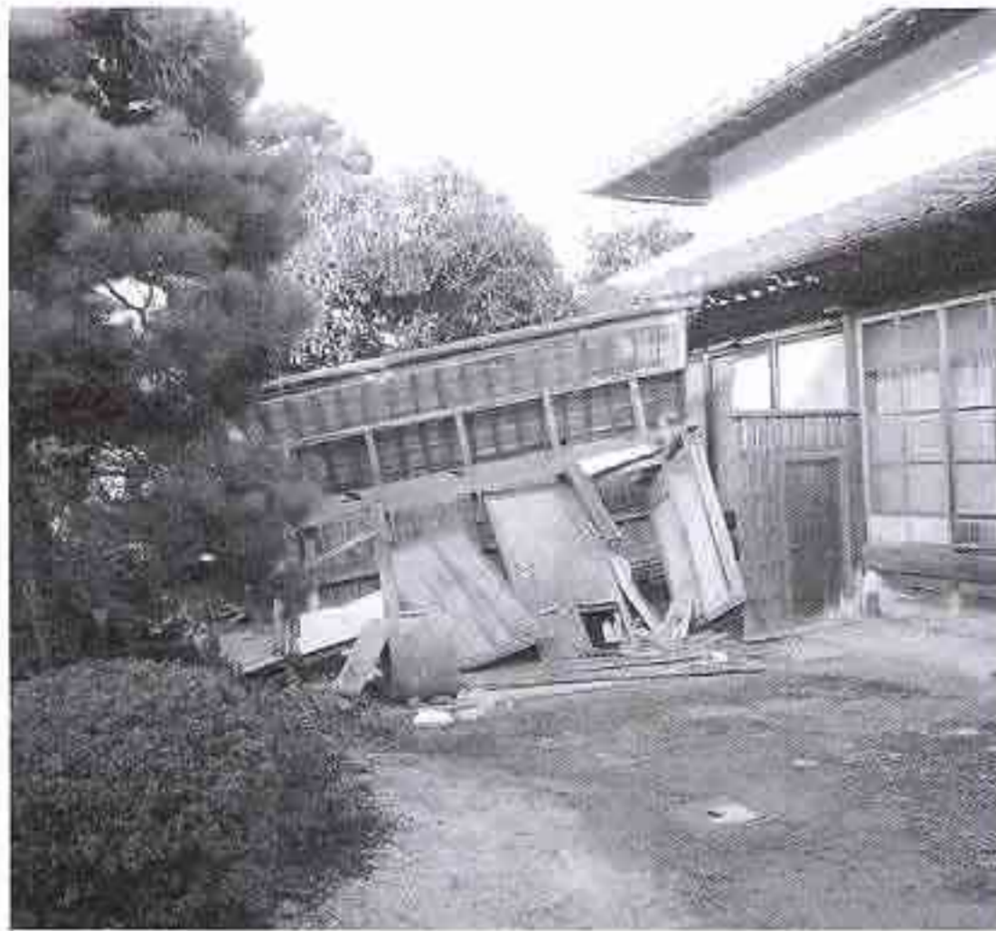
全壊した倉庫
