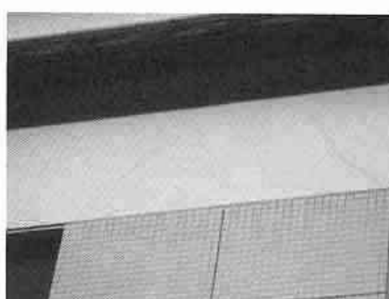
講堂の外壁にできた亀裂
