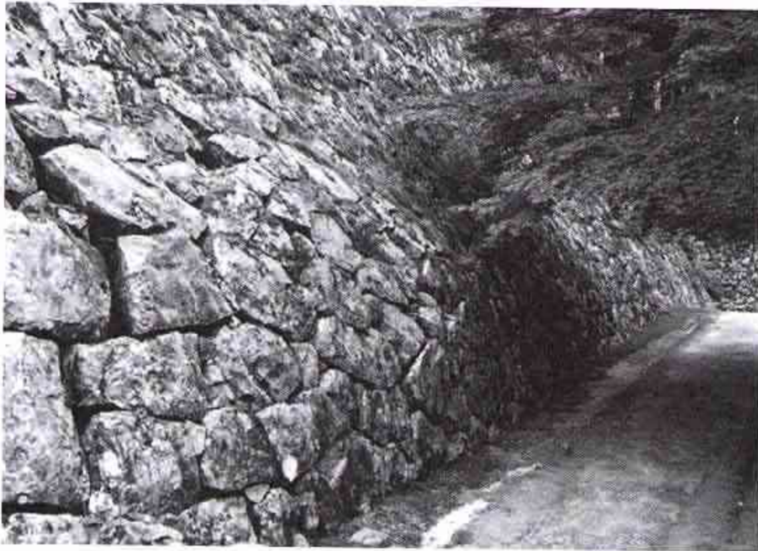
清水寺石垣 下部がふくらみ亀裂が入った
