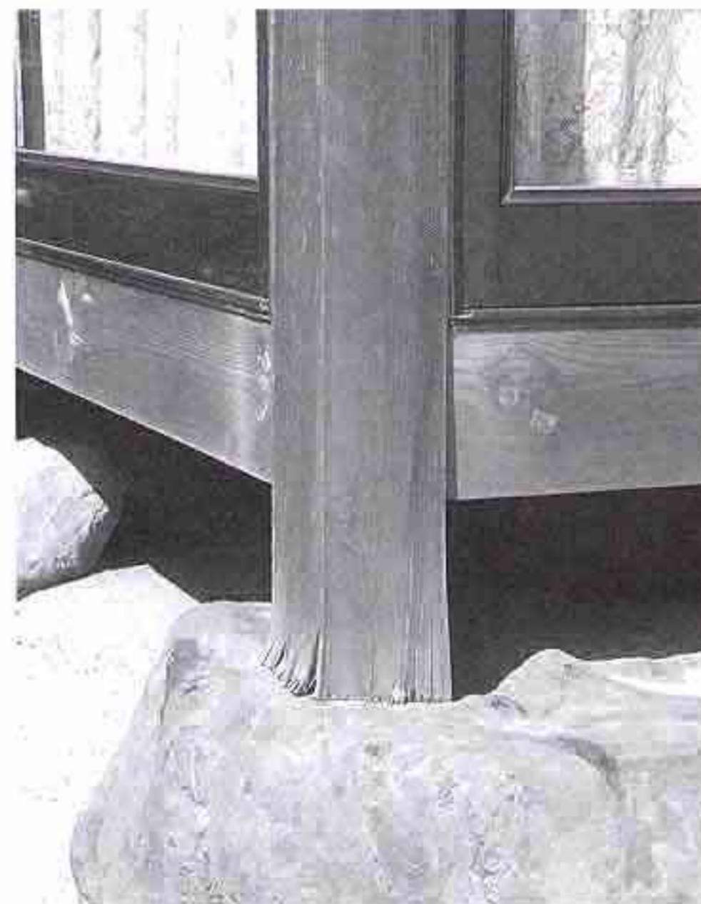
柱の被害（下の原）
