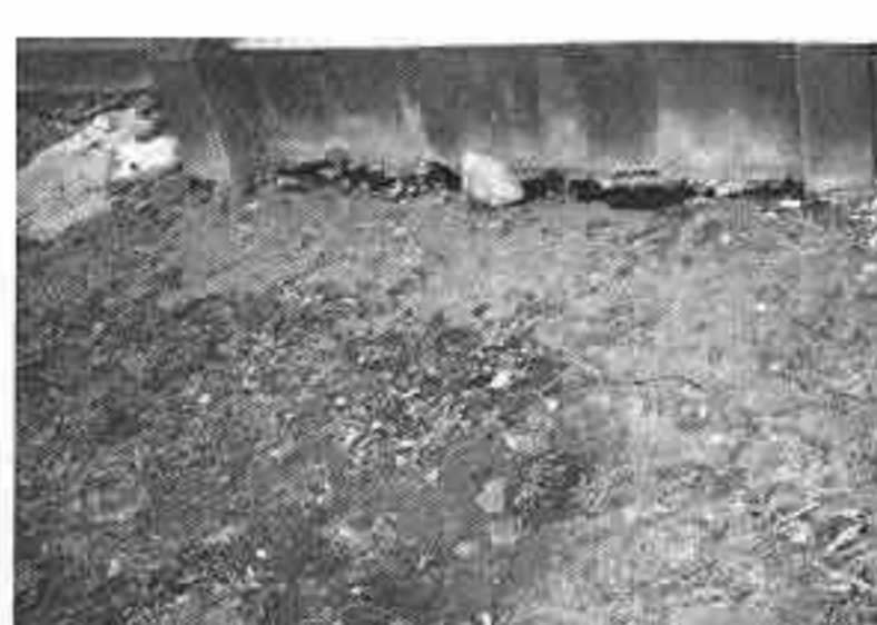
校舎と校庭の間にできた隙間
