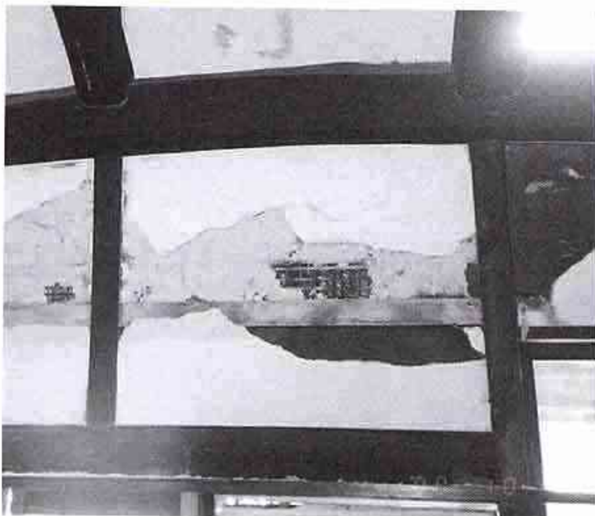
金藤家住宅 内壁破損
