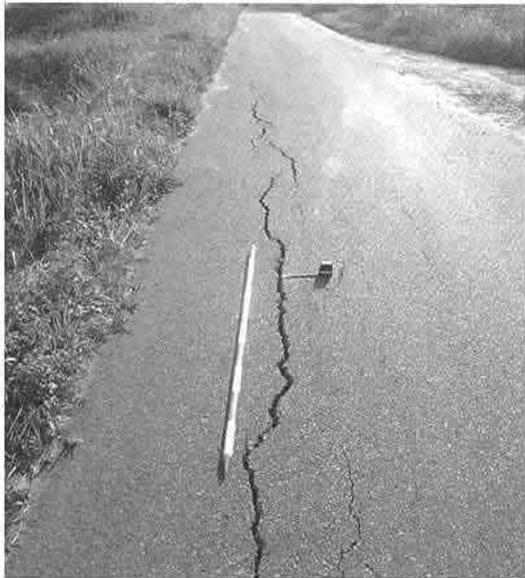
亀裂の続く市道
