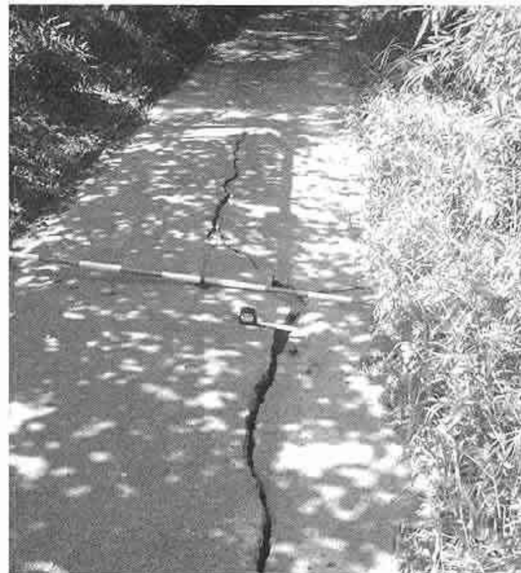
亀裂の入った山道
