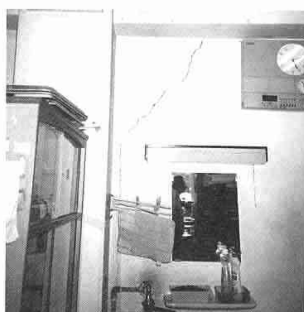
湯沸室にできた亀裂
