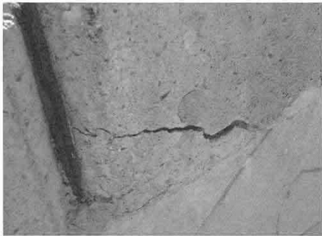
ずれとひび割れができた欄干（論田町）
