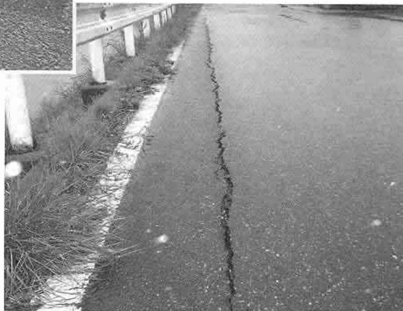
亀裂した道路（八幡町）
