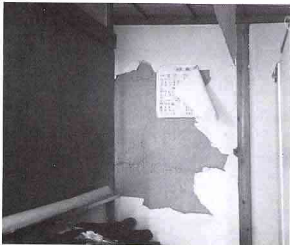
市立民俗資料館 内壁損傷とクラック
