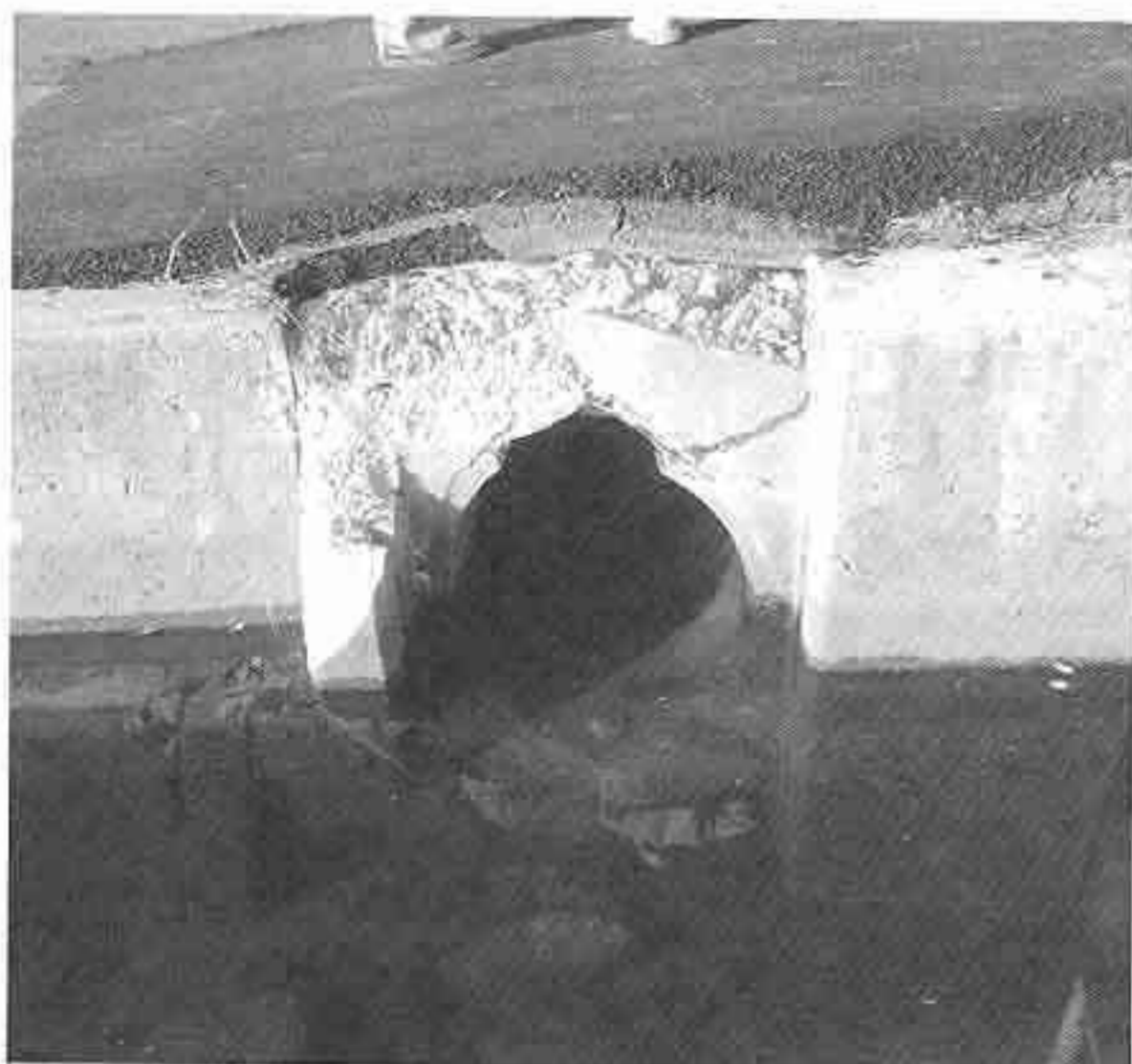
排水口の破損（東赤江町）
