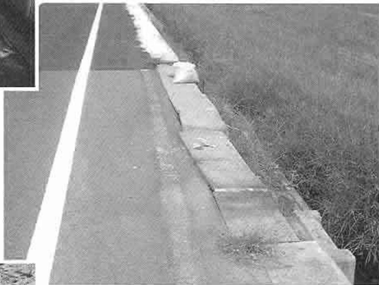
路側帯が陥没した農道（利弘町）
