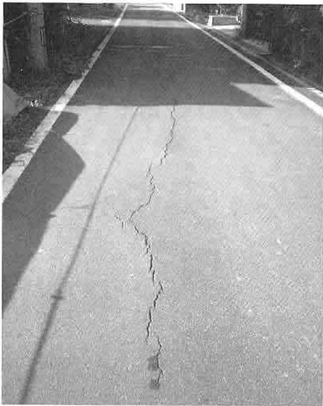
亀裂した市道
