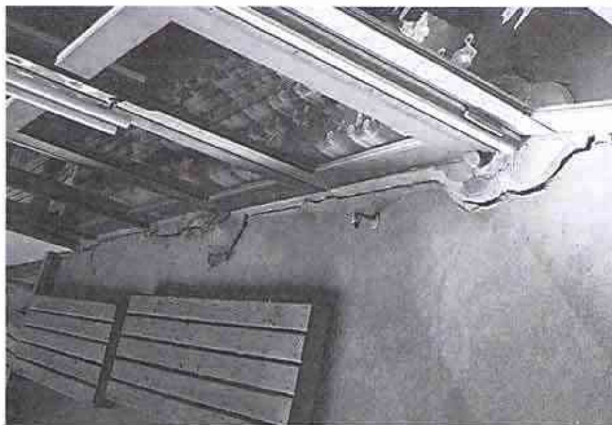
コンクリート床面の亀裂
