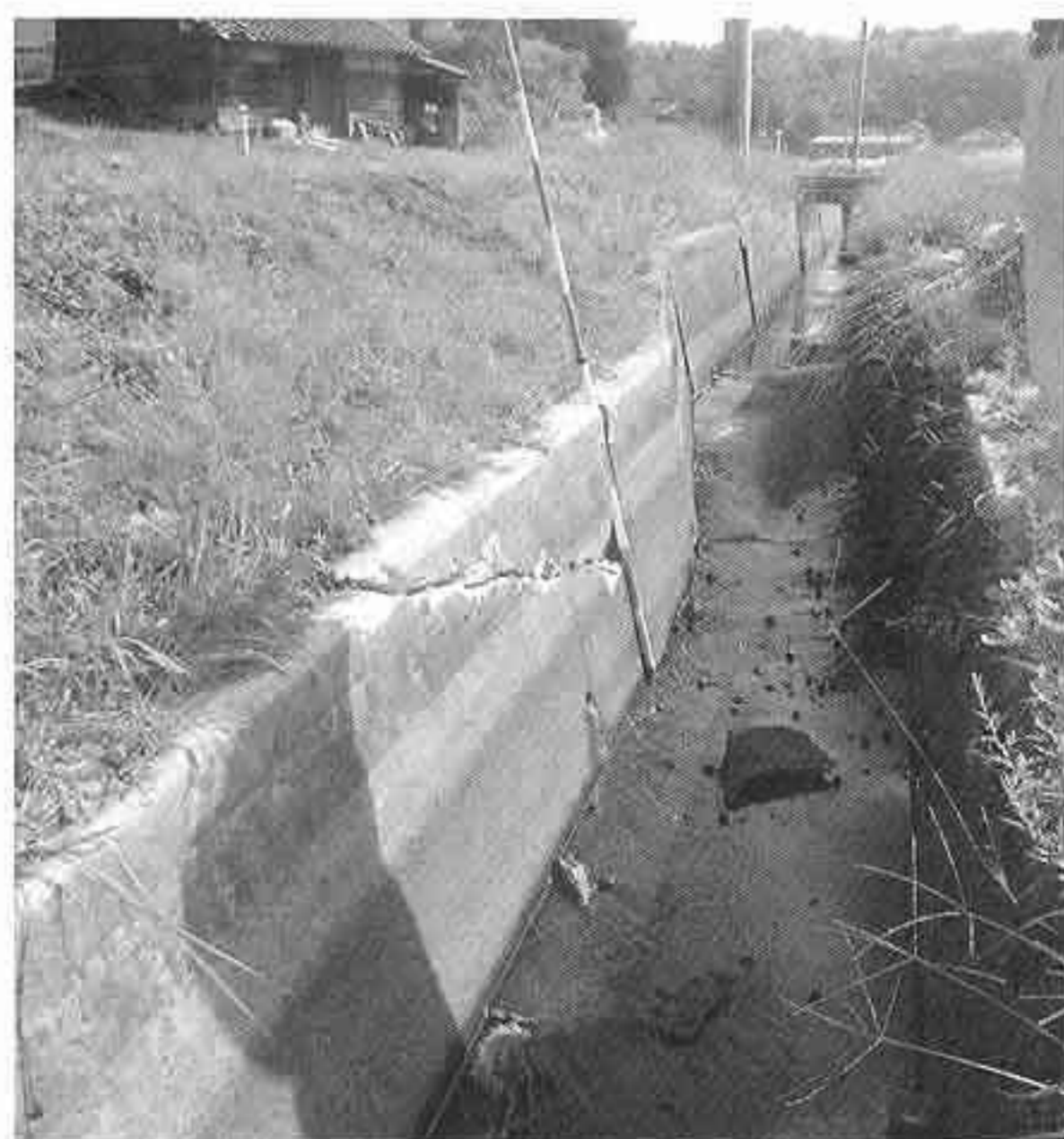
護岸壁に斜めに入った亀裂
