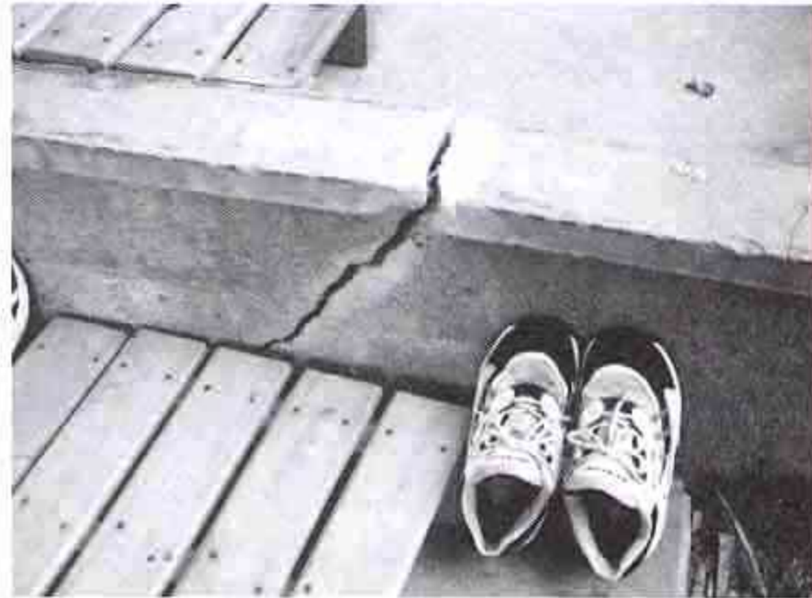
足洗場の枠にできた亀裂
