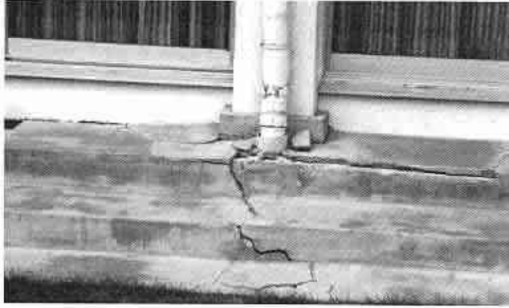
排水ポンプの損壊と階段部の亀裂
