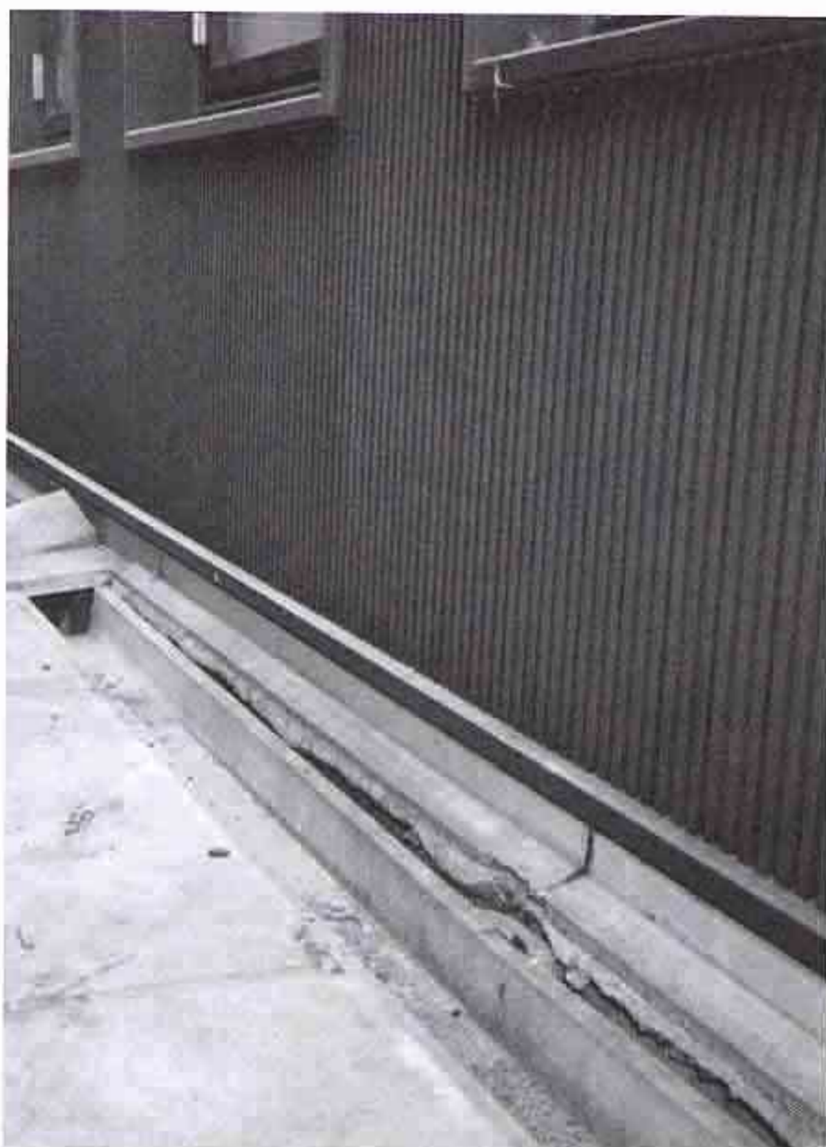
和鋼博物館 通路の沈下・浮上
