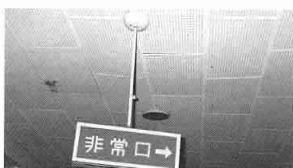
天井板にたるみが発生
