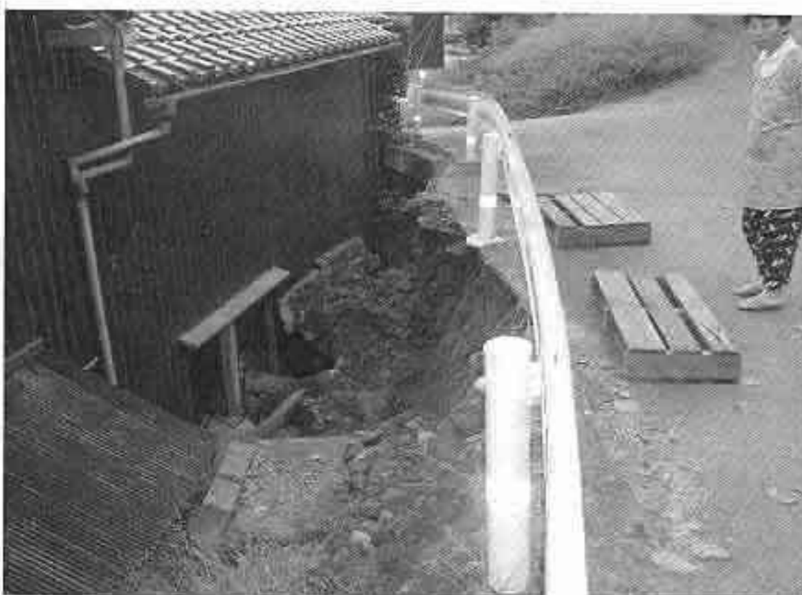
路側の土壁が崩れた道路（吉佐町）
