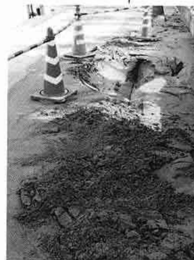
新十神町 町内市道一部が液状化現象
