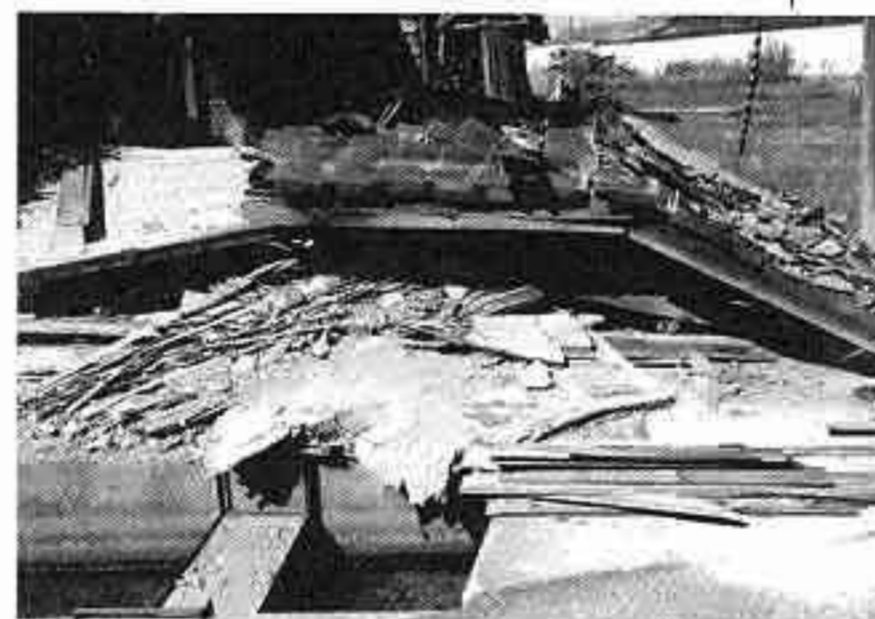
切川町 家屋被害状況
