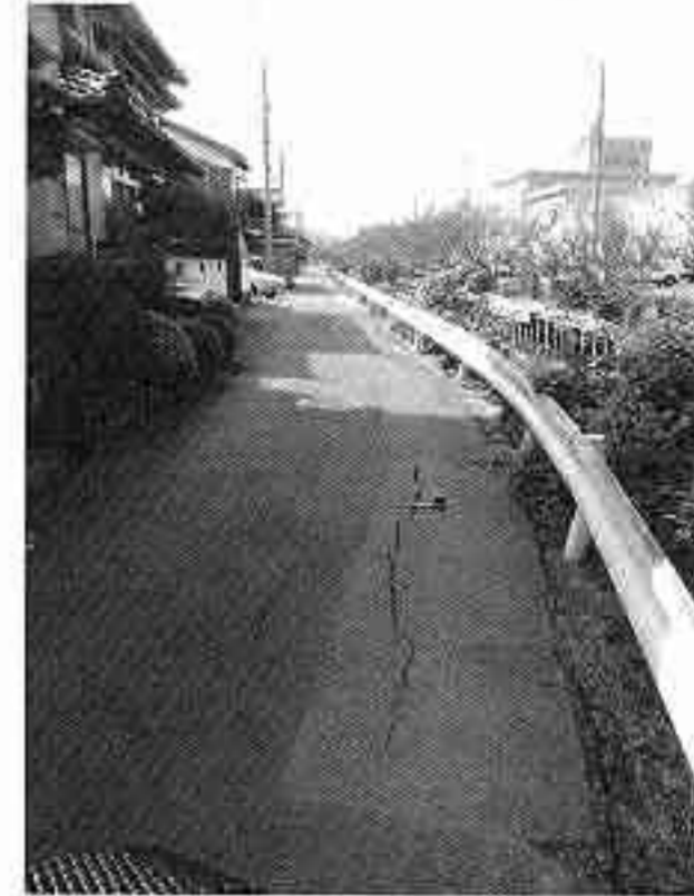
八幡町 道路被害状況
