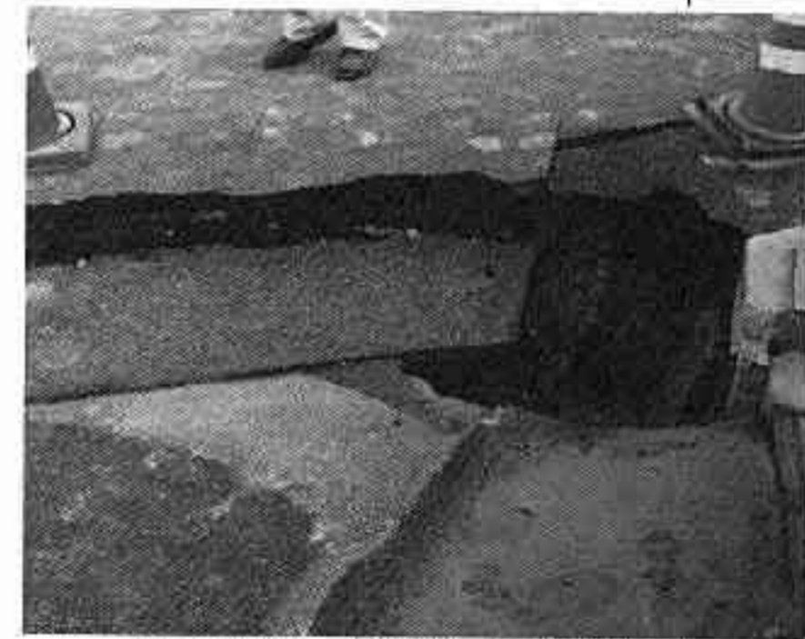
新十神町 液状化陥没箇所
