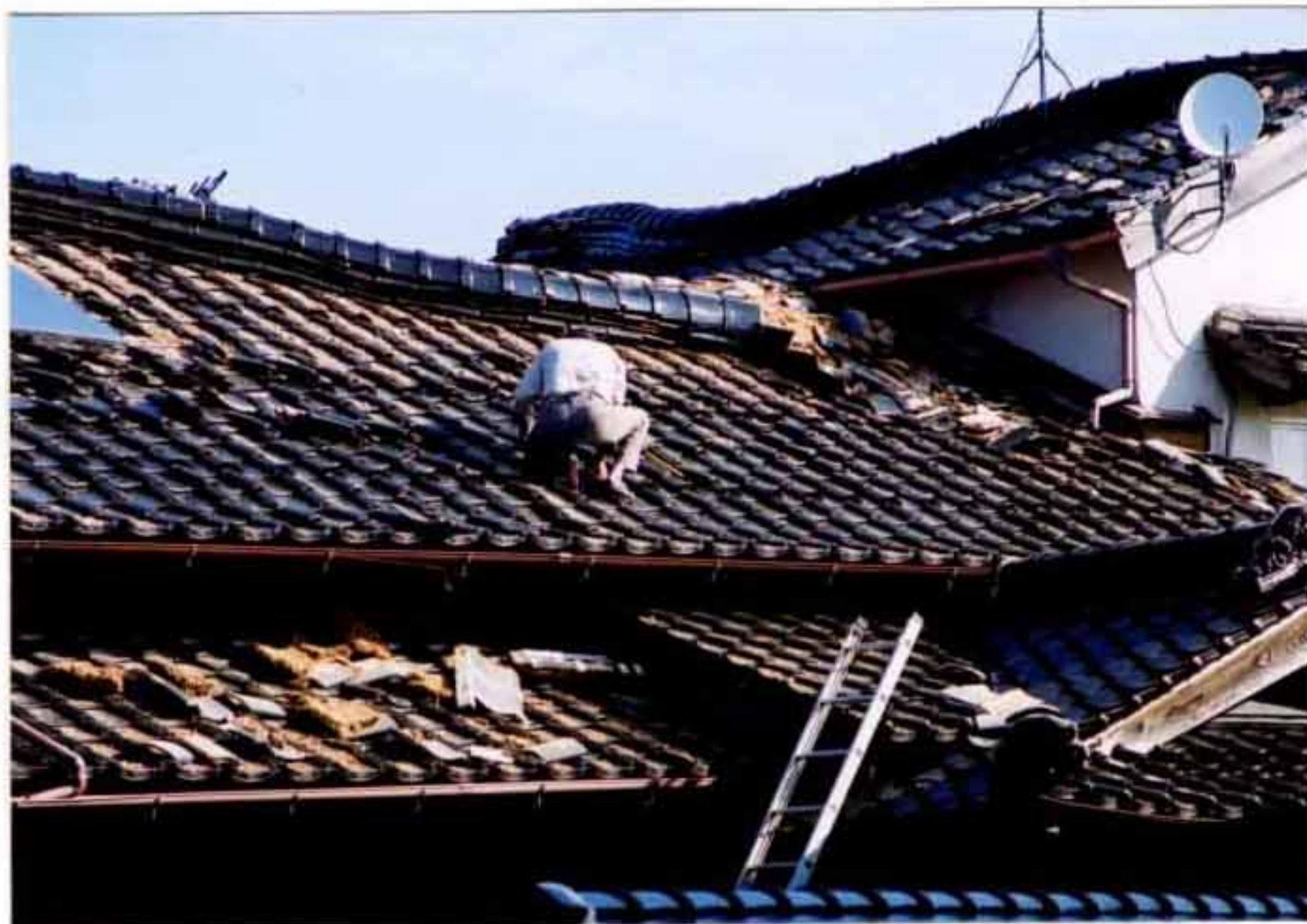
同上 屋根損壊状況
