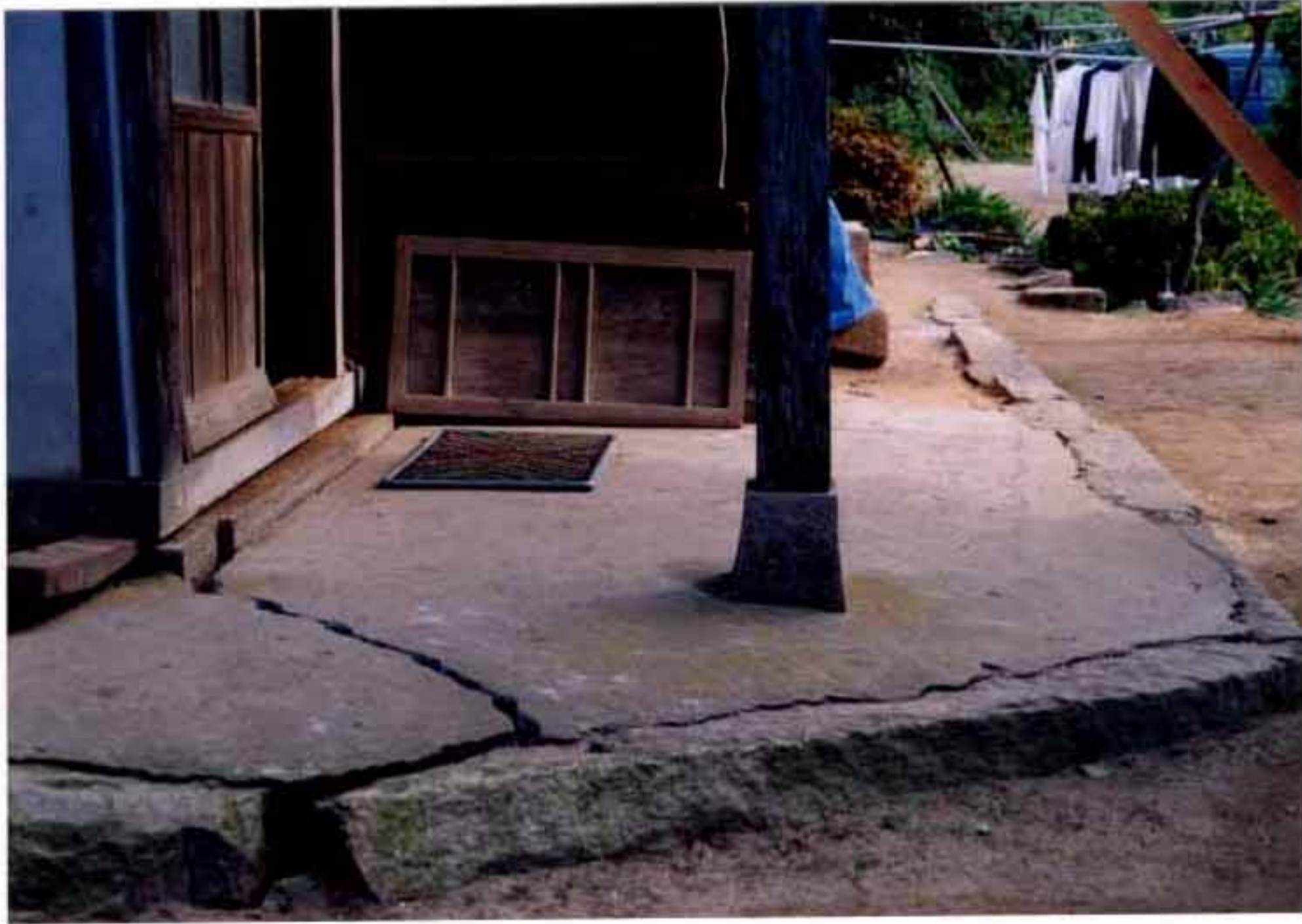
伯太町須山 母屋下を縦断する地割れ
