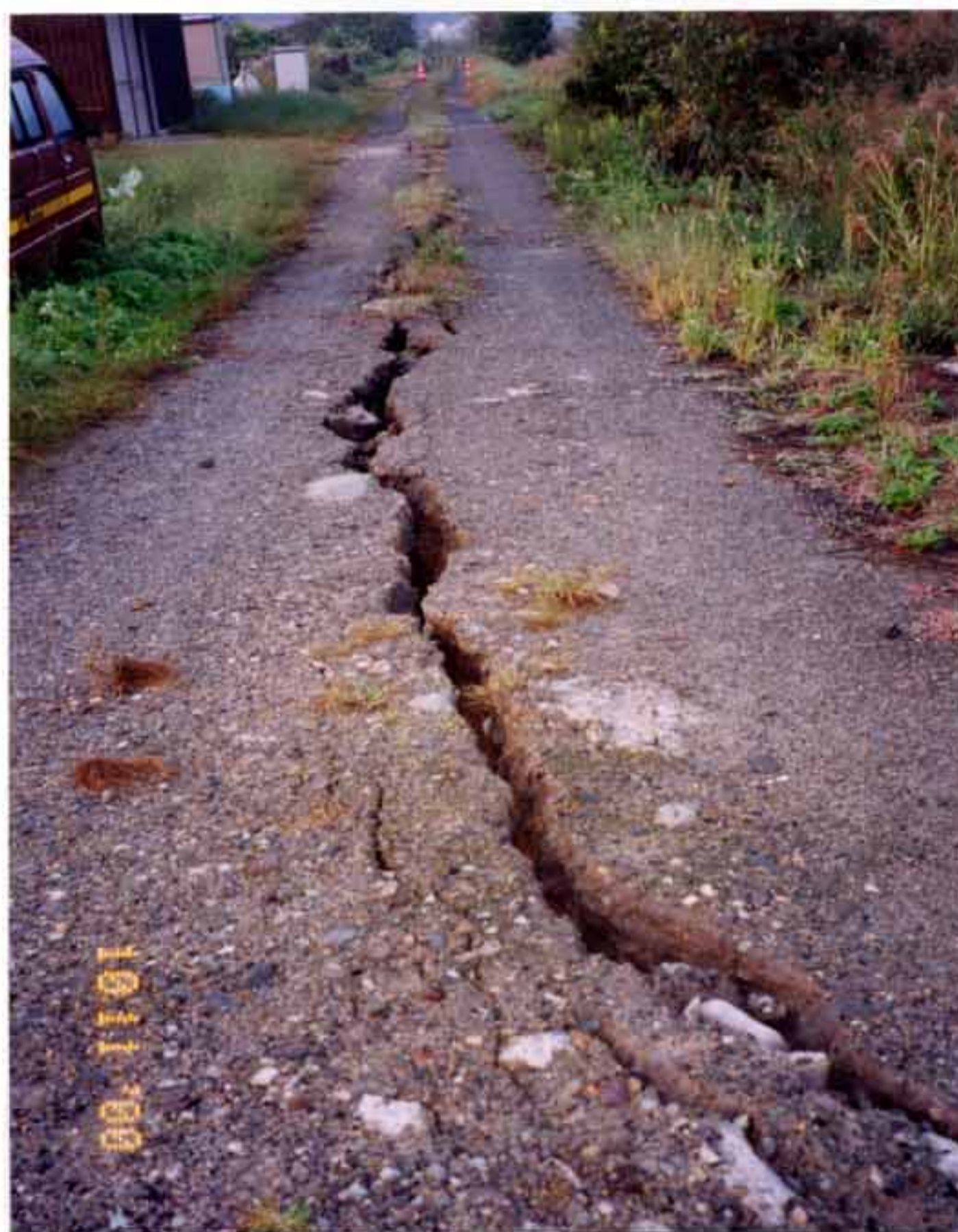
安来市門生町 河川堤防地割れ現象
