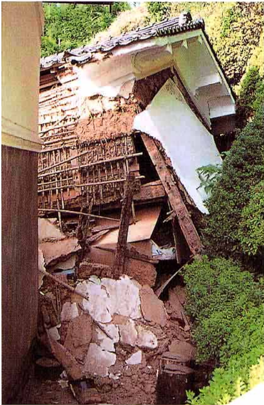
▲倒壊した土蔵（平成12年10月14日撮影）
