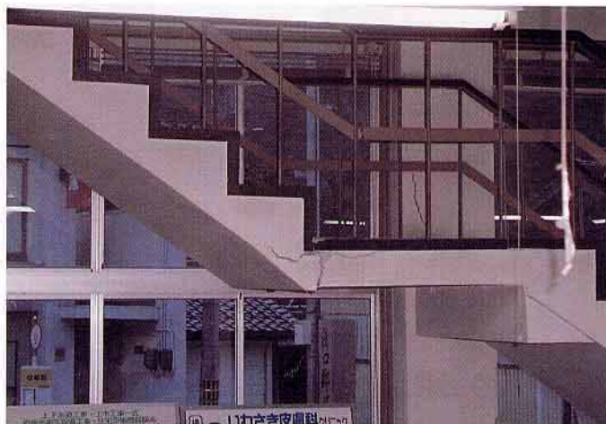
2階への階段も 大きな亀裂ができる ▶
