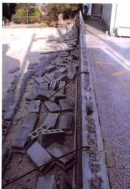
◀ブロック塀もズタズタに壊れた (溝口町溝口地内)
