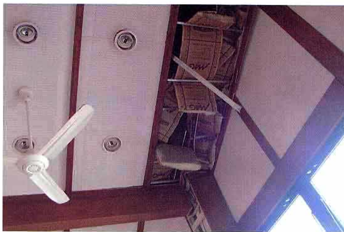
◀天井が落ちた武道館
