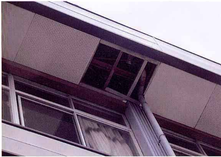
◀天井が落ち、 鉄骨が見えている公民館
