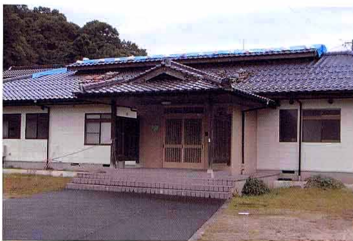
▶ 屋根瓦が脱落して、 青いシートが掛けてある (中学校寄宿舎)
