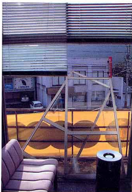
◀吹っ飛んだ窓 (役場庁舎2階踊り場)
